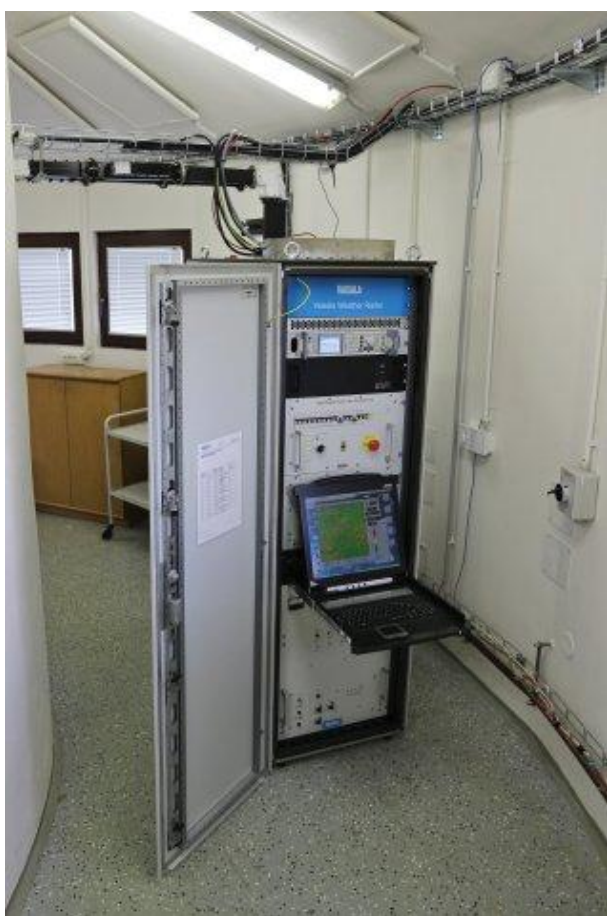
Radarová skříň nového radaru Vaisala WRM-200 obsahující vysílač, přijímač i počítač pro řízení radaru a zpracování dat (radar Skalky)
