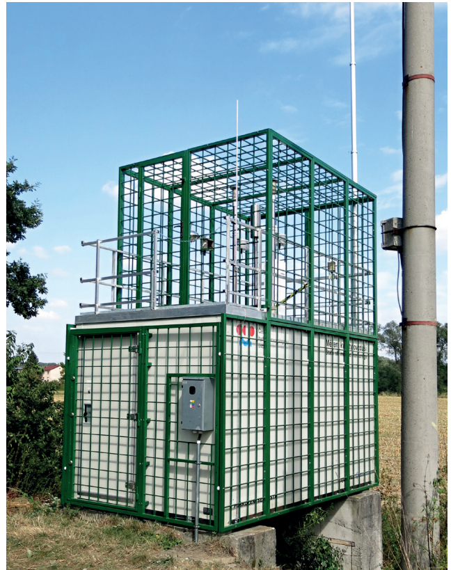
Obr. 44 AIM Věřňovice po výměně kontejneru v roce 2015 (P. Smolík).
