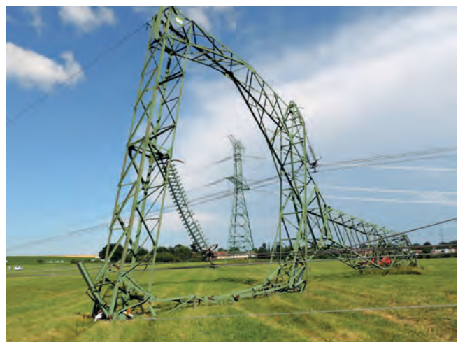
Obr. 5 Jeden ze zlomených stožárů elektrického vedení 400 kV vyvádějícího výkon jednoho z temelínských jaderných bloků. Zdroj: ČEPS.
