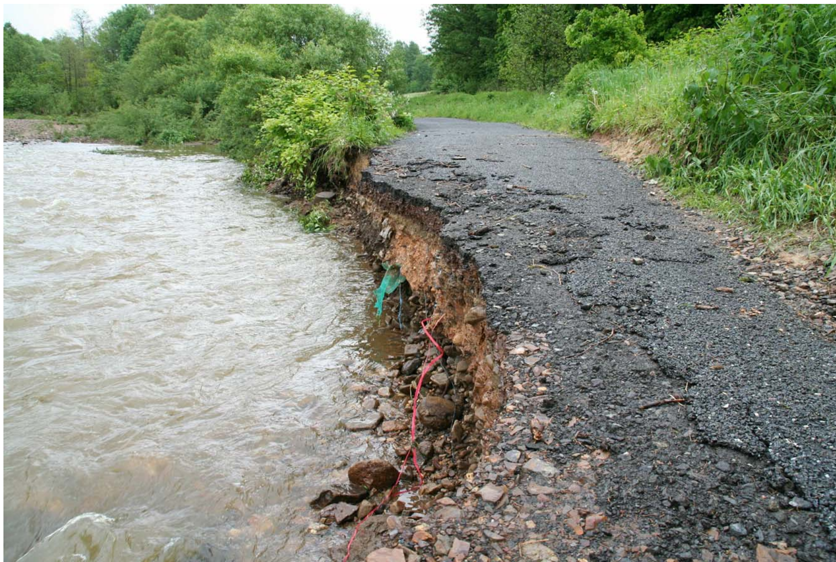
Následky povodně nad LGS Hrádek v povodí Klabavy (1. 6. 2006)
