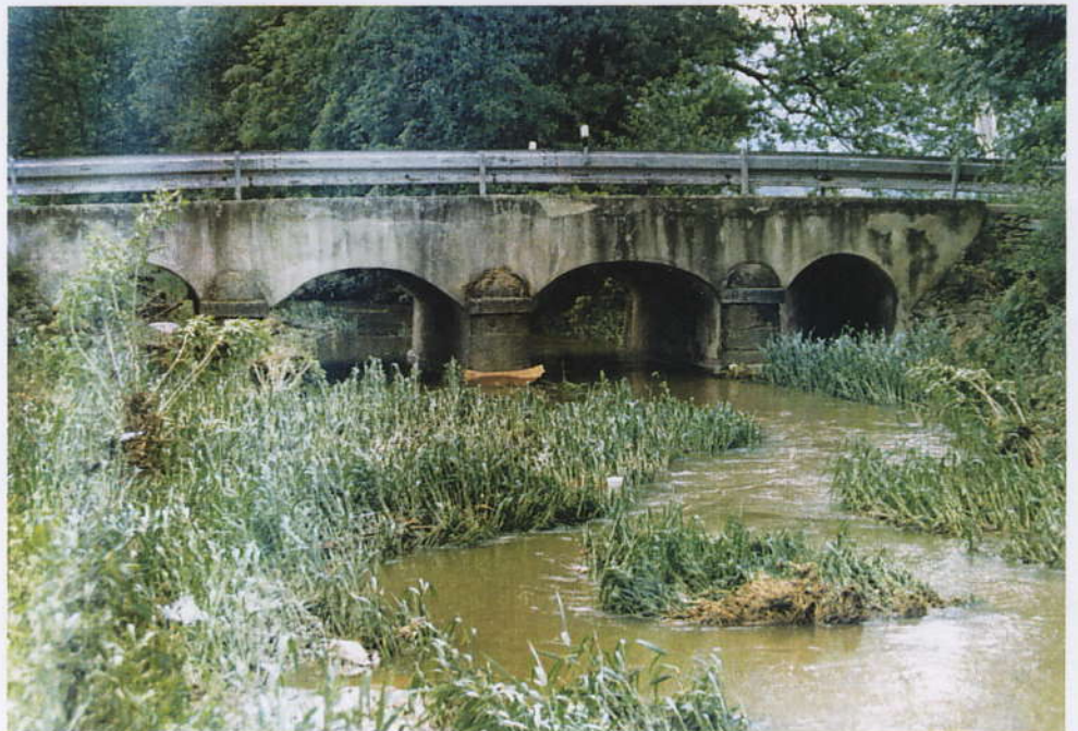
Most přes Bílský potok v obci Svinětica, za kulminace zahlcen bez výraznějších stop přetékání
