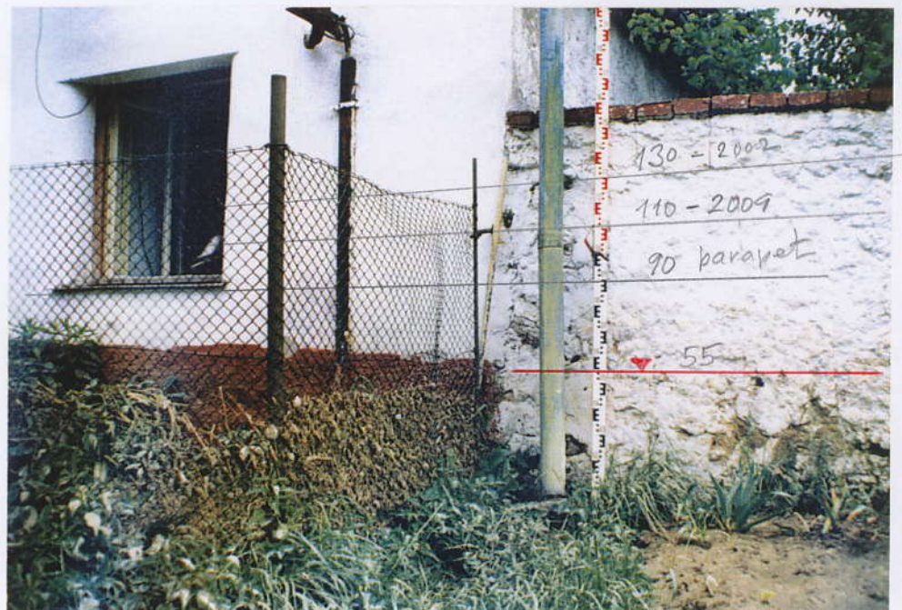
Kulminační výška hladiny u domku v sousedství mostu ve Sviněticích (54 cm na nivelační latí)
