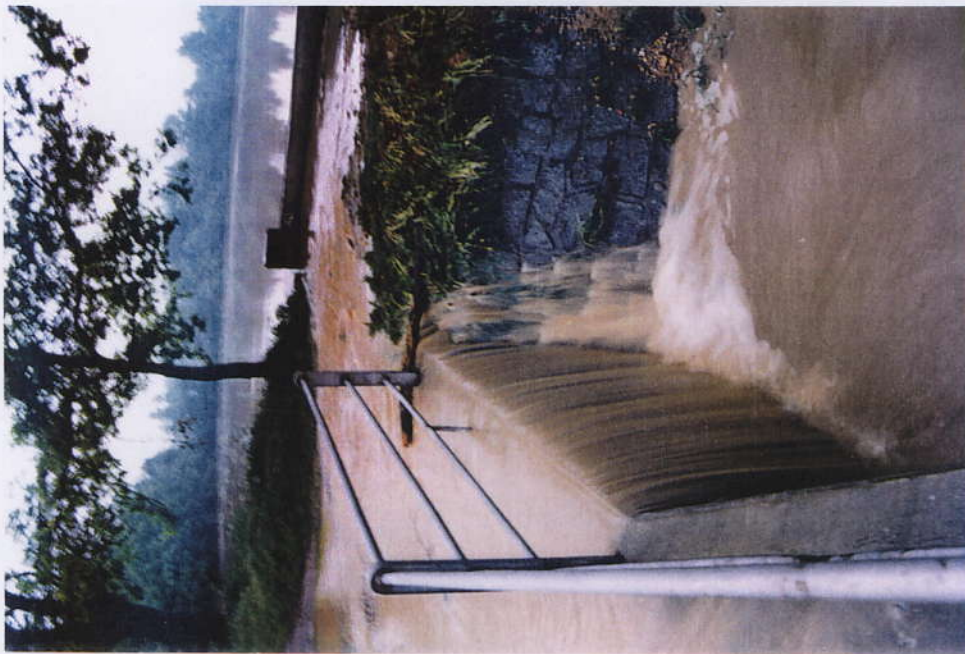
Přetékání hráze Hliněného rybníka
