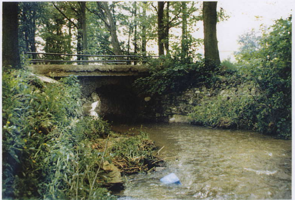
Mostek přes Bílský potok v obci Bílsko, za kulminace zahlcen a přetékán přepadovým paprskem o max. výšce cca 50 cm
