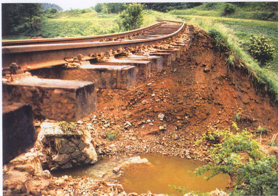
Zničený železniční most u Malenic
