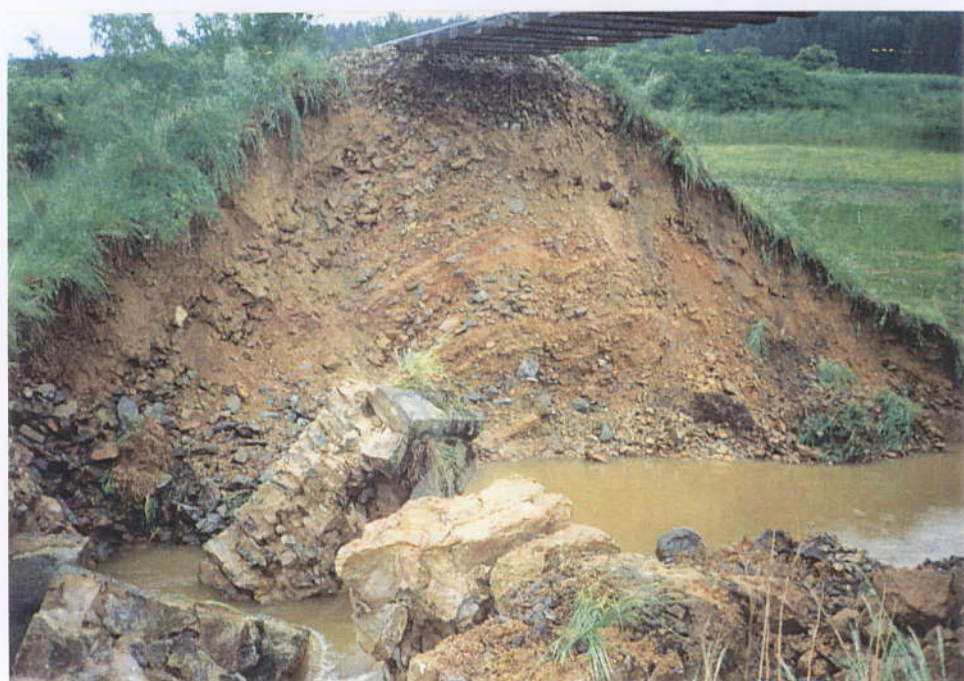
Zničený železniční most u Malenic
