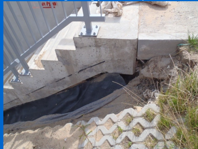
Detail poškození v napojení konstrukcí
