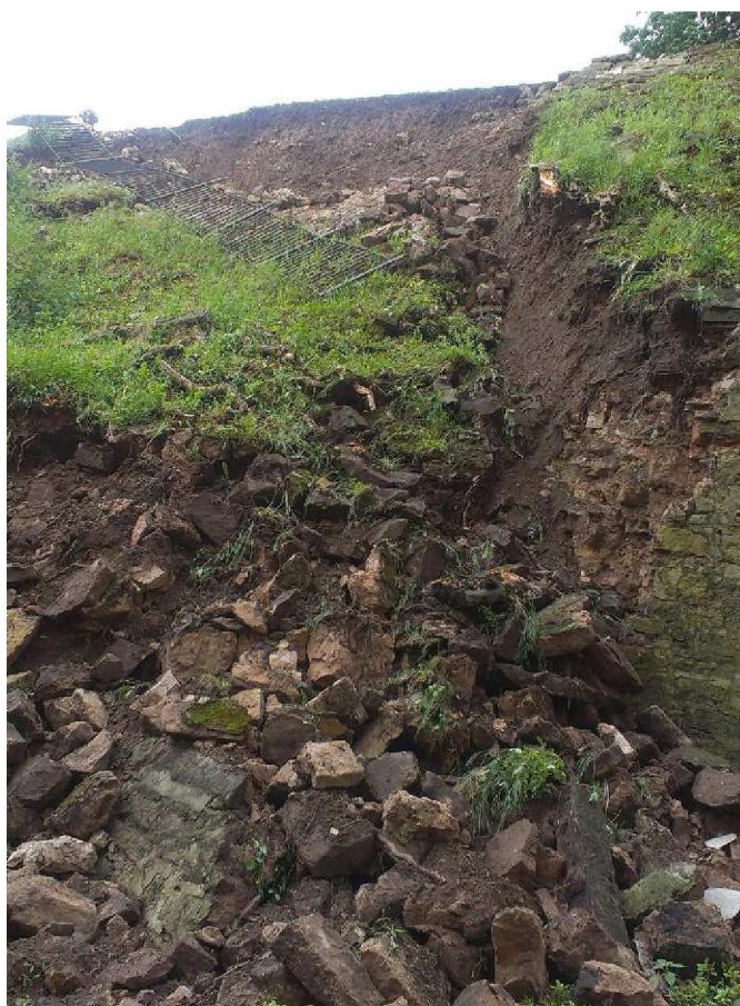
Foto 280: Sesuv zdi a svahu před provizorními sanačními pracemi
