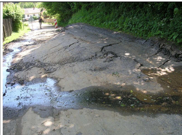
Foto 229: Pohled na zvlněný povrch komunikace.
