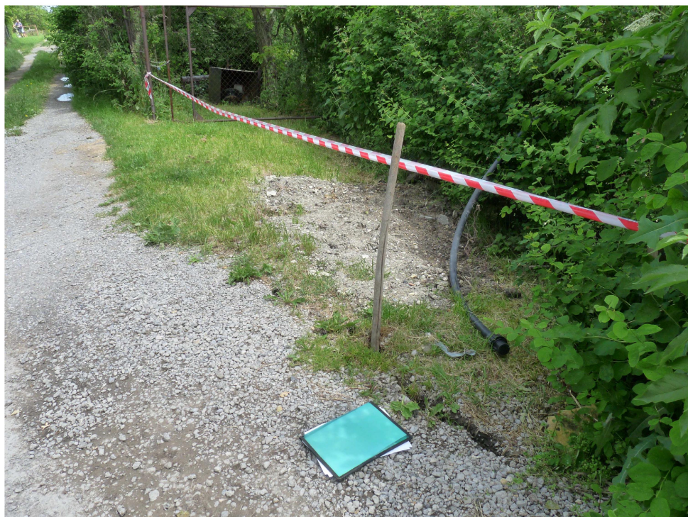
Foto 218: Praskliny v místní komunikaci nad odebranou patou svahu
