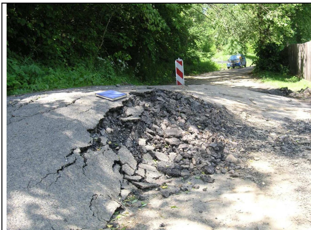
Foto 228: Silnice, poškozená svahovou deformací.
