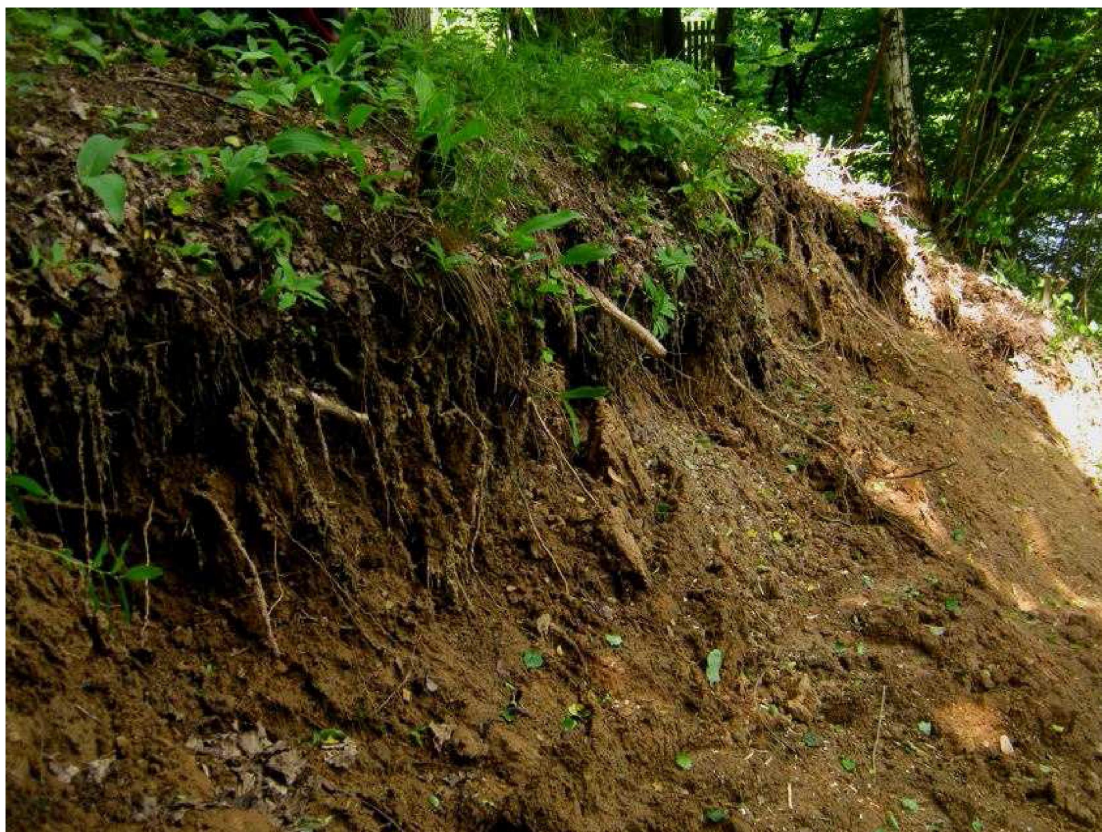
Foto 226: Odlučná stěna proudového sesuvu
