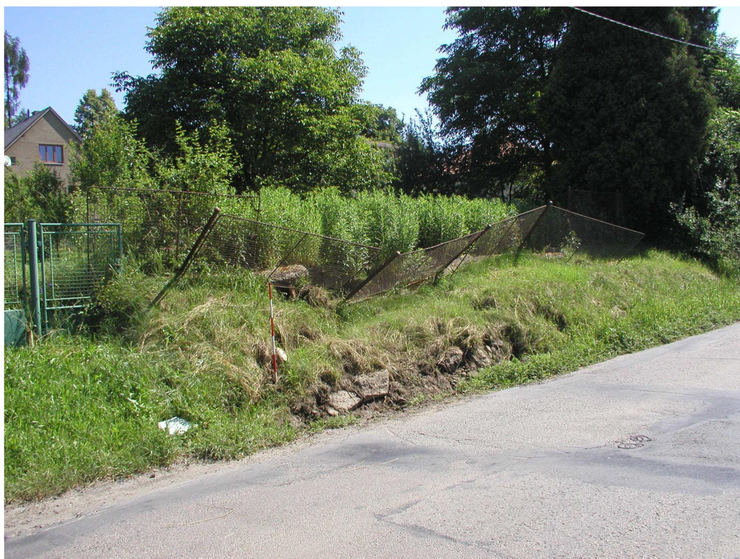
Foto 247: Svahová deformace A – pohled od SZ
