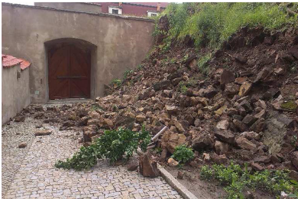
Foto 279: Akumulace zřícené zdi na cestu k zámku
