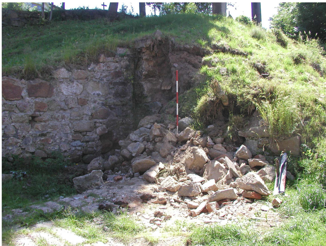
Foto 250: Svahová deformace, pohled od S
