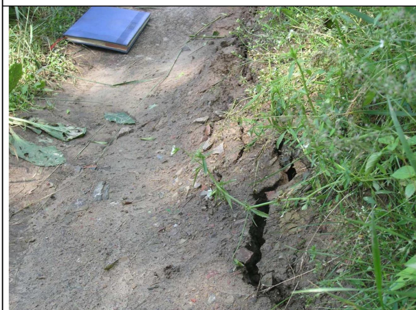
Foto 236: Trhlina ve stezce, způsobená svahovou deformací.
