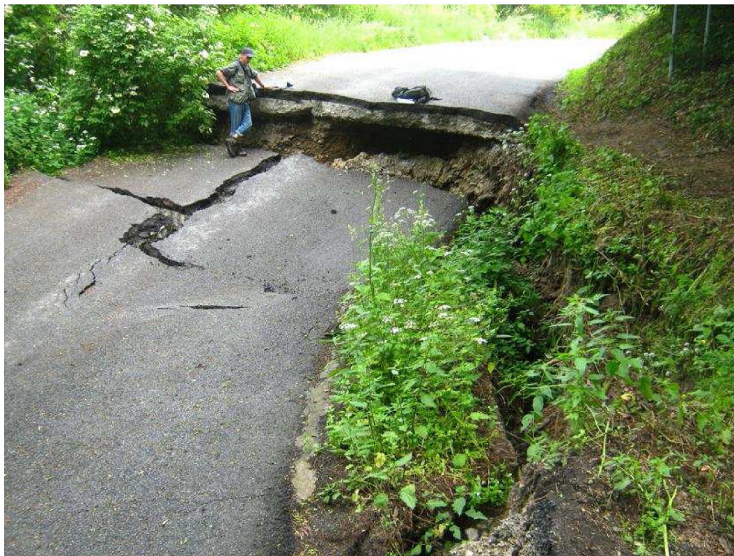
Foto 277: Celkový pohled sesednutou část komunikace III/11620 při západním okraji obce Mořina
