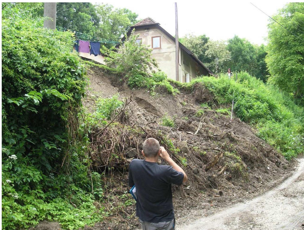
Foto 223 : Sesunutý svah při obecní cestě, u RD čp. 244
