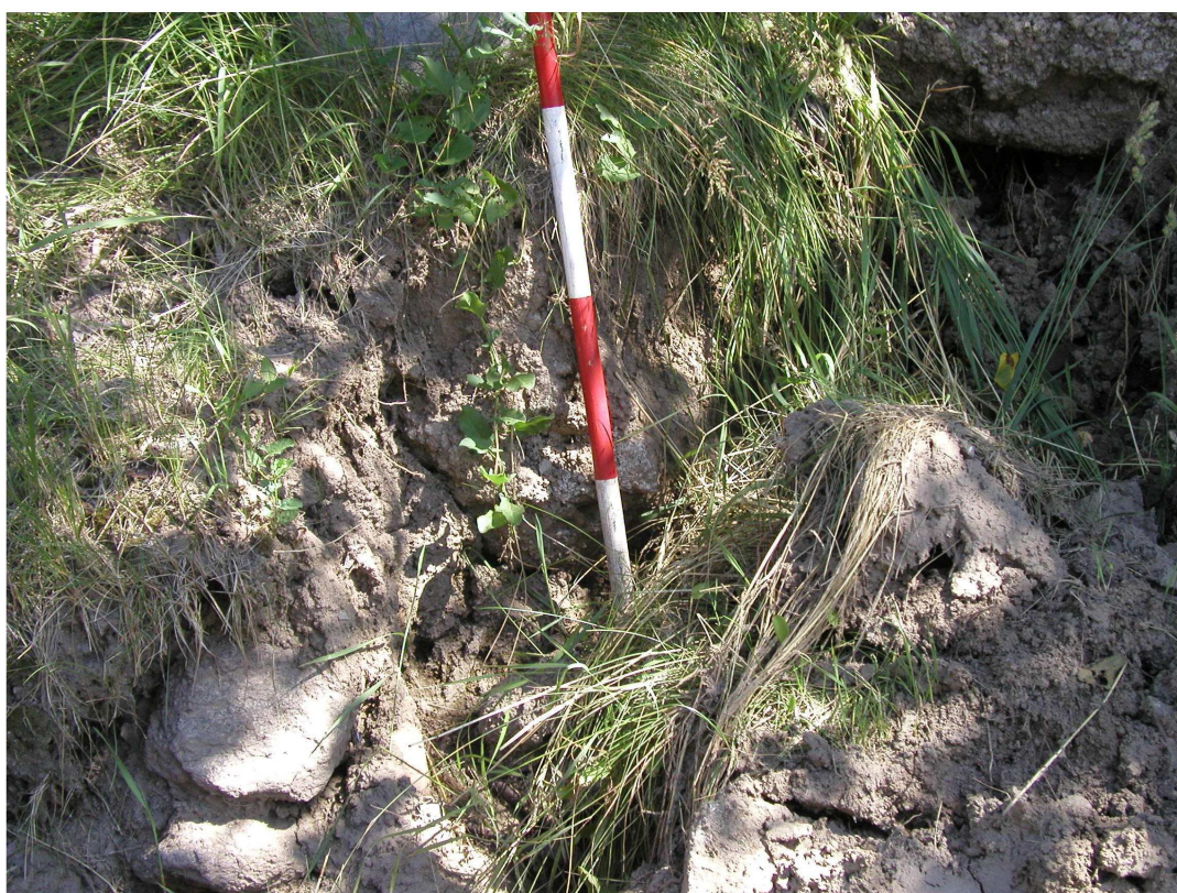
Foto 249: Svahová deformace - obnažená patka sloupu el. Vedení
