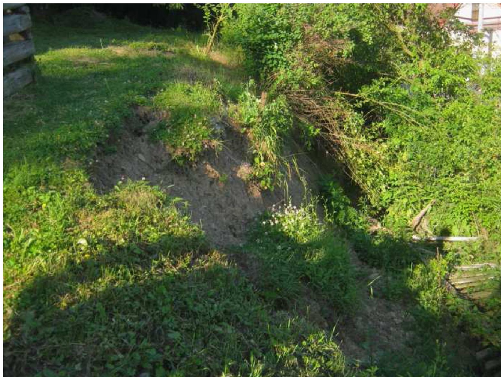
Foto 258: Odlučná část sesuvu, zasahující na zahradu pozemku p.p.č.252/3 s poškozeným plotem
