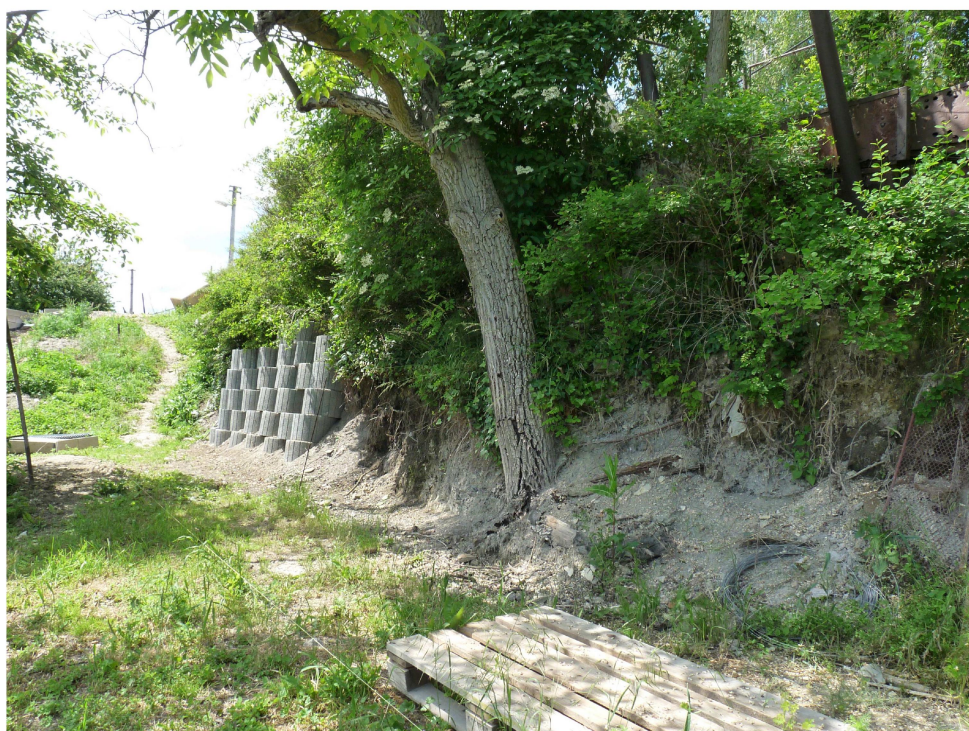
Foto 219: Celkový pohled na lokalitu. V popředí svah s odebranou patou, částečně zpevněný betonovými skružemi. V pozadí částečně sesuté těleso nové přístupové cesty rozšiřující místní zpevněnou komunikaci probíhající paralelně se svahem
