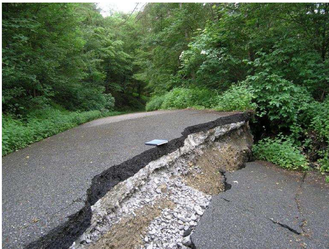
Foto 278: Trhlina při západním okraji deformace vzniklá subsidencí silničního tělesa
