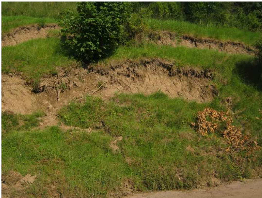
Foto 260: Celkový pohled na sesuv v obci Chodouň
