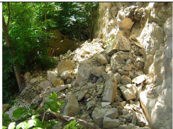
Foto 273: Spadlé bloky pískovců na pozemku za domem č.p. 203.
