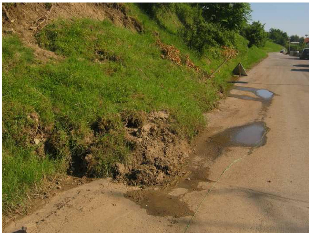
Foto 261: Akumulační část sesuvu částečně zasahující na okraj místní komunikace
