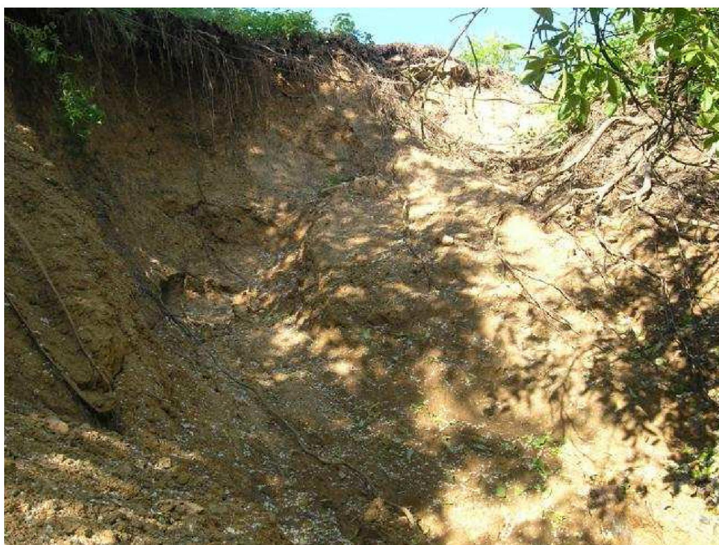
Foto 257: Detailní pohled na odlučnou plochu svahové deformace
