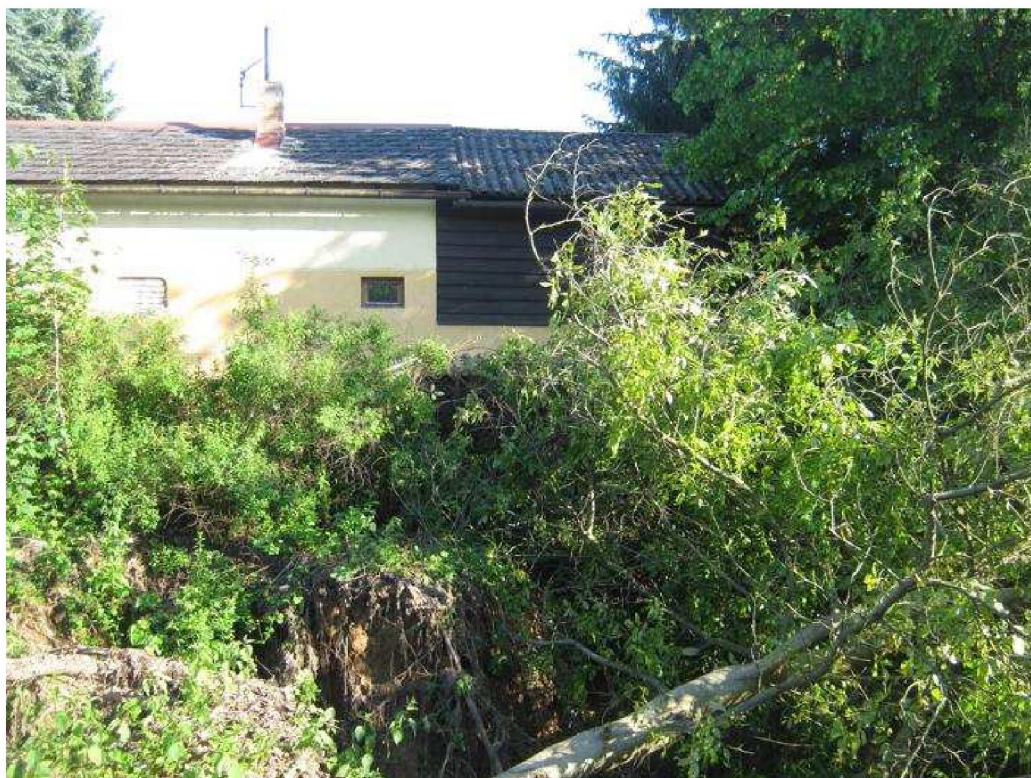
Foto 256: Odlučná hrana sesuvu s vyvrácenými stromy. V pozadí ohrožený dům č. p. 625
