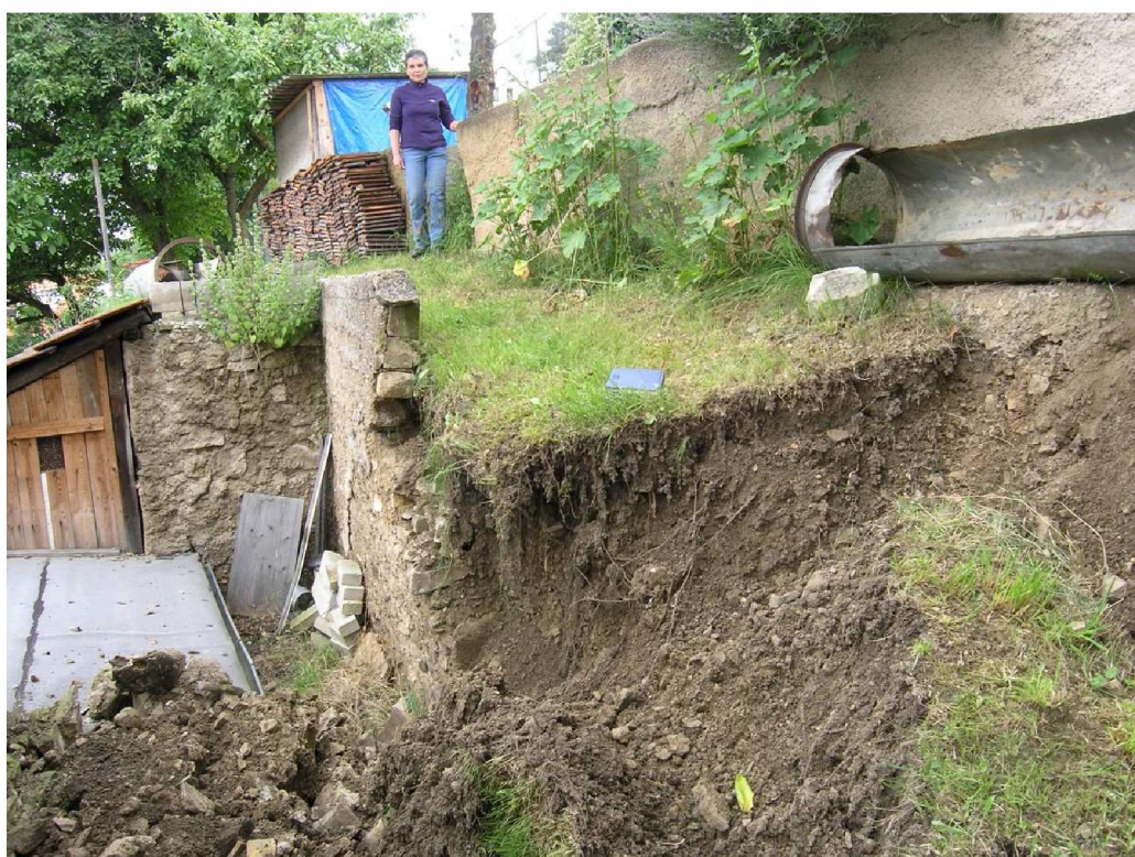
Foto 263: Spadlá opěrná zeď a zemité hmoty sesuté na střechu přístavku
