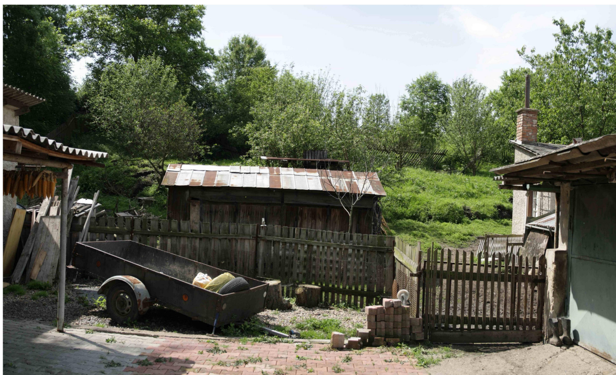
Foto 146: Pohled k jihu z nádvoří domu č.p. 28. Podle sdělení vlastníka nemovitosti paní Filipové na tomto místě došlo ke svahovému pohybu již před asi 45 lety. Tehdy byly sesuté hmoty transportovány až na tento dvorek
