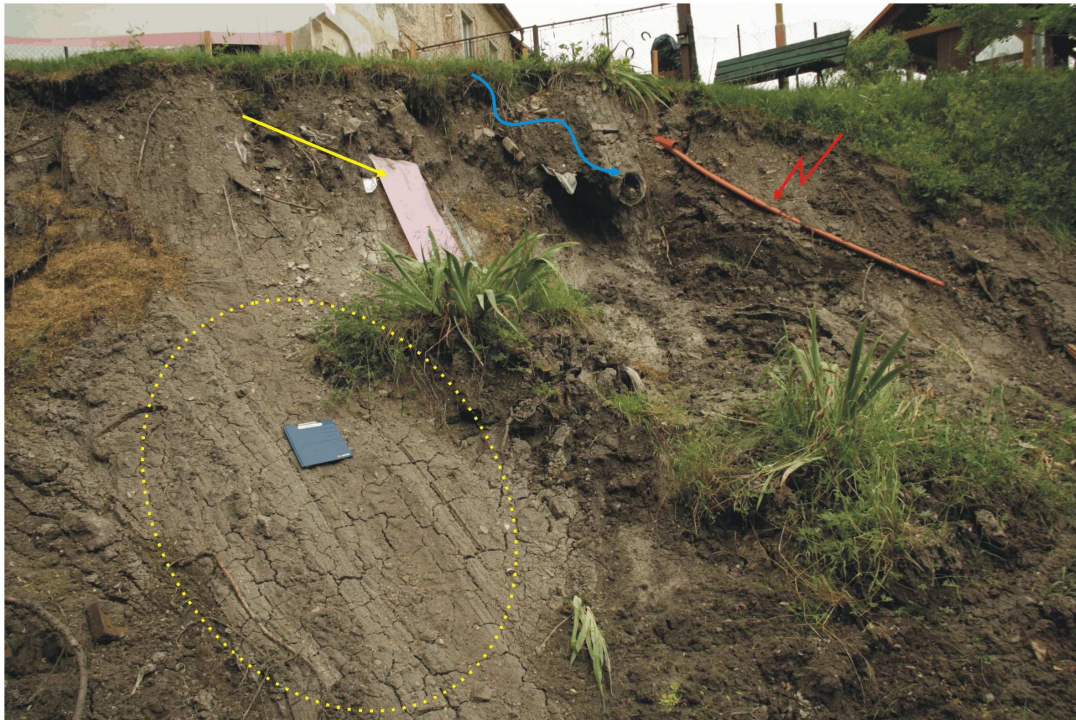
Foto 180: Odlučná stěna svahové deformace s obnaženým nepoužívaným kameninovým potrubím (modrá šipka), kabelem elektrického vedení (červená šipka ve tvaru blesku) a červený igelit s hliníkovým plátem nejasného původu (žlutá šipka). Žlutá elipsa zvýrazňuje část rovinné smykové plochy s rýhováním
