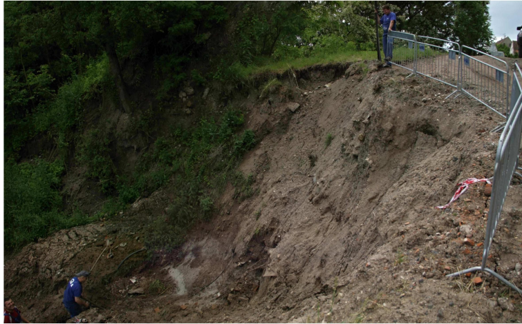
Foto 175: Odlučná stěna (5–7 m) většího tělesa proudového sesuvu v Registru sesuvů ČGS evidovaný pod č. 5785
