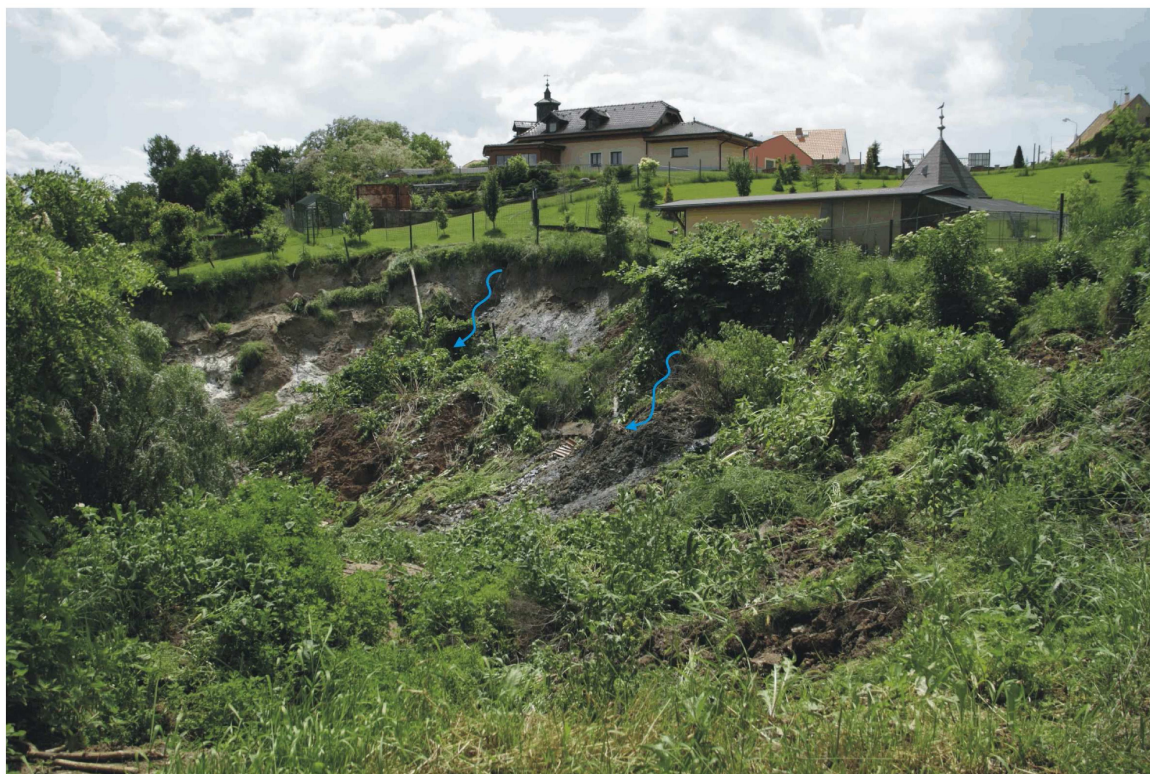
Foto 173: Odlučná stěna proudového sesuvu pod hospodářskou budovou (holubník). Modré křivky naznačují přítoky vody. Vlevo se jedná o potrubí dešťové kanalizace. Vpravo pramenný vývěr zavezené studánky
