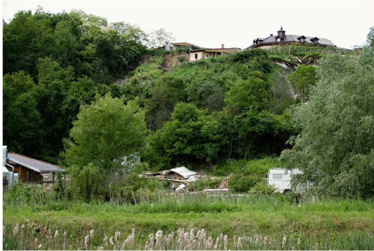
Foto 170: Pohled k západu na sesutý svah. V pozadí dům č.p. 125, který se nachází v nejbližším místě asi 30 m od odlučné hrany.
