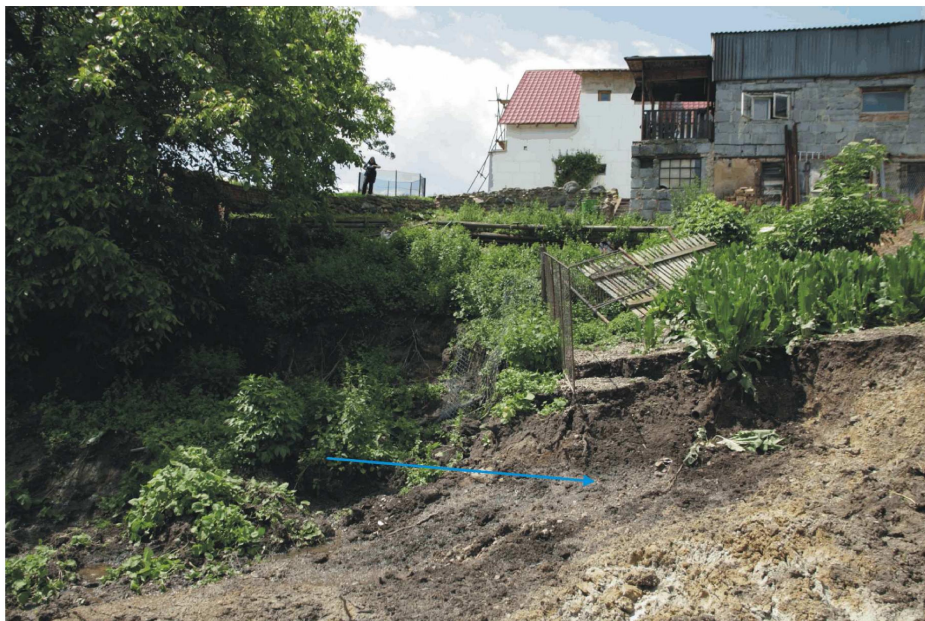
Foto 153. Modrá šipka ukazuje na vývěr podzemní vody v odlučné oblasti do tělesa svahové deformace. V pozadí bílá budova č.p. 1563. V popředí hospodářská budova a další hospodářská budova na ni navazuje přibližně kolmo
