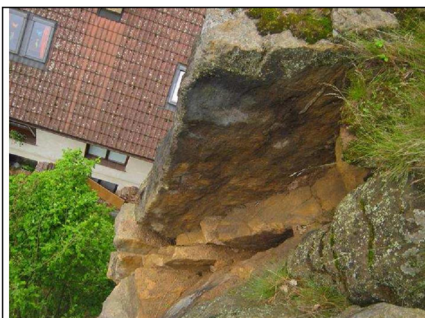
Foto 187: Detailní pohled na místo uvolnění horninového bloku
