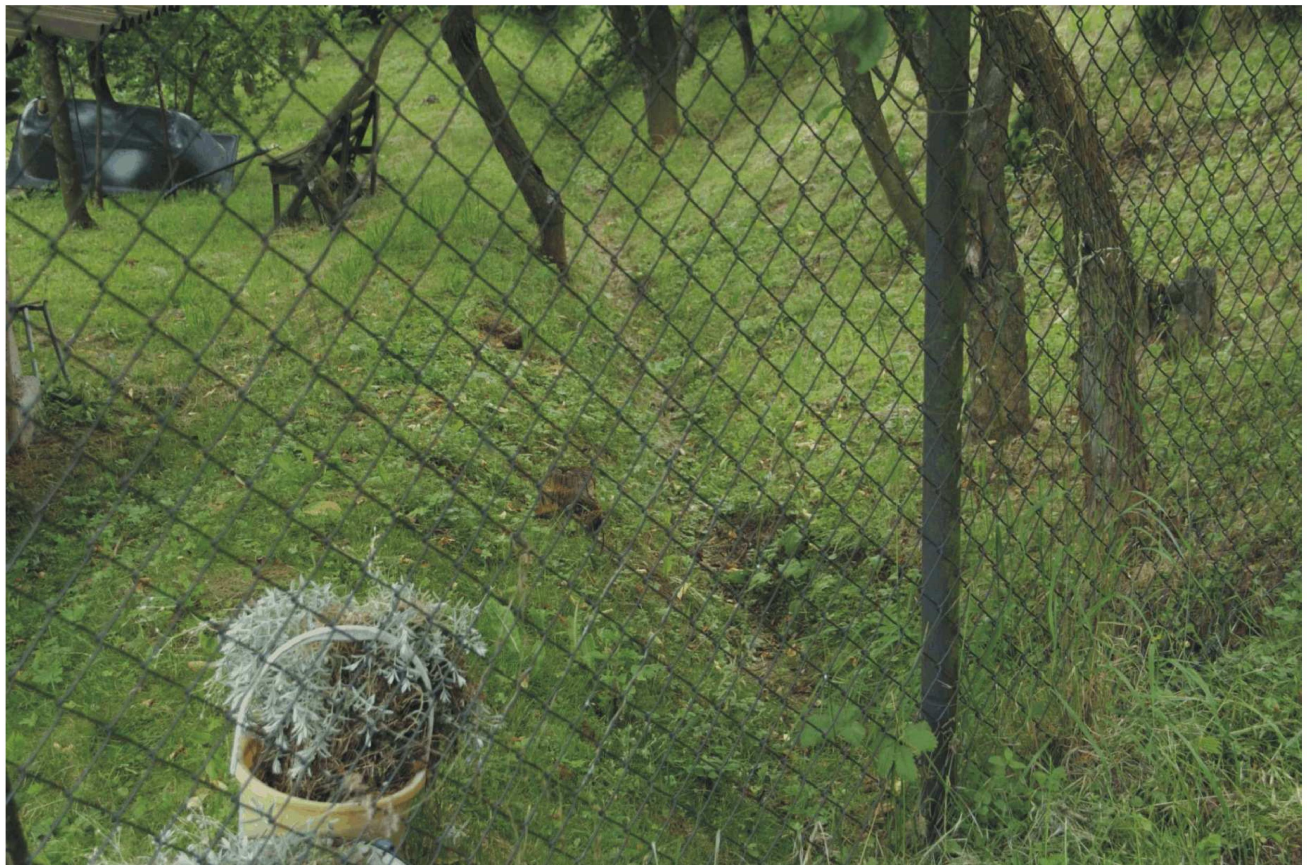
Foto 190: Nefunkční odvodňovací příkop pod polní cestou (viz. foto 1. Dno příkopu nenese znaky proudění vody svedeného povrchového odtoku
