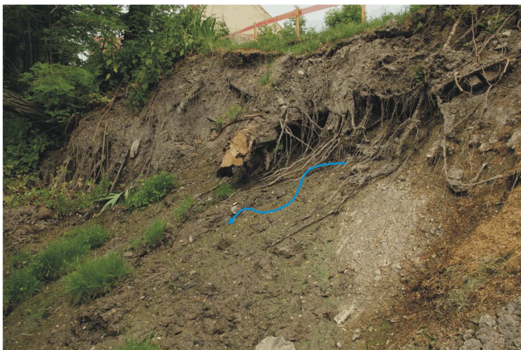
Foto 183: Nalevo od obnaženého kabelu el. vedení a roury dochází na litologickém rozhraní předkvartérních jíílů a kvarterního pokryvu k nesoustředěnému vývěru podzemní vody. Sesutá zemina v tomto místě má měkkou konzistenci
