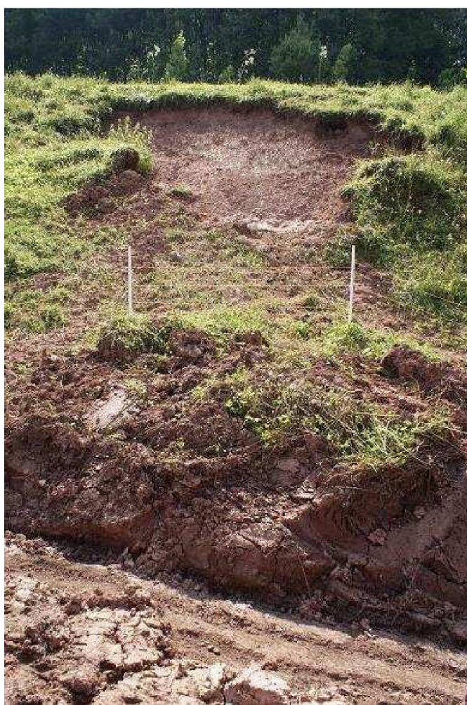
Foto 53: Čelní pohled na sesuv
