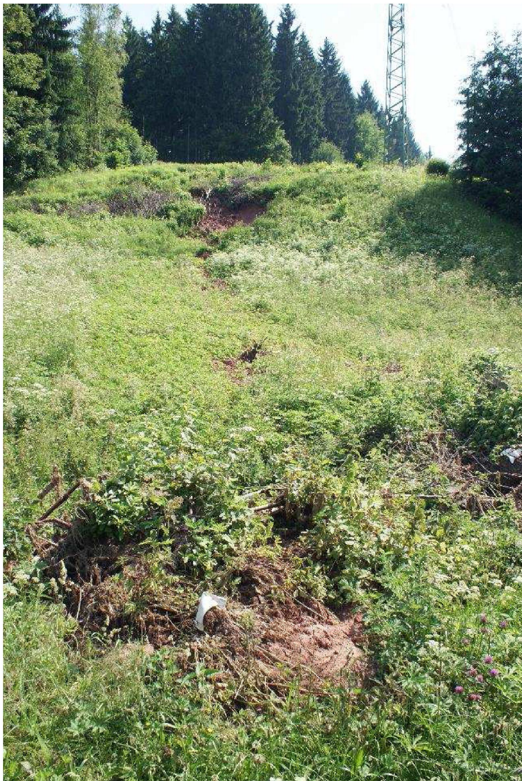
Foto 124: Čelní pohled na sesuv
