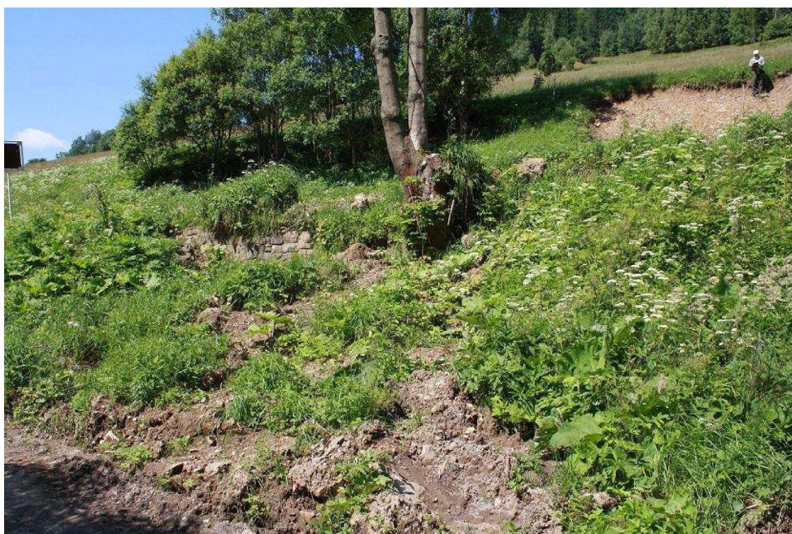
Foto 107: Sesuv – celkový pohled (z místa pod silnicí do Lysečín)
