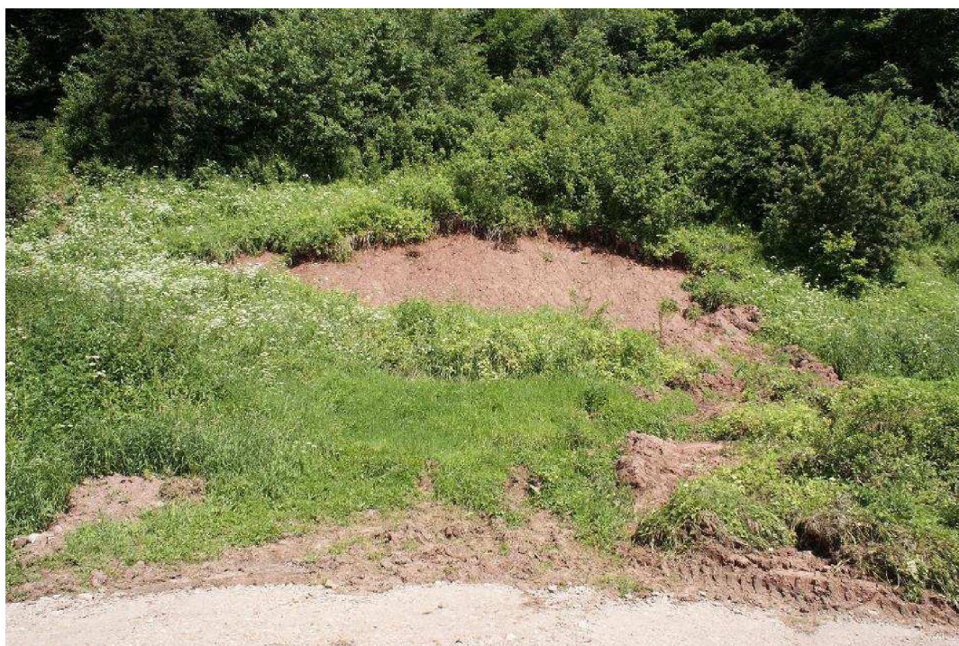
Foto 69: Čelní pohled na sesuv
