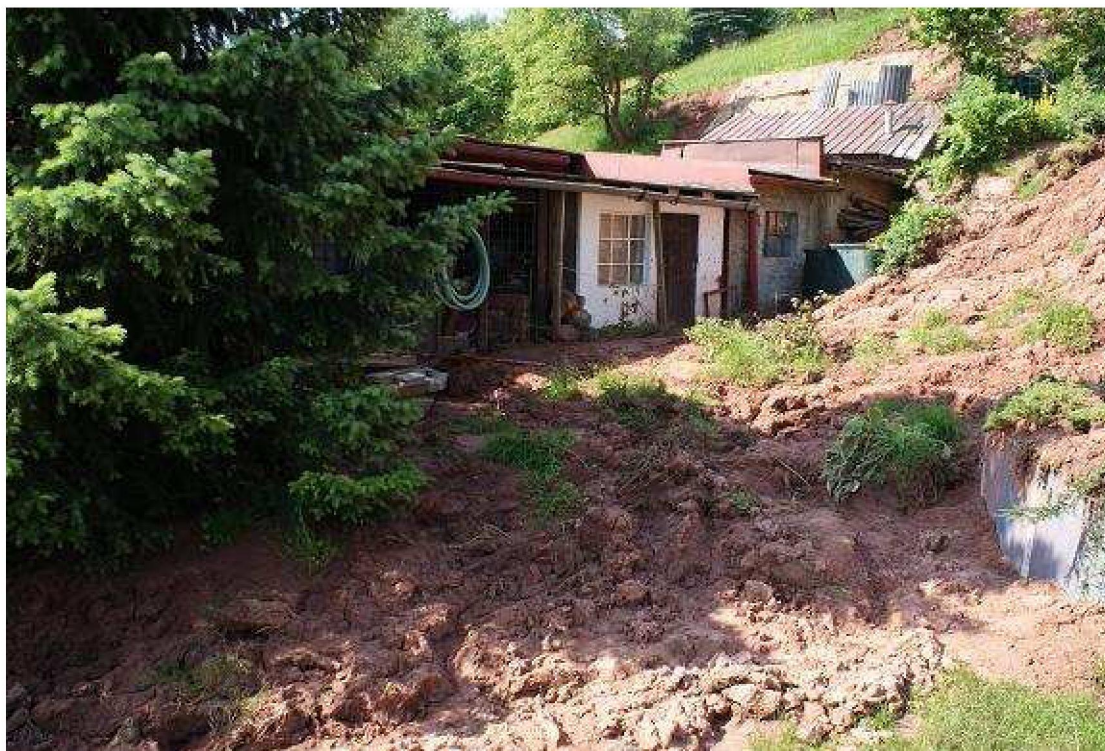
Foto 52: Akumulace pravé části sesuvu s ohroženými zděnými kůlnami.
