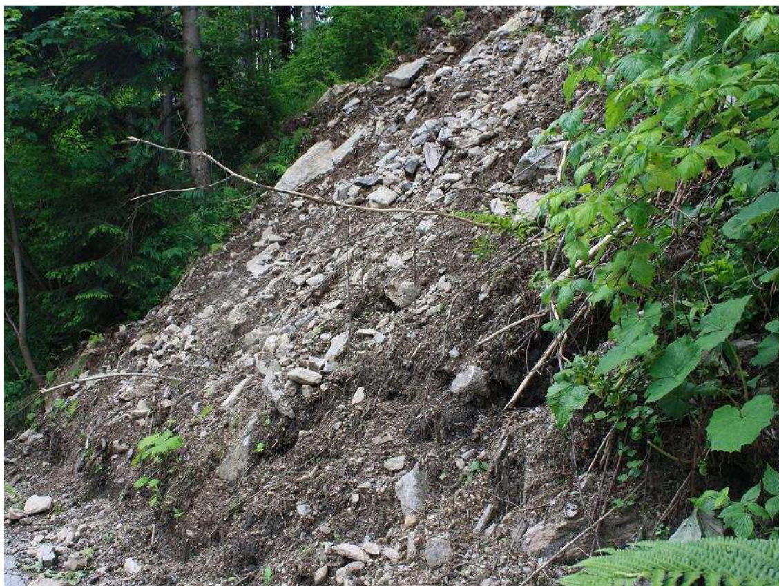
Foto 111: Boční pohled na čelo sesuvu (materiál odtěžen technikou)
