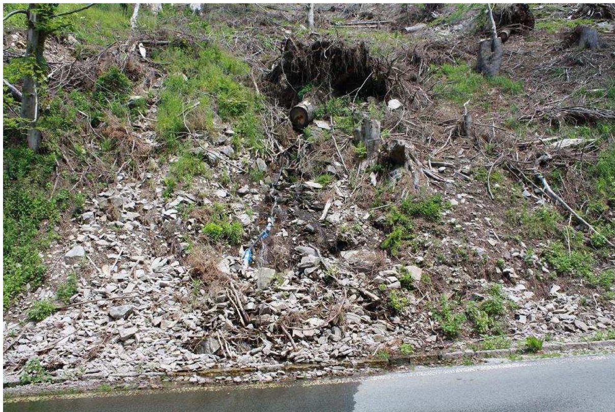
Foto 130: Celkový pohled na sesuv
