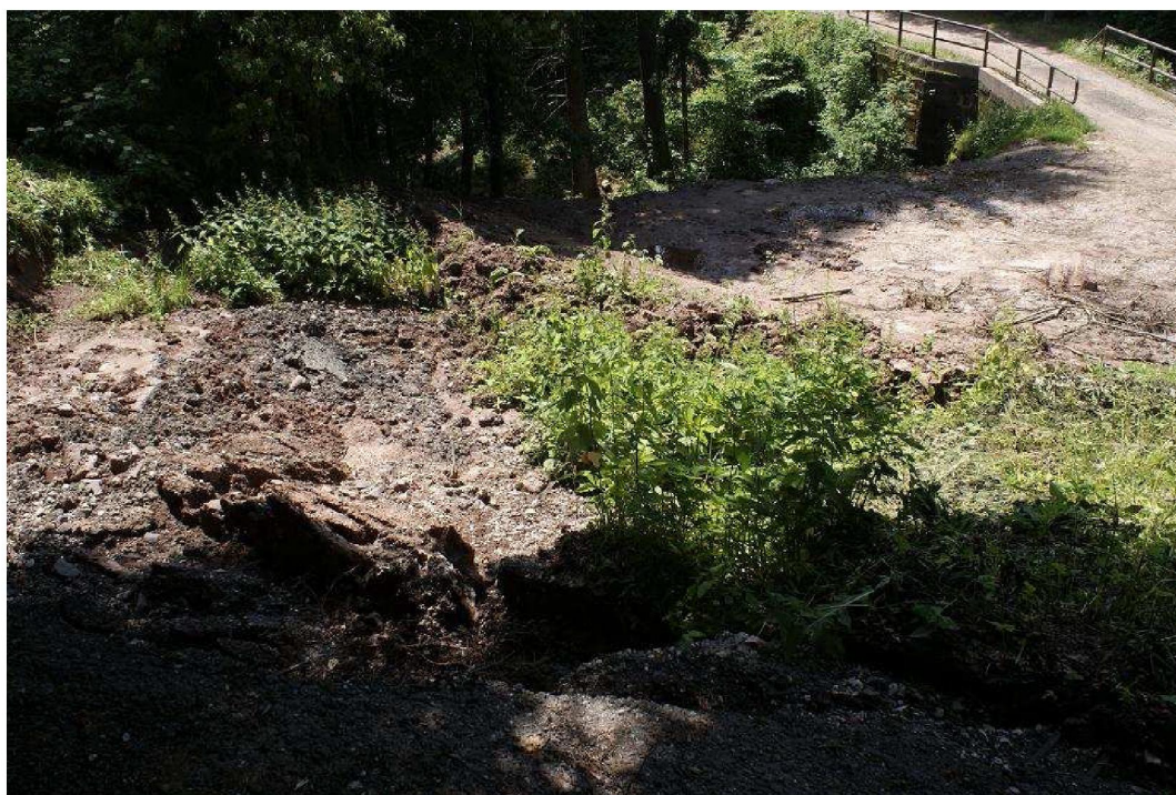
Foto 75: Transportní a akumulční oblast sesuvu (čelo sesuvu odtěženo technikou)
