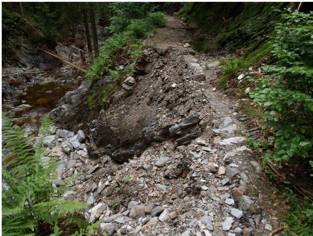
Foto 99: Sesutá část chodníku vlivem eroze potoka
