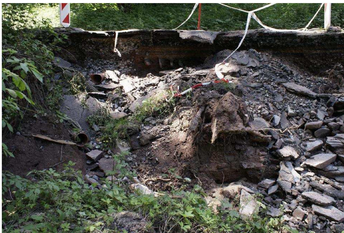
Foto 85: Odlučný prostor sesuvu s poškozenou komunikací
