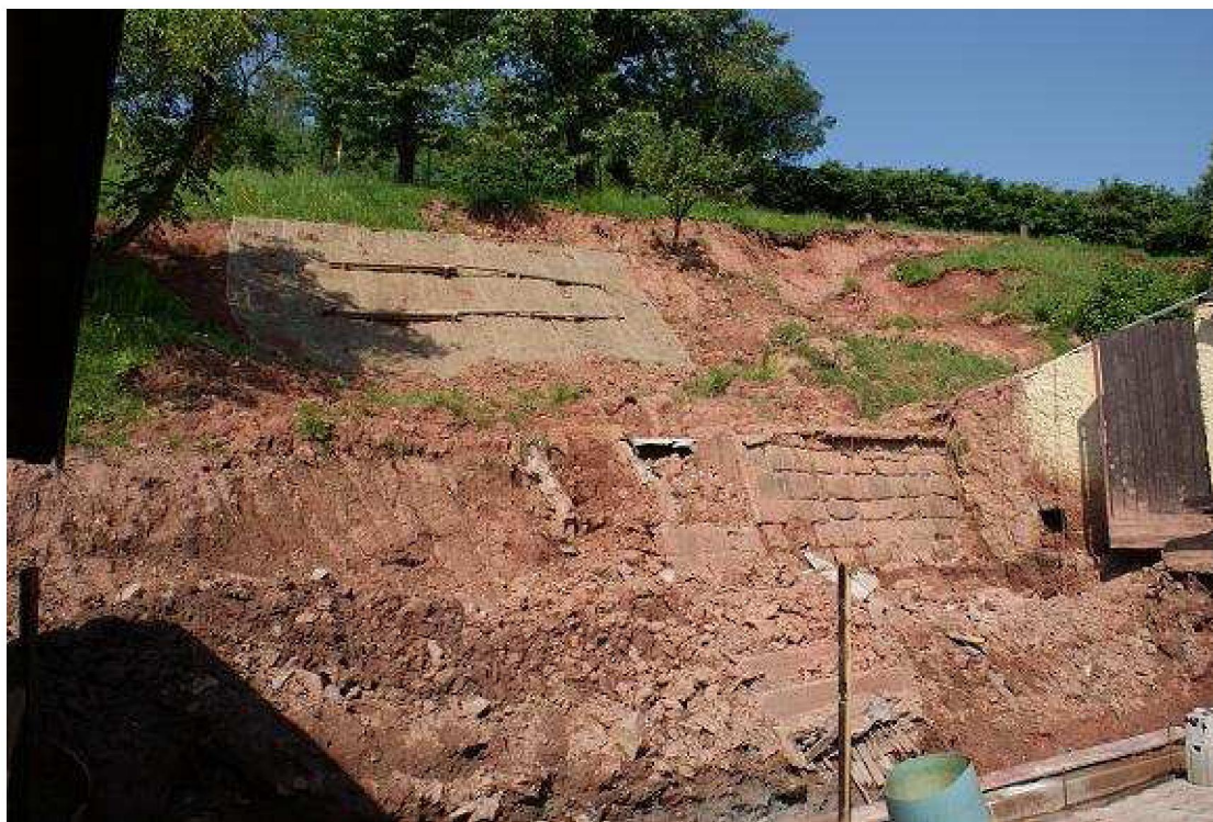
Foto 51: Čelní pohled na levou část sesuvu s odtěženou akumulací a započatými úpravami povrchu svahu
