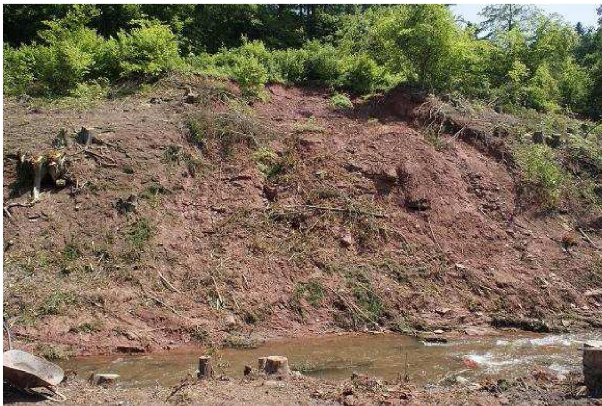
Foto 46: Čelní pohled na sesuv
