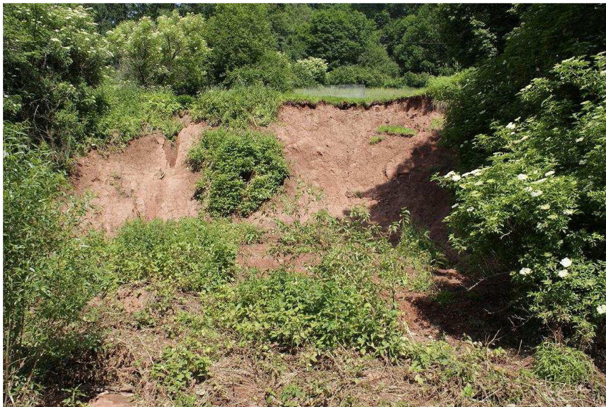
Foto 66: Čelní pohled na sesuv
