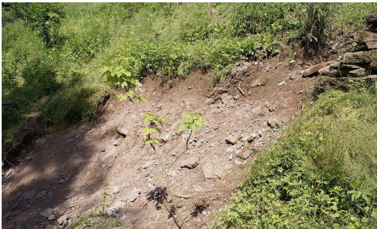
Foto 82: Odlučný prostor sesuvu s poškozenou zídkou
