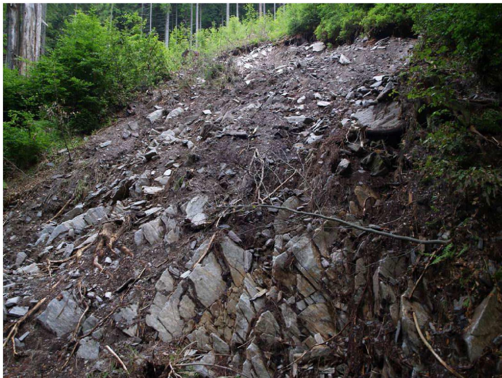
Foto 97: Odkrytý povrch svahovou deformací s výchozy rul. Mocnost jevu je do 0,5 m
