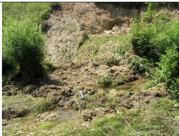
Foto 59: Akumulované sesuté hmoty při patě sesuvu C – v okolí koryta vodoteče.
