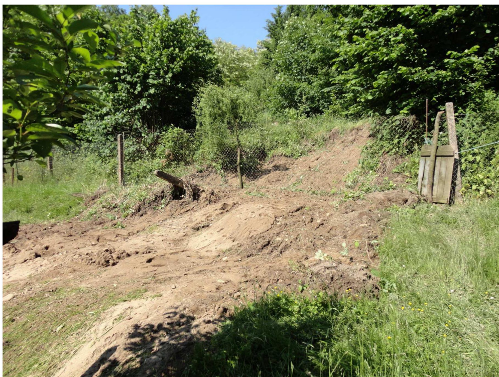
Foto 4: dílčí sesuv č. 1c, poškození oplocení mezi p.č. 864 a 862, celková situace
