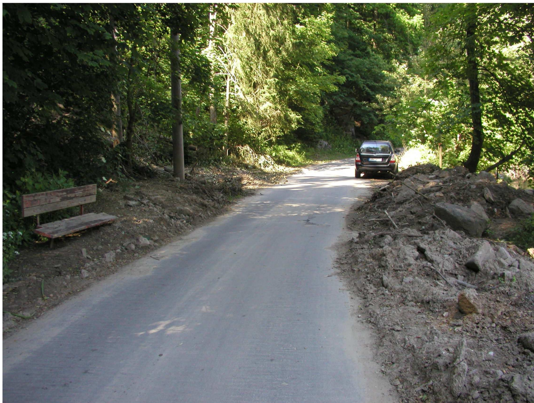
Foto 11: Sesuv postihl i místní komunikaci, kde byl materiál už odklizen a silnice zprůjezdněna. Vlevo je patrné poškození lavičky pro turisty
