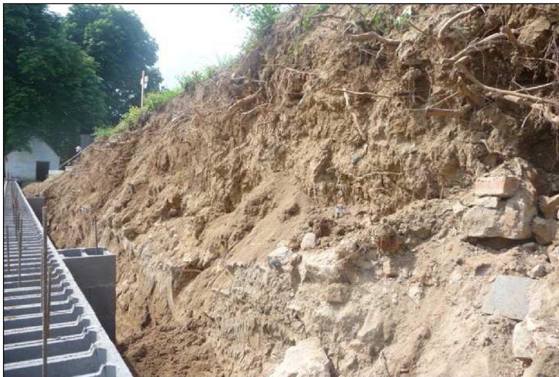
Foto 31: Materiál sesuvu se zbytky obvodové zdi
