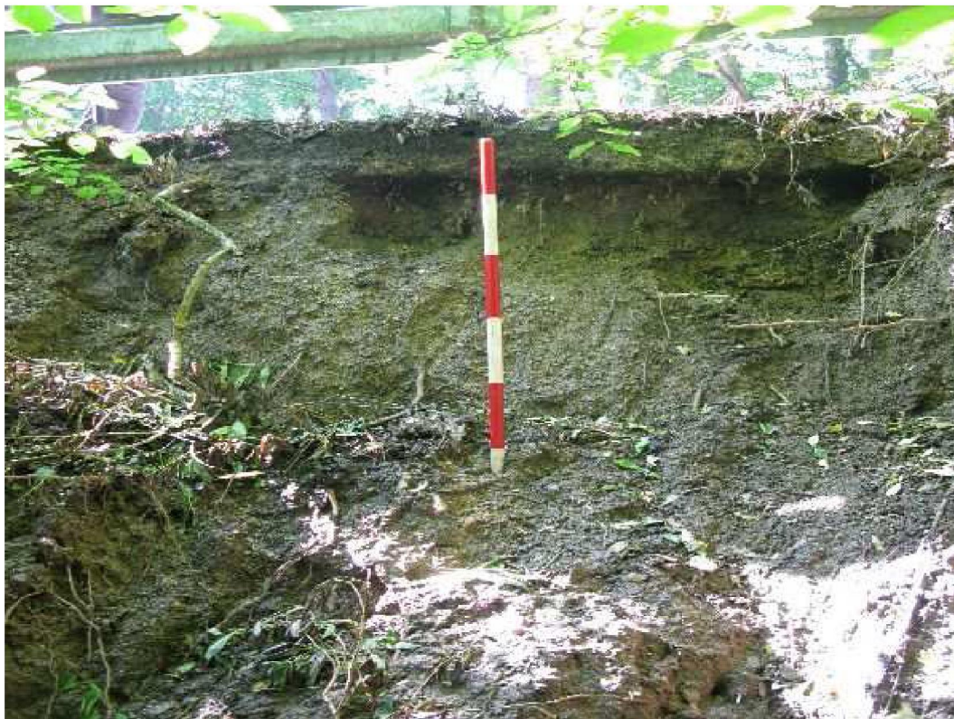
Foto 7: detail propadliny násypu komunikace III/10564, patrné obnažení silničního tělesa
