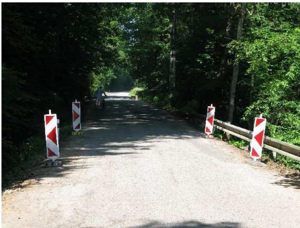
Foto 6: komunikace III/10564, celková situace, vlevo trativod, vpravo svodidla nad vysokým násypem
