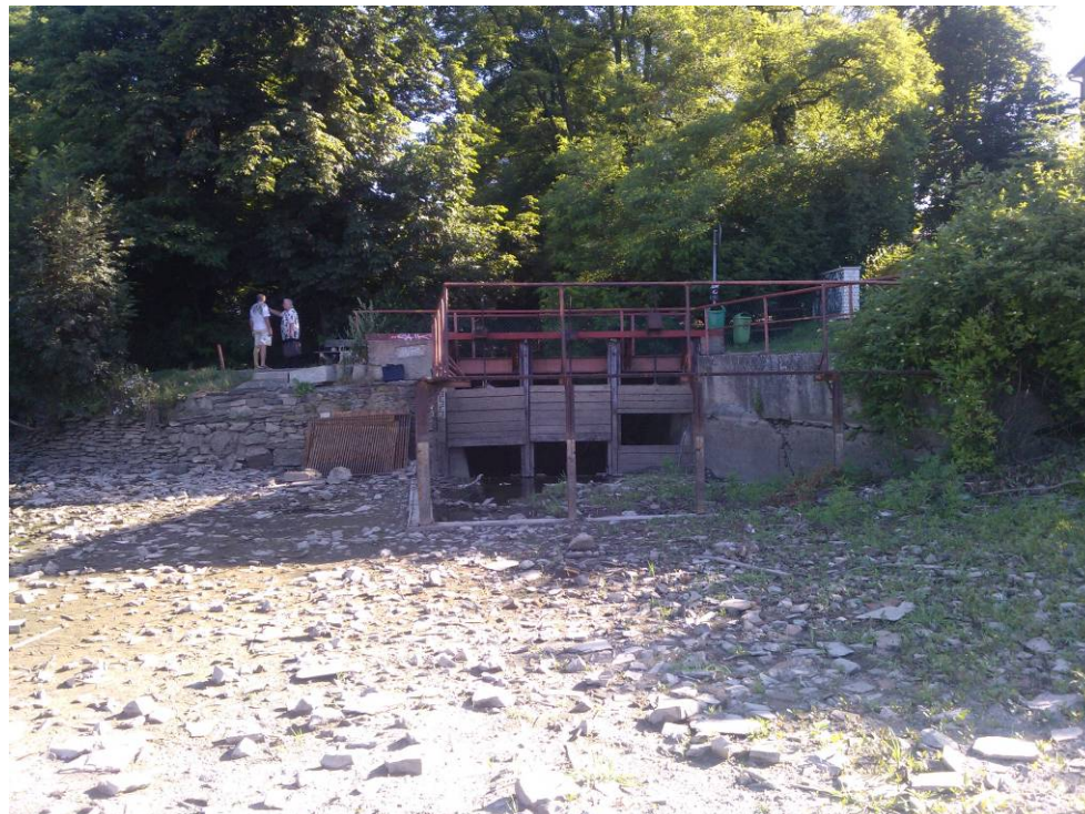
Mlýnský rybník - poškozený bezpečnostní přeliv, po vypuštění rybníka.
