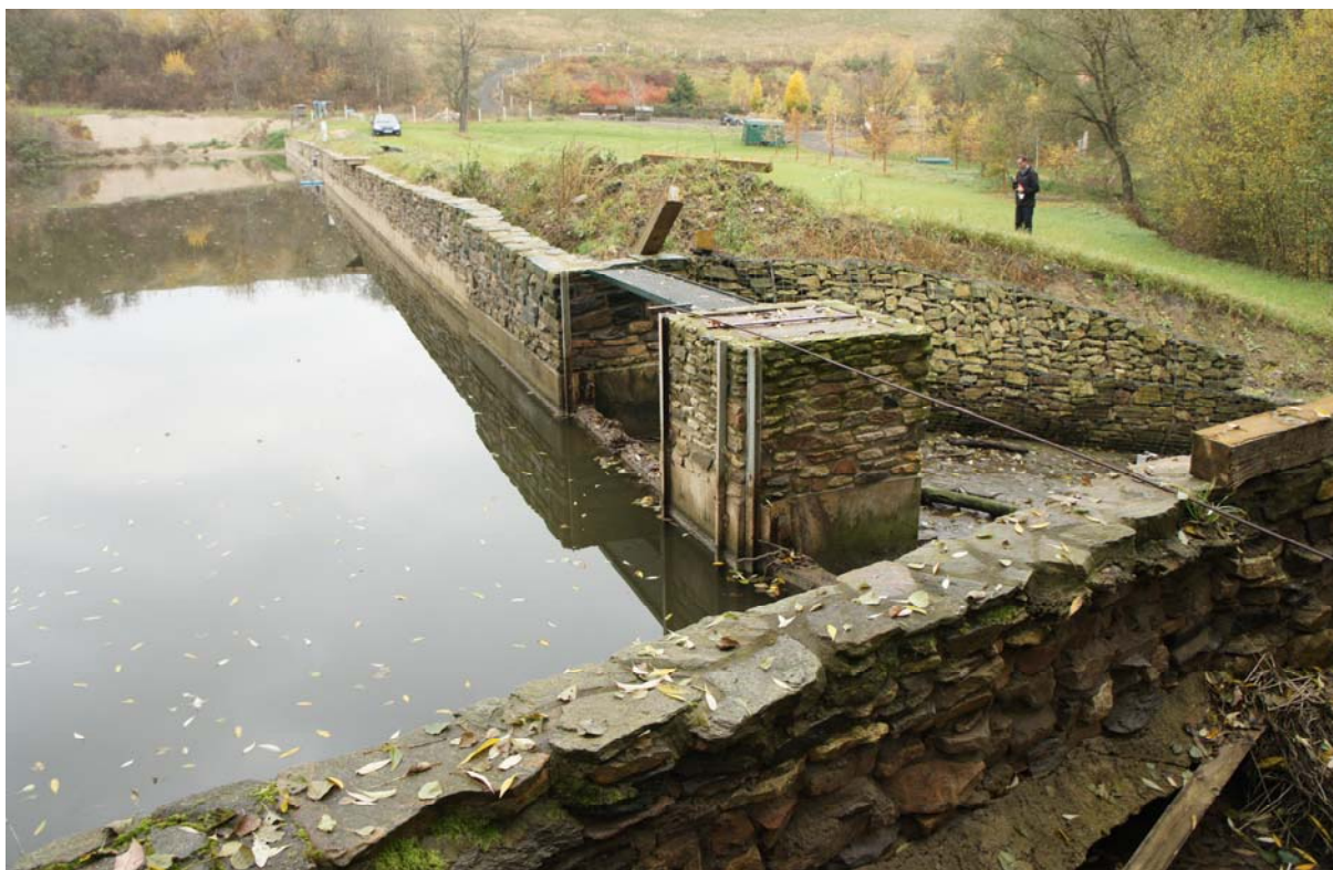
Červený rybník – pohled na poškozené VD (VD-TBD a.s., 23.10.2013)
