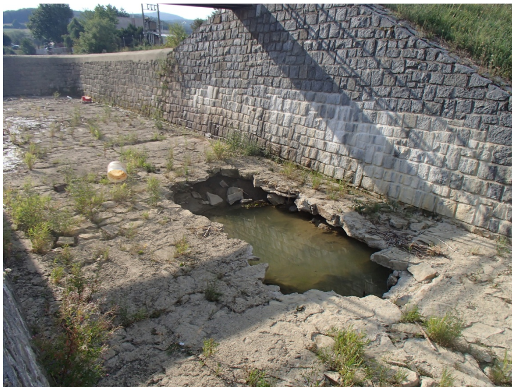
VD Bánov_Ordějov Poškozený skluz – hloubka výmolu víc jak 1,5m
