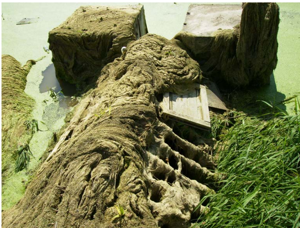
Olšovka - ucpání vtokového objektu
