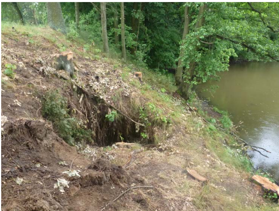
Rybník Nový Jistebnický - propadlý vzdušný svah v profilu spodní výpusti (VODNÍ DÍLA – TBD a.s., 24. 6. 2013)
