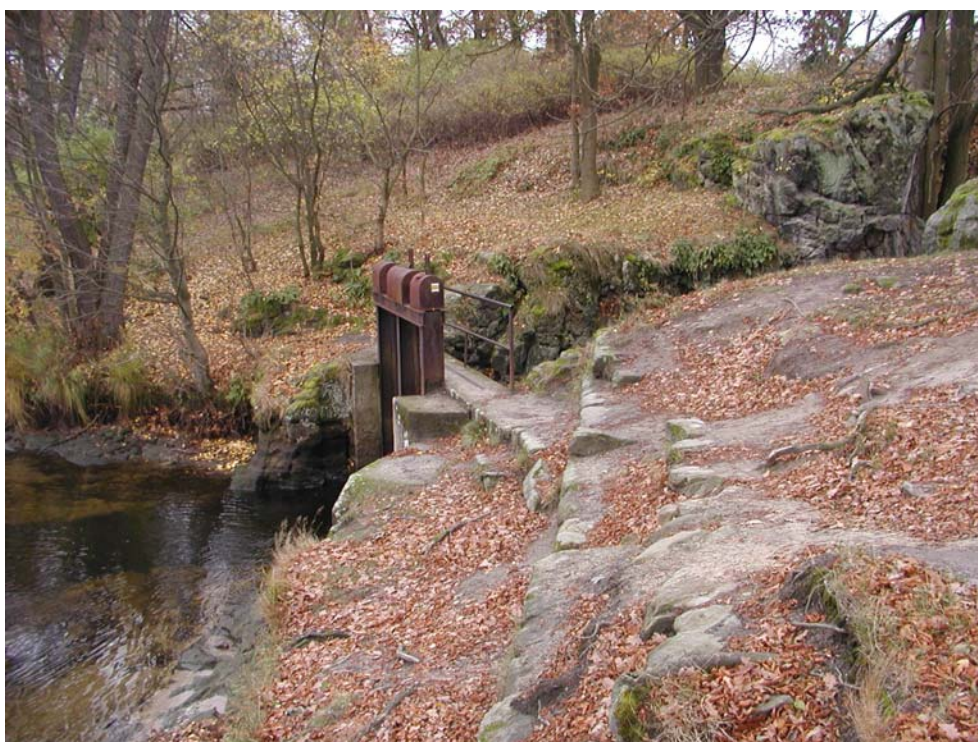
Stavidlová výpust s funkcí hrazeného bezpečnostního přelivu 6.11.2009
