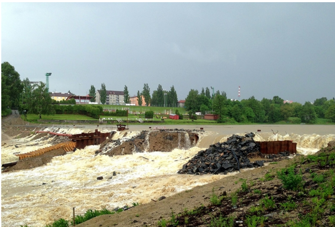
2.6.2013 – opětovné přelévání dělící hráze zřízené z důvodu stavby – Obnova rybníka Jordán
