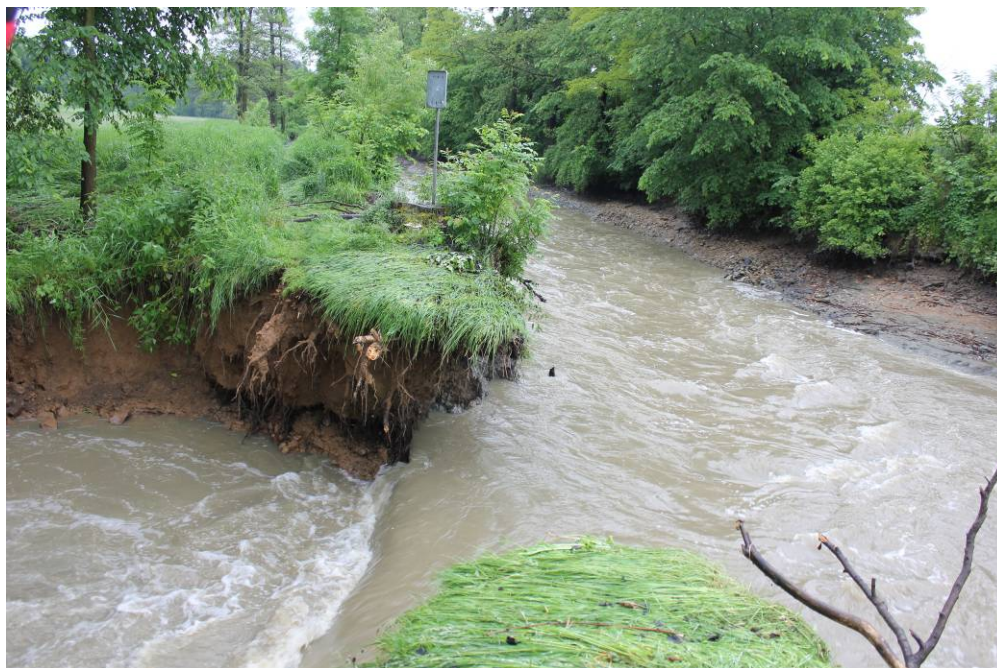
Rybník Zájezdek - pohled na průřvu v tělese hráze (2. 6. 2013).
