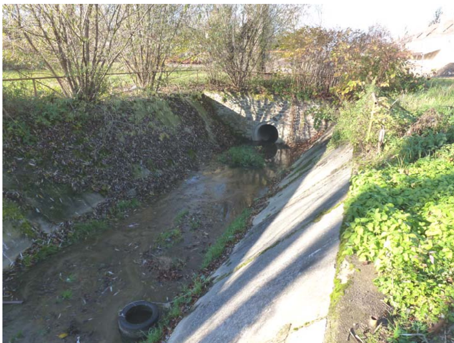
Rybník Dříteňský – nekapacitní zatrubněný odpad od bezpečnostního přelivu a spodních výpustí (VODNÍ DÍLA – TBD a.s., 12. 11. 2013).
