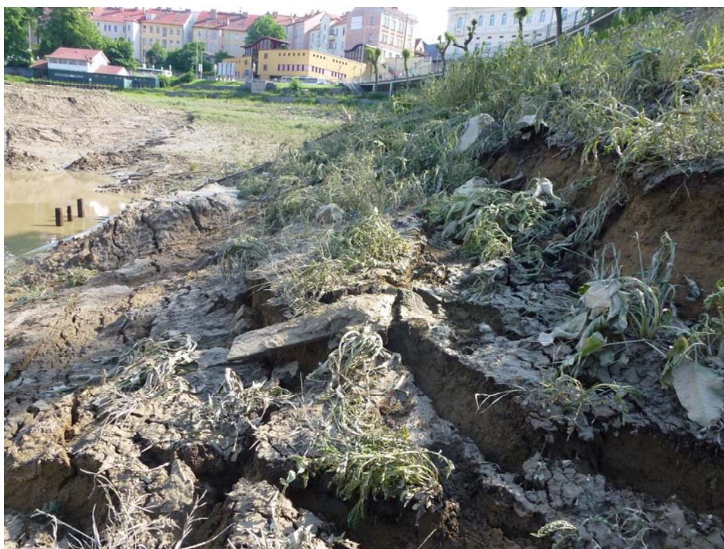
Trhliny na návodním svahu – stav ze dne 6.6., 16,45 hod.
