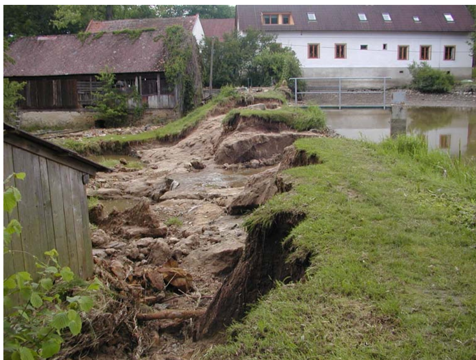
Protržená hráz rybníka na Drážkách, stav 7.6.2013.
