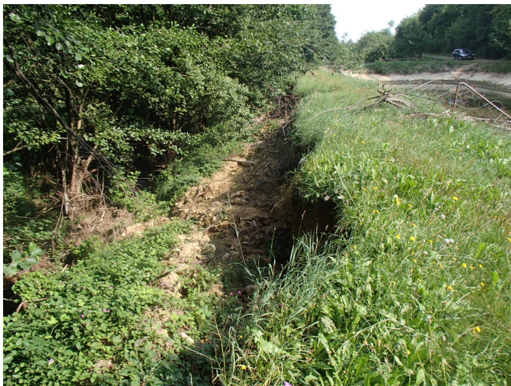
VD Komňa vzdušní svah boční hráze poškozený při přelévání hráze
