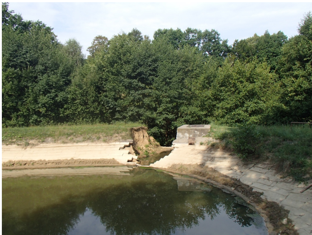
VD Komňa, trhlina vedle výpustného objektu
