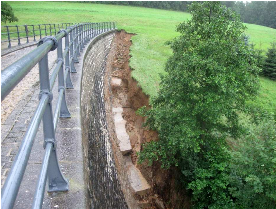
Obr. 4.10 - VD Mlýnice, erozní výmoly u pata vzdušního líce po povodni
