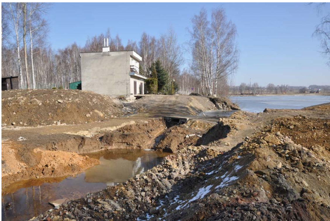
Obr. 3.42 – Kristina – protržená ochranné hráze v severozápadní části – pohled na průřvu od návodní paty tělesa hráze
