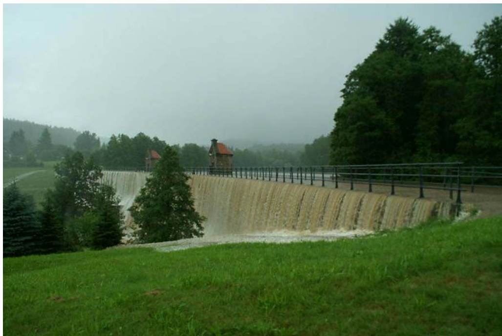
Obr. 2.14 - VD Mlýnice, přelévání koruny hráze (7.8. 10:56 hodin)
