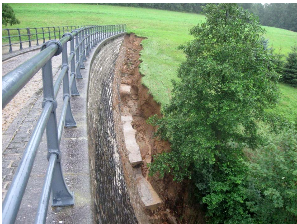
Obr. 2.17 - VD Mlýnice, erozní výmoly u pata vzdušného líce po povodni
