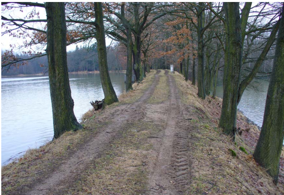
Obr. 3.30 – Kařezský horní – pohled na korunu hráze v místě největšího poškození (vlevo rybník Kařezský horní a v pravo rybník Kařezský dolní)
