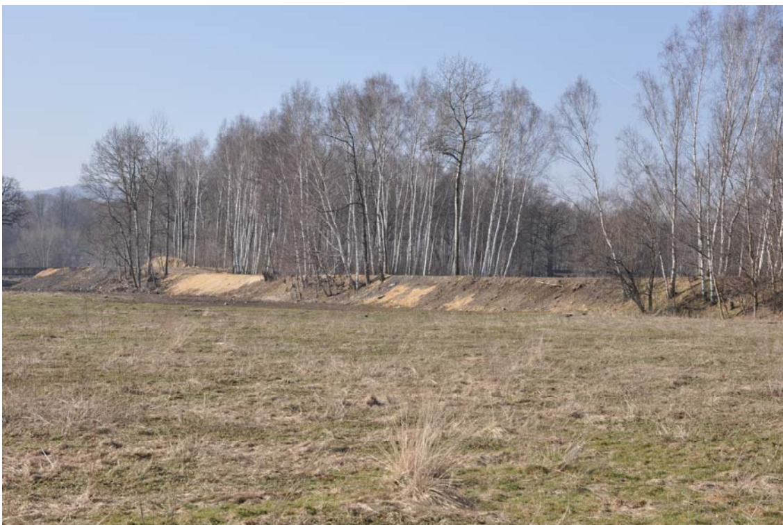
Obr. 3.45 – Kristina – pohled na návodní svah opravené části ochranné hráze, kde došlo k během srpnových povodní na několika místech k protržení tělesa hráze a zaplavení rekreační nádrže Kristina vodou z Lužické Nisy
