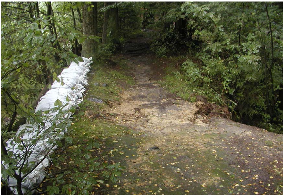
Obr. 3.28 – Velký svorský rybník – Pohled na nátrž ve vzdušném svahu a na provizorní hrázku v profilu výpusti.
