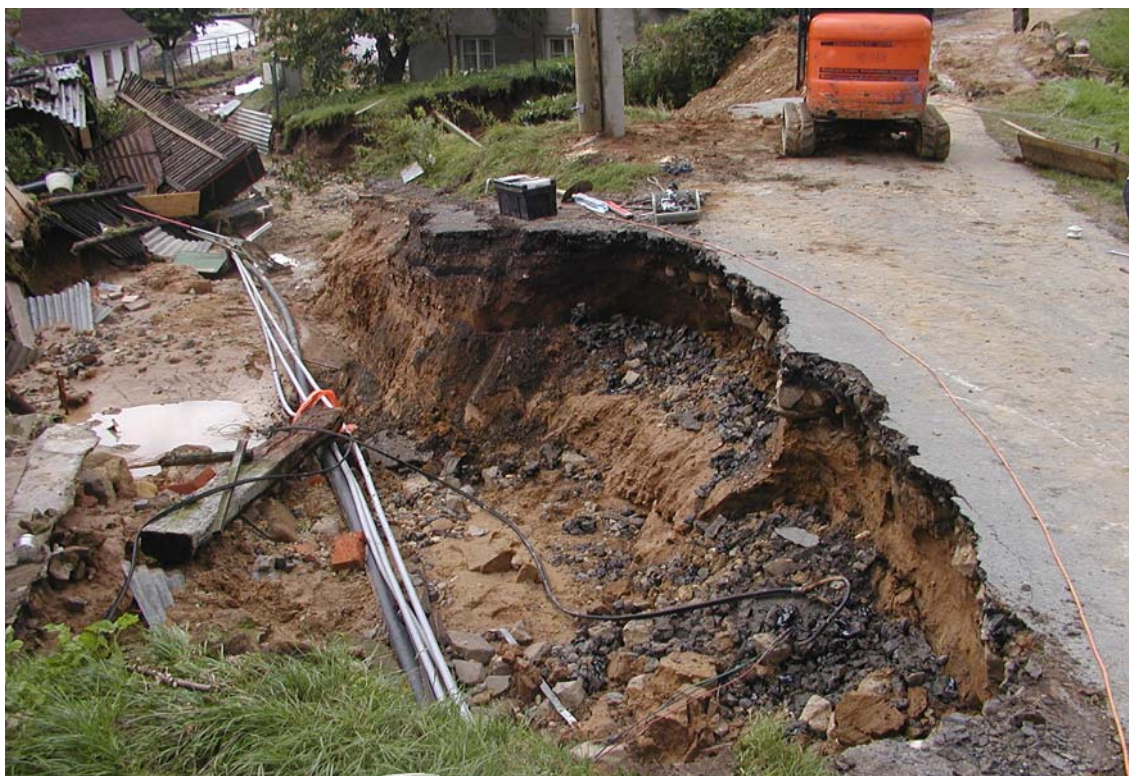
Obr. 3.21 – Markvartický rybník – Pohled na nátrž ve vzdušném svahu hráze vlevo od provizorně zasypané průrvy.
