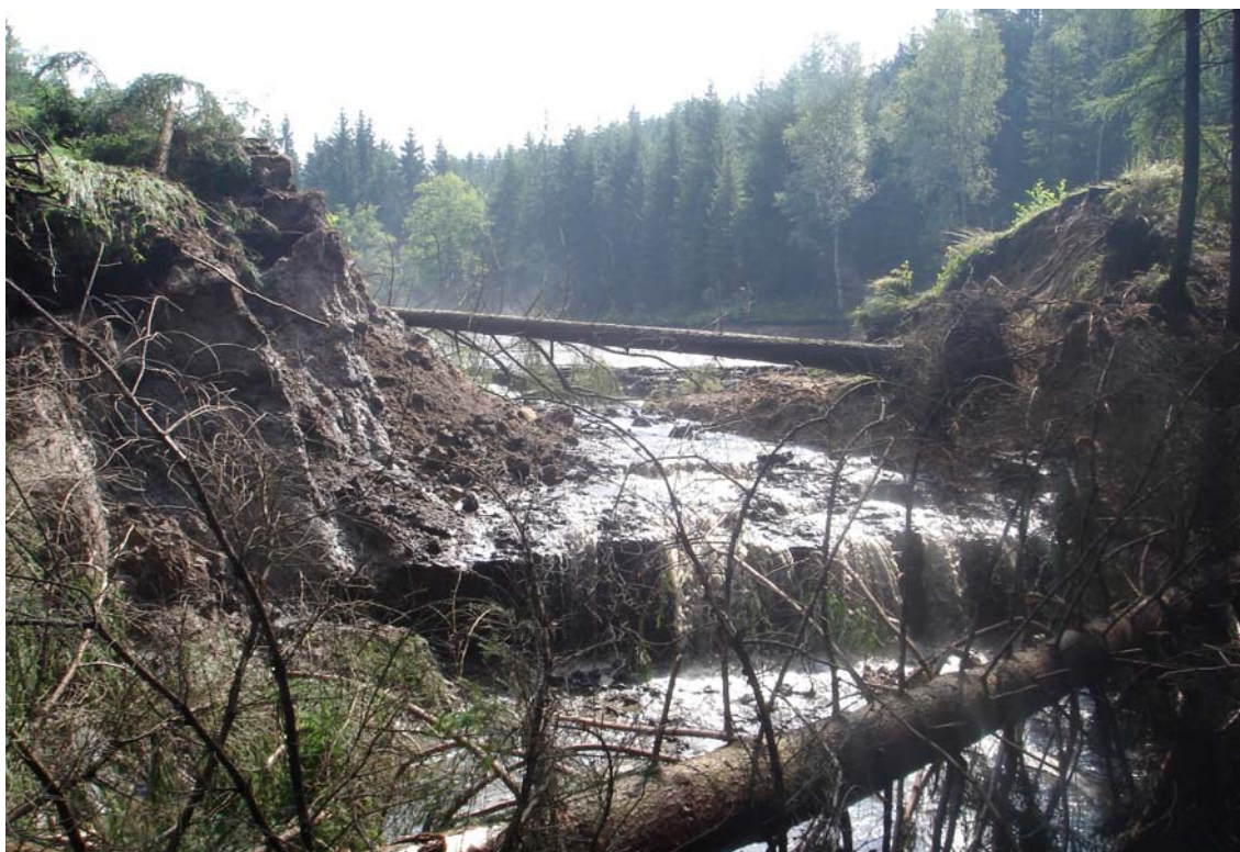
Obr. 3.33 – Malý Jedlovský rybník – protržená hráz v profilu spodní výpusti – pohled od vzdušní paty tělesa hráze
