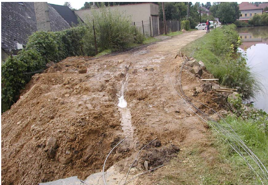
Obr. 3.20 – Markvartický rybník – Pohled na provizorně zasypanou průrvu ve střední části hráze.
