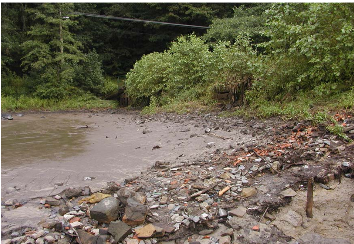
Obr. 3.19 – Kněžický rybník – Pohled na návodní svah a bezpečnostní přeliv v levém konci hráze
