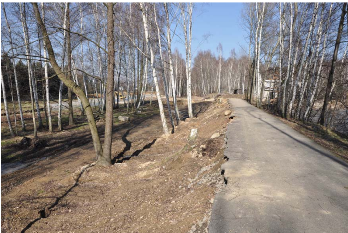
Obr. 3.44 – Kristina – pohled na porušený návodní svah ochranné hráze
