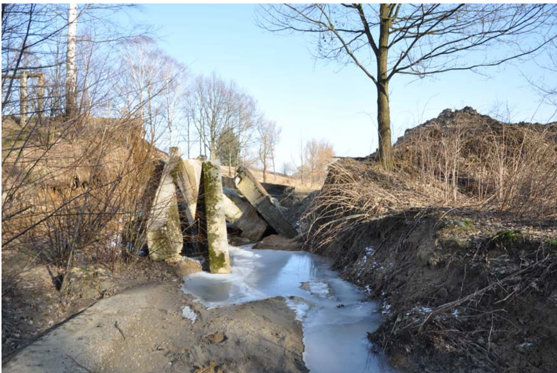
Obr. 3.37 – Panenský rybník – protržená hráz – pohled z odpadního koryta od přelivu
