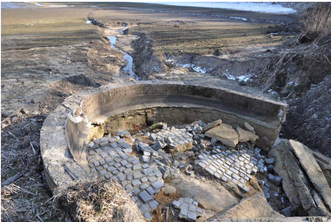
Obr. 3.36 – Panenský rybník – pohled na zničený bezpečnostní přeliv
