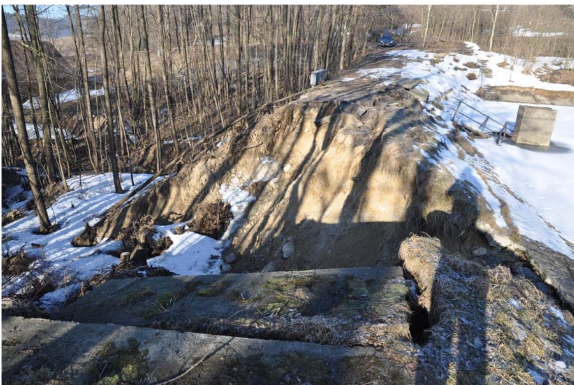
Obr. 3.39 – Retenční nádrž Albrechtice – protržená hráz z pohledu z koruny hráze
