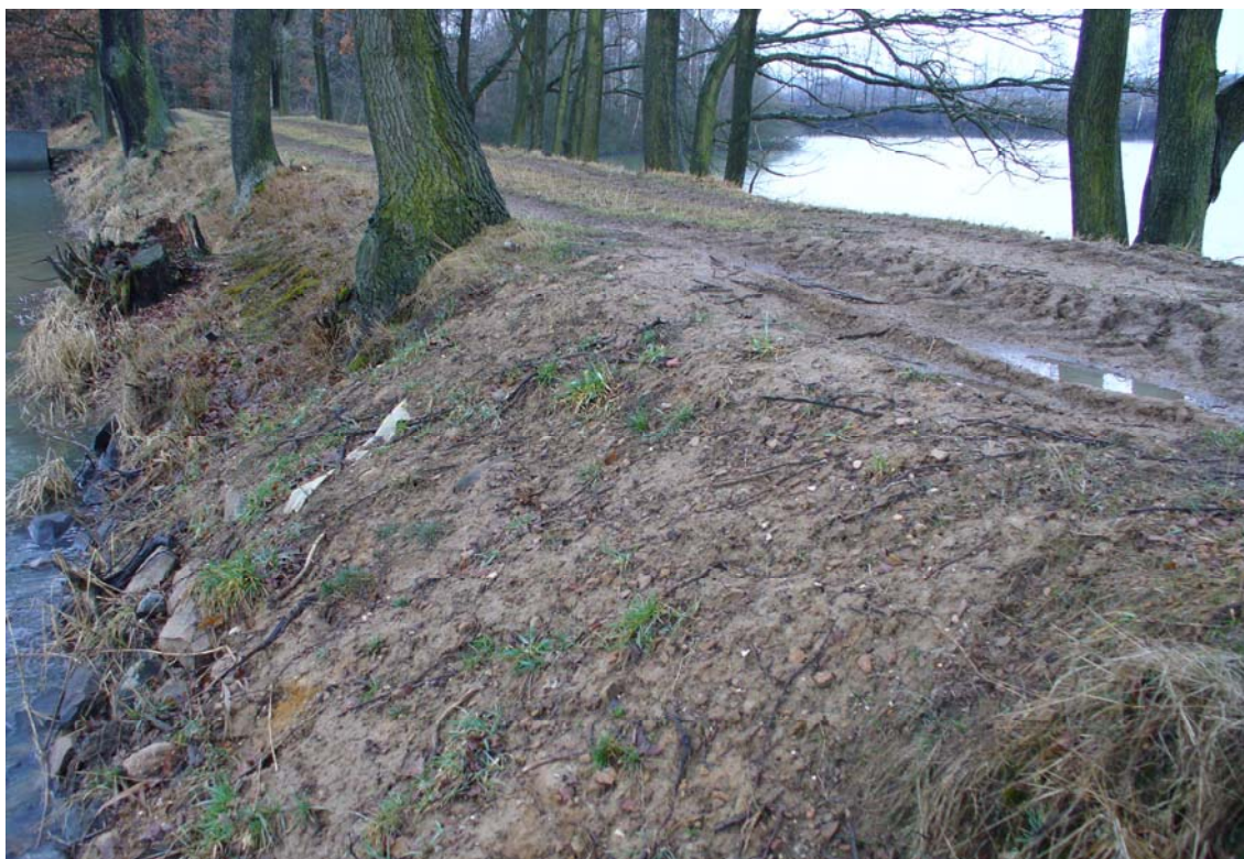
Obr. 3.31 – Kařezský horní – pohled na návodní svah a korunu hráze v místě největšího poškození
