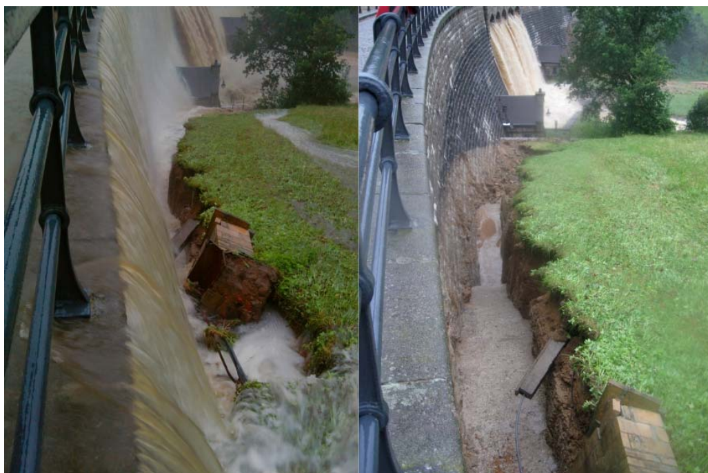
Obr. 2.15 - VD Mlýnice, pata vzdušního líce při a po povodni
