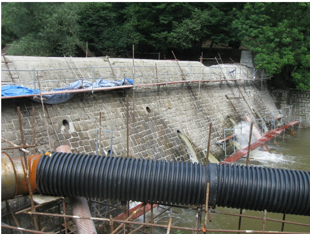
Obr. 4.1 – Prostor stavby s poničeným lešením po povodni v červenci 2010
