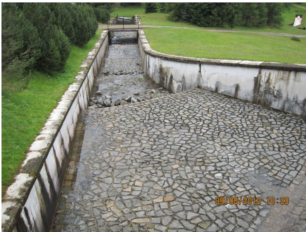
Obr. 2.9 - VD Bedřichov, poškozená kaskáda od bezpečnostního přelivu
