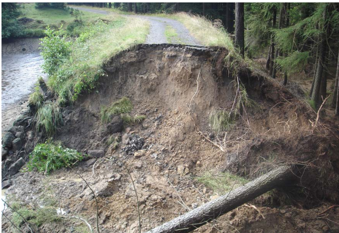
Obr. 3.32 – Malý Jedlovský rybník – protržená hráz v profilu spodní výpusti – pohled z koruny hráze
