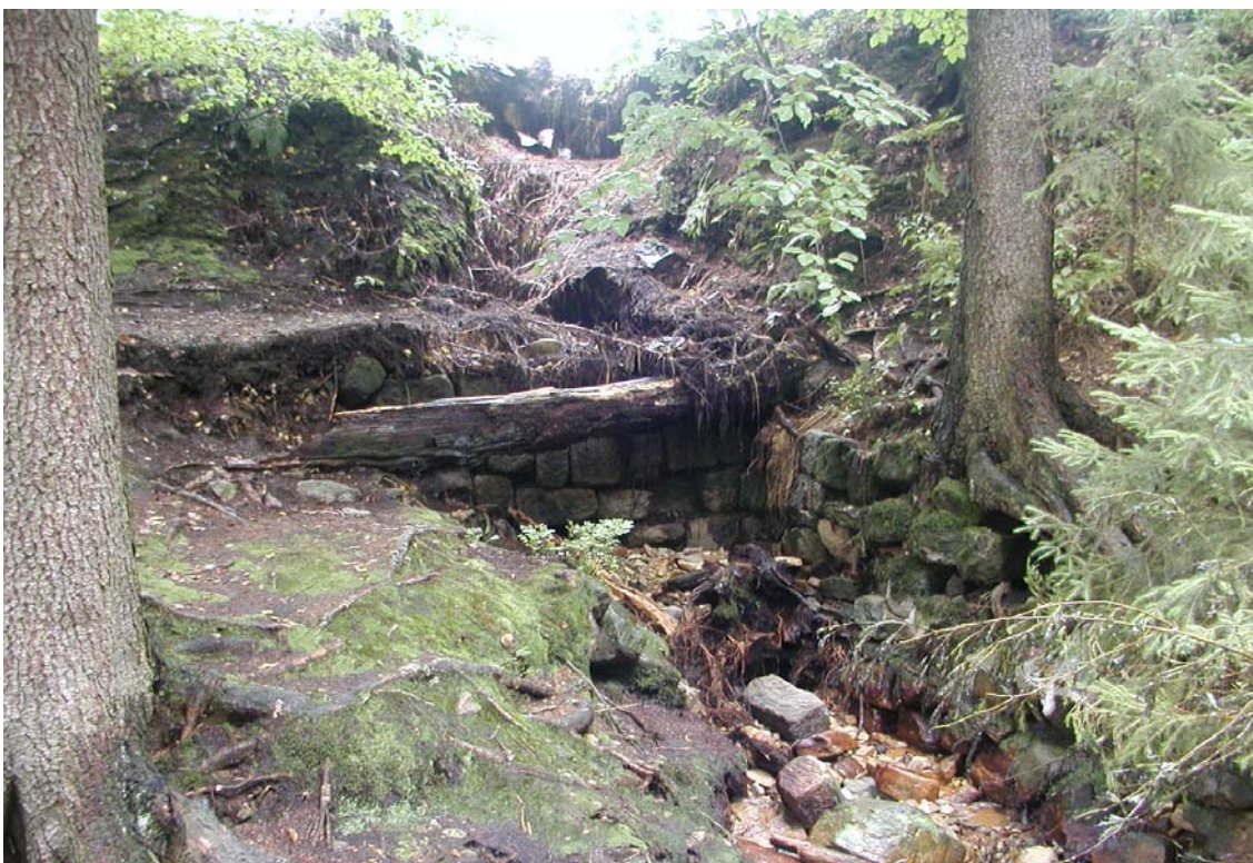
Obr. 3.29 – Velký svorský rybník – Pohled na nátrž ve vzdušném svahu v profilu výpusti..
