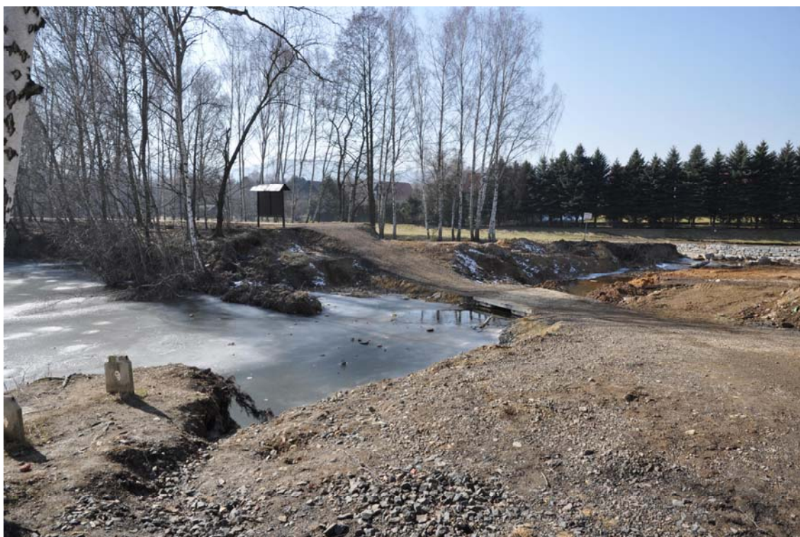
Obr. 3.43 – Kristina – protržená ochranná hráz v severozápadní části – pohled levého zavázání – vlevo je vidět zamrzlá hladina rekreační nádrže Kristina, vpravo vzadu koryto pak koryto Lužické Nisy
