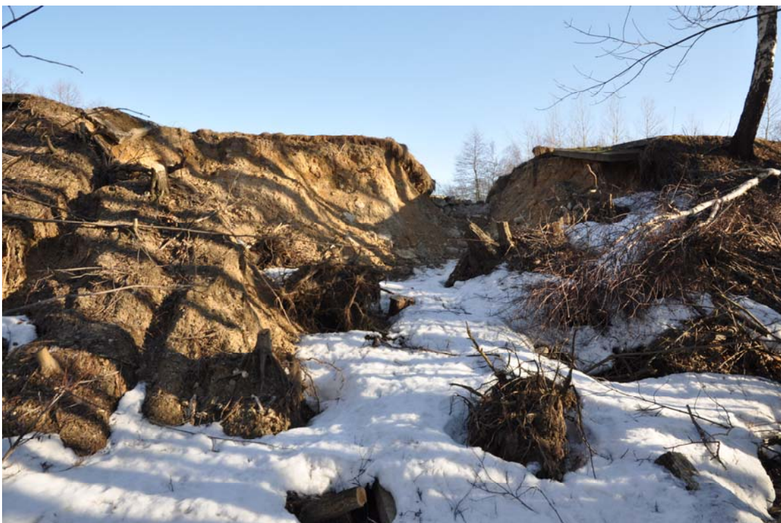
Obr. 3.38 – Retenční nádrž Albrechtice – protržená hráz z pohledu od vzdušné paty hráze
