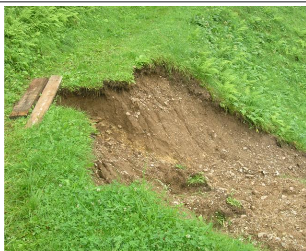
Foto 5 – pohled na porušený svah a cestu pro pěší nad č.p. 40
