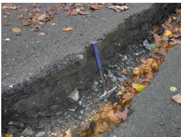
Foto 3 – Detailní pohled na propad vozovky
