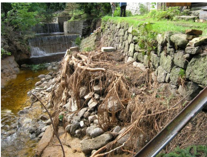
Foto 5 – Erodovalý břeh Černého potoka a narušená opěrná zed', nad ní plošina s trhlinami
