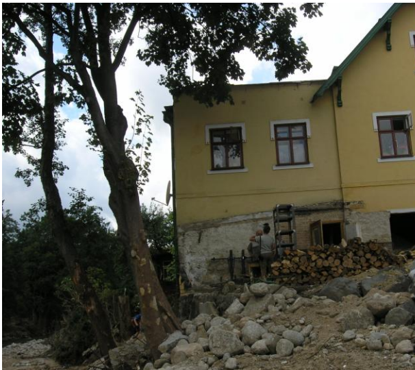
Foto 3 – Poškozená čelní levá část domu č.p. 205, před kterou stály 3 garáže
