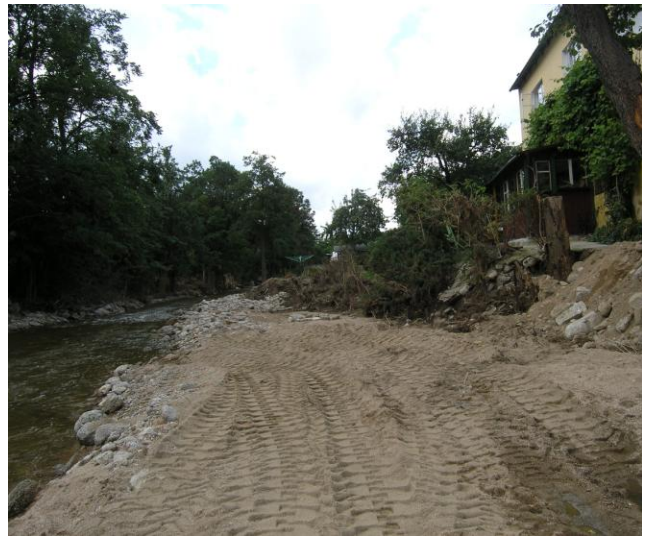
Foto 4 – Rozhmuté naplaveniny při pravé straně koryta řeky Smědá pod č.p. 205
