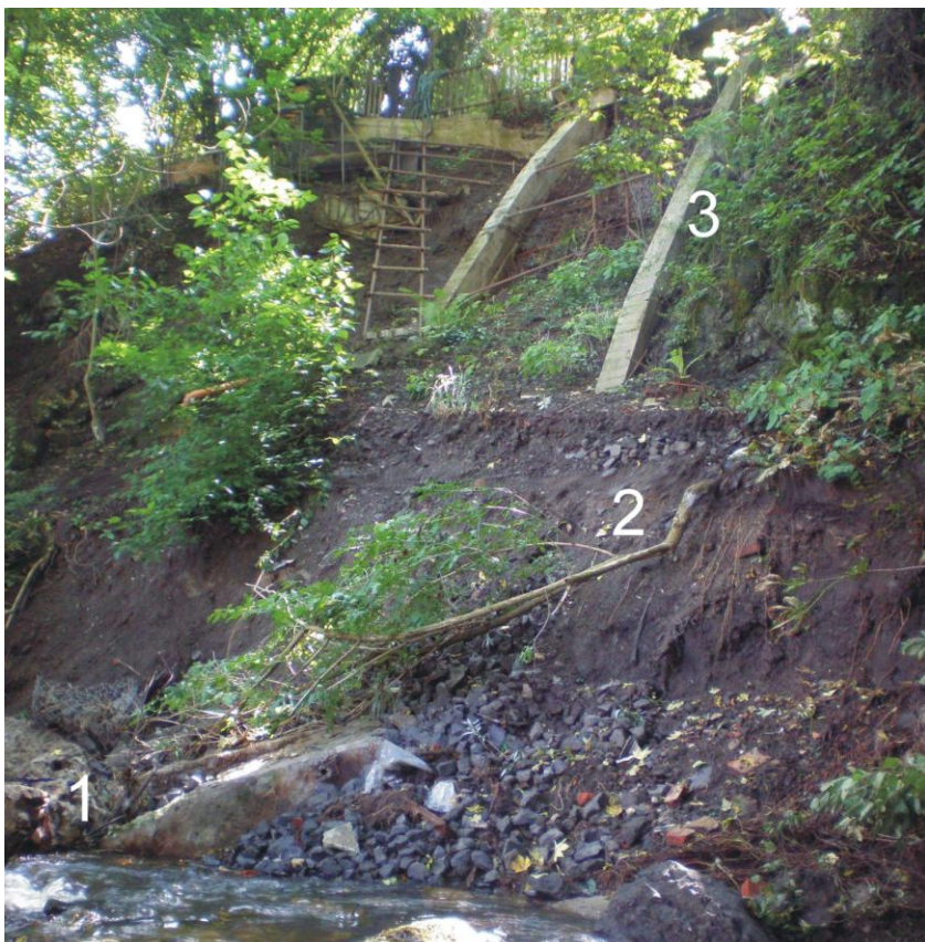
Foto 1 Část svahu se zničeným betonovým soklem (1) a reliktem akumulace svahovin s navážkami (2). Nosníky (3) nadále podpírají betonovou desku dvorku. (foto J. Malík, 19.08.2010)
