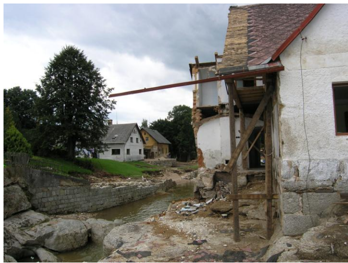
Foto 4 – Poškození domu čp. 327, zdevastované okolí
