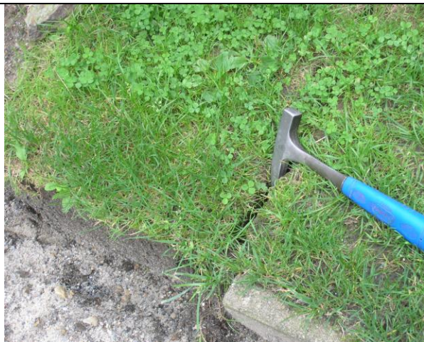
Foto 5 – Roztrhaný okraj horní hrany svahu
