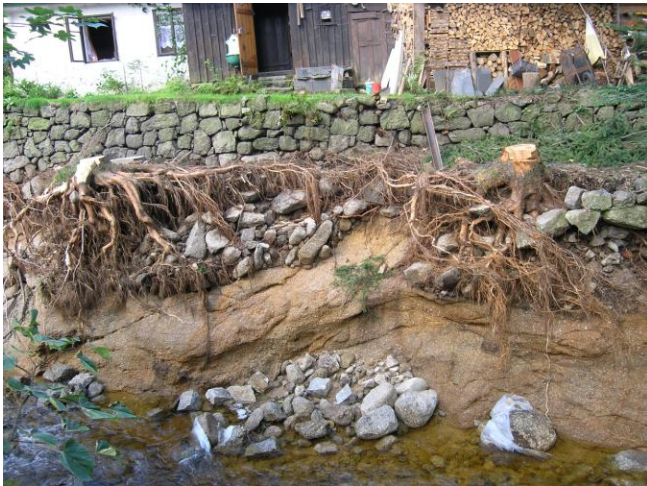
Foto 1 – Pohled na porušenou zed' u domu čp. 239, stojící na výchozu liberecké žuly s žilami aplitu na břehu Černého potoka
