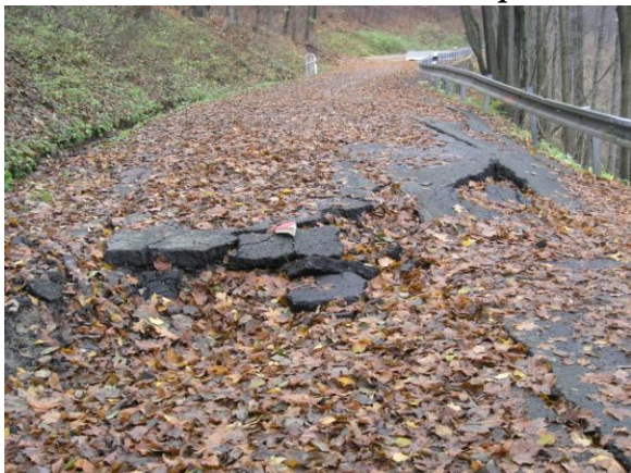
Foto 1 – Propadlá a zvlněná vozovka silnice II/592
