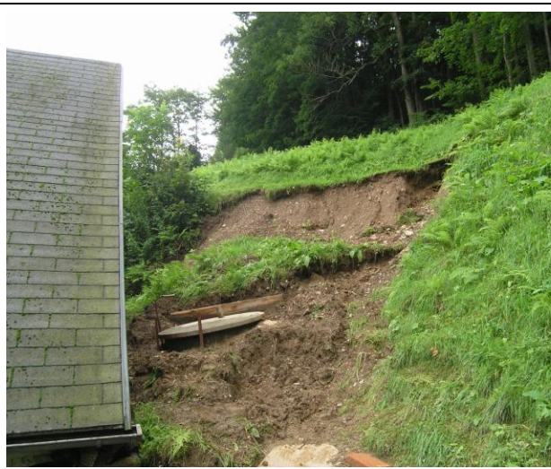
Foto 2 – porušený svah za domem s poškozenou studnou
