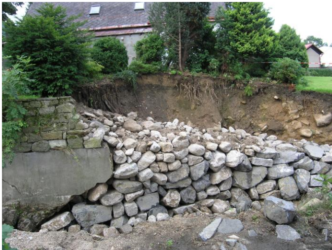
Foto 1 – Pohled na porušenou nábrežní zeď u domu č.p. 88
