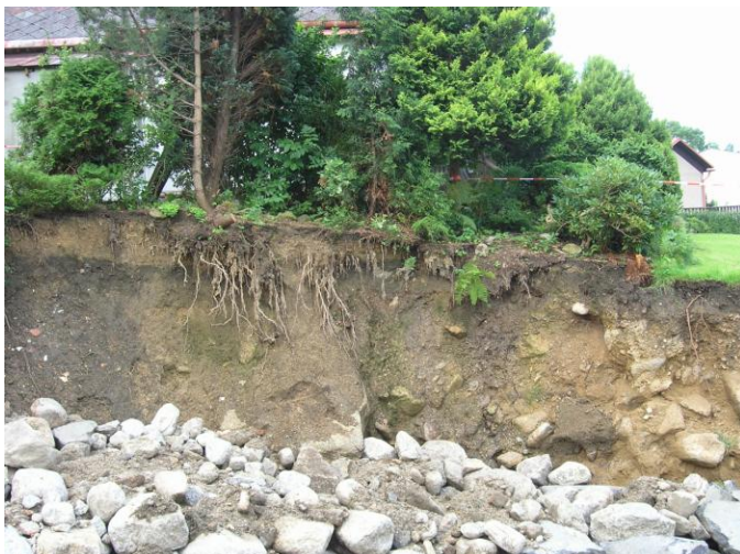
Foto 5 – Erodovalý břeh potoka, v prostoru mezi stromy je umístěn septik
