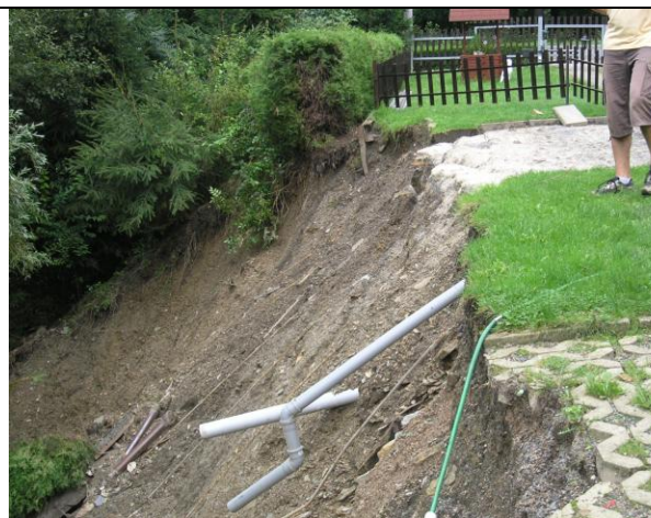
Foto 2 – Utržený svah s vývody dešťové kanalizace
