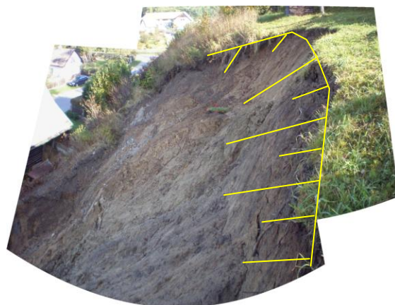
Foto 2 Odlučná stěna sesuvu vysoká cca 2 m (vpravo), pod ní relikty transportní části.
