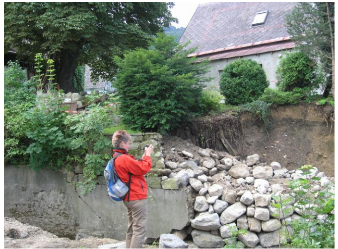
Foto 2 – Narušený břeh je dočasně stabilizován kamennou rovnaninou, vlevo zbytek původní nábrežní betonové zdi
