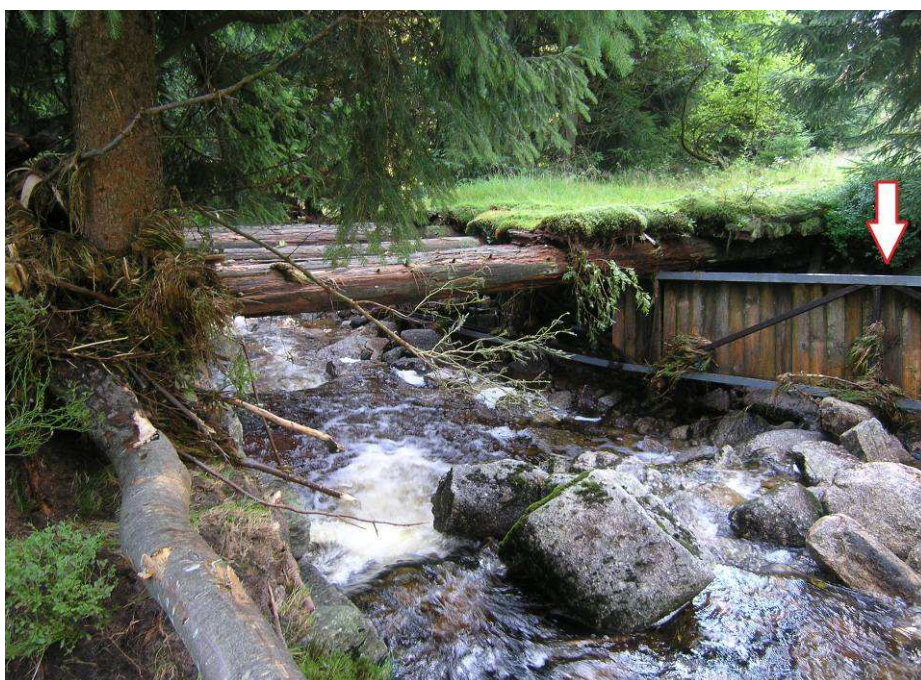
Obr. 5.4 Utržená a odnesená lávka na Bílé Smědě
