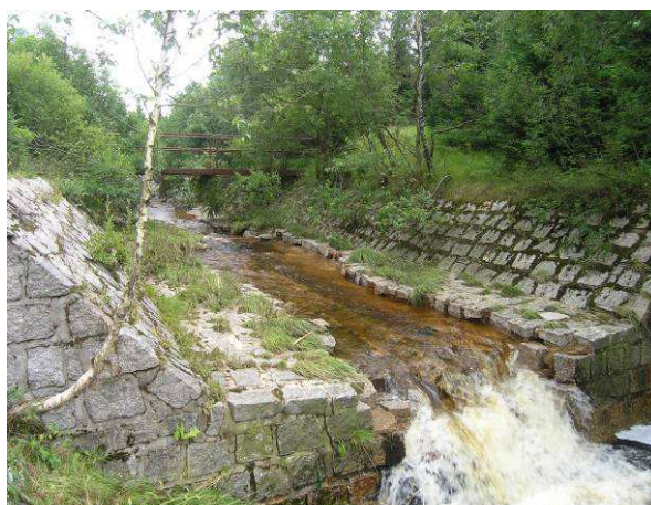
Obr. 3.16 Poškozená dlažba na Černé Smědě
