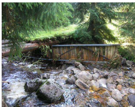
Obr. 3.13 Stržený a odplavený mostek
