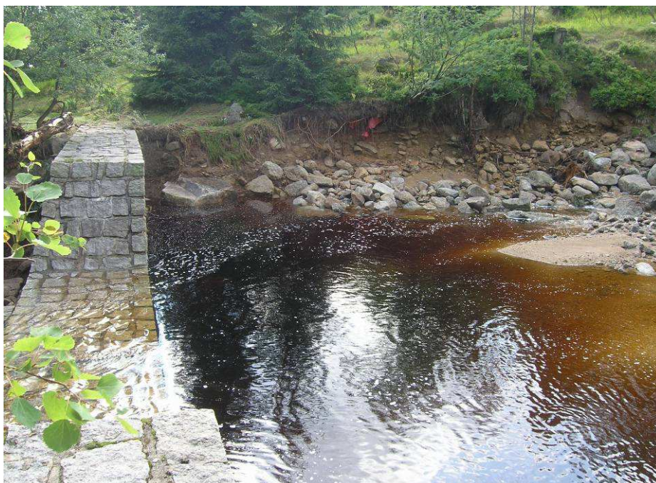
Obr. 5.6 Vymletý břeh nad přehrážkou
