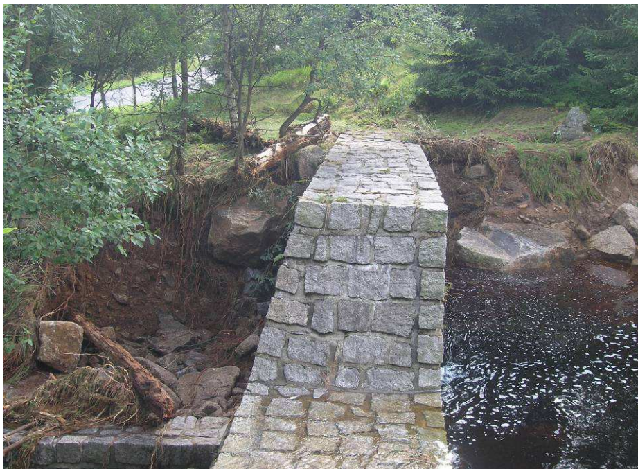
Obr. 5.5 Retenční přehrážka po povodňové vlně na Bílé Smědě
