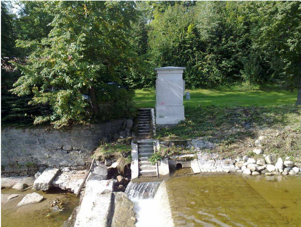
Foto 8.1 Objekt limnigrafické stanice Bílý potok se značkou maximální hladiny a poškozeným stabilizačním prahem
