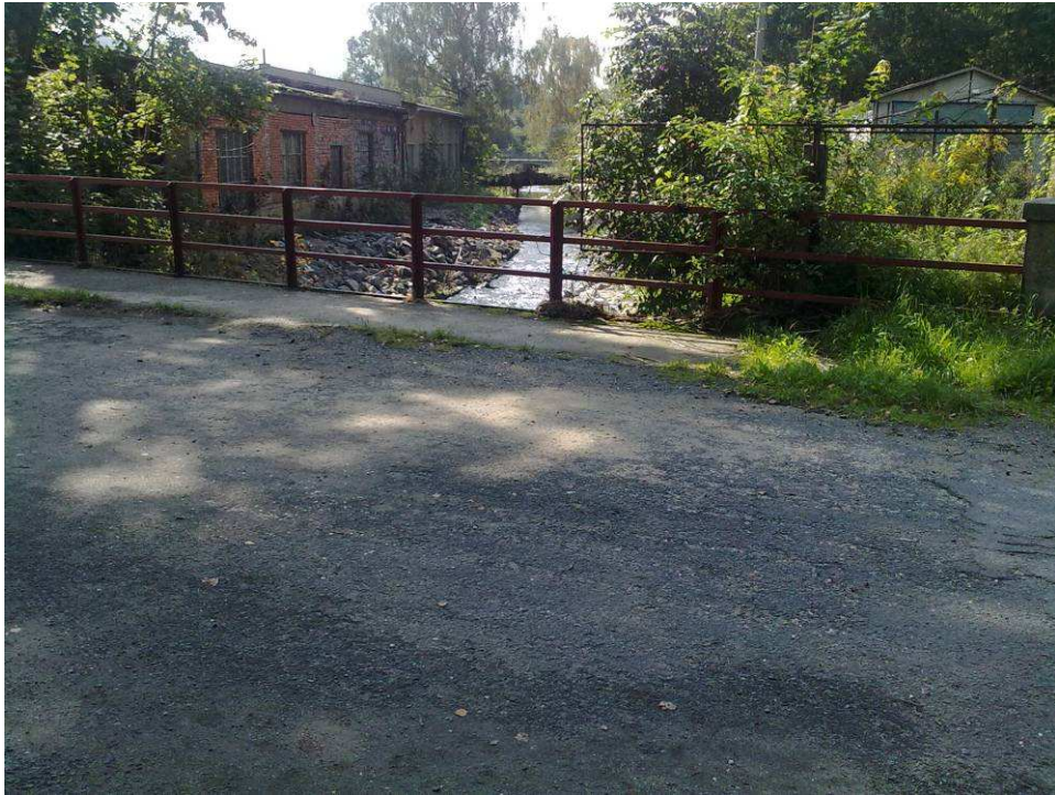
Foto 10.3 Stopa na zábradlí po přelévaného mostu v ř.km 0.574
