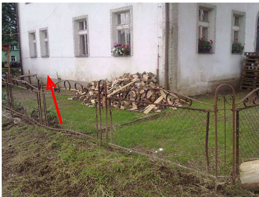
Foto 11.4 – Stopa po kulminační hladině na jednom z domů v blízkosti silničního mostu ve Višňové
