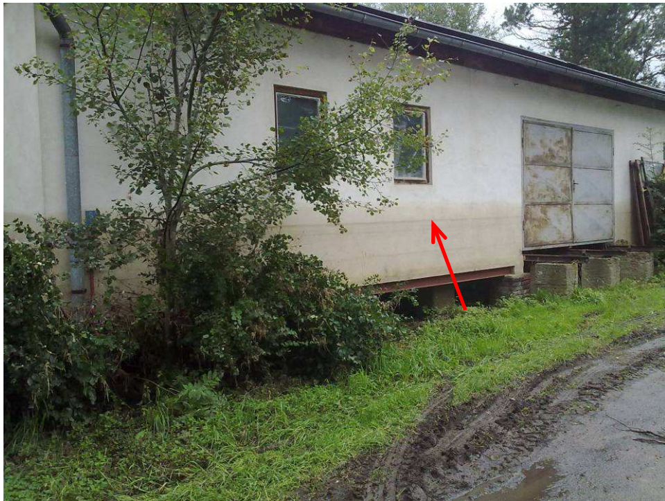
Foto 3.3 Liniová stopa na omítce jednoho ze skladů na počátku posuzovaného úseku na Jeřici v obci Mníšek
