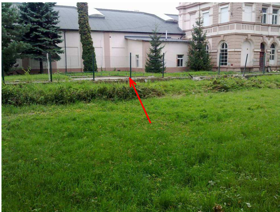
Foto 5.4 Koryto obtokového kanálu podél průmyslového areálu se stopami po kulminační hladině po povodni
