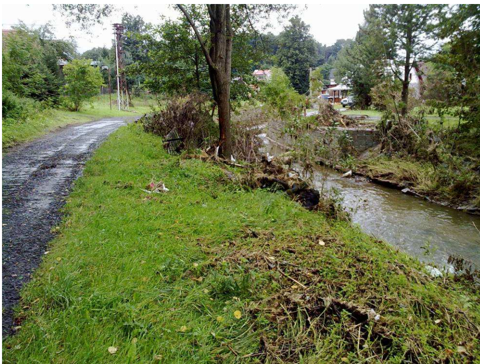
Foto 6.3 Stav koryta po povodni v horní části posuzovaného úseku.
