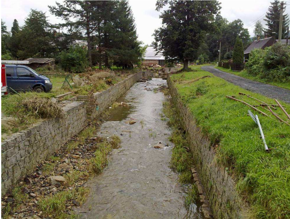
Foto 6.4 Koryto Olešky po povodni nad místním cestovním mostem.
