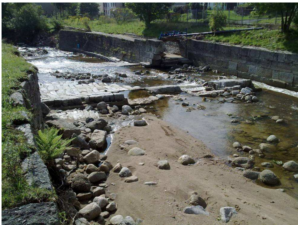
Foto 8.3 Poškozený spádový objekt pod silničním mostem s náplavy
