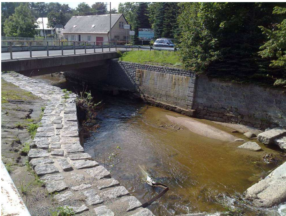
Foto 8.2 Vymleté dno Smědé nad profilem silničního mostu v Bílém potoce
