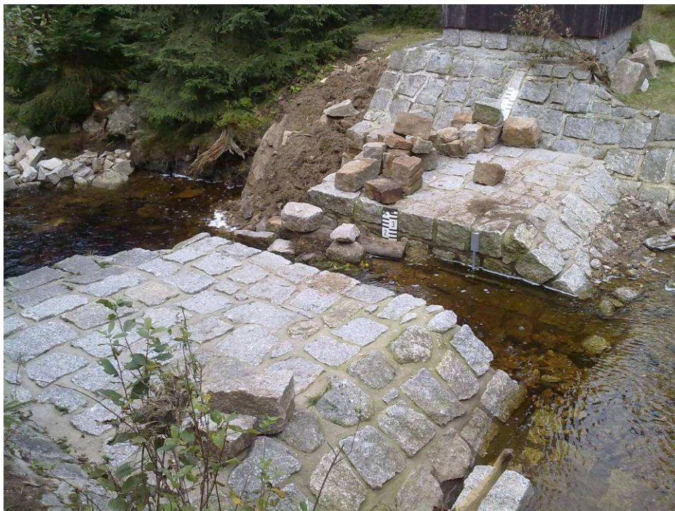
Foto 7.1 Poškozená přelivná hrana stupně v profilu limnigrafické stanice na Bílé Smědě
