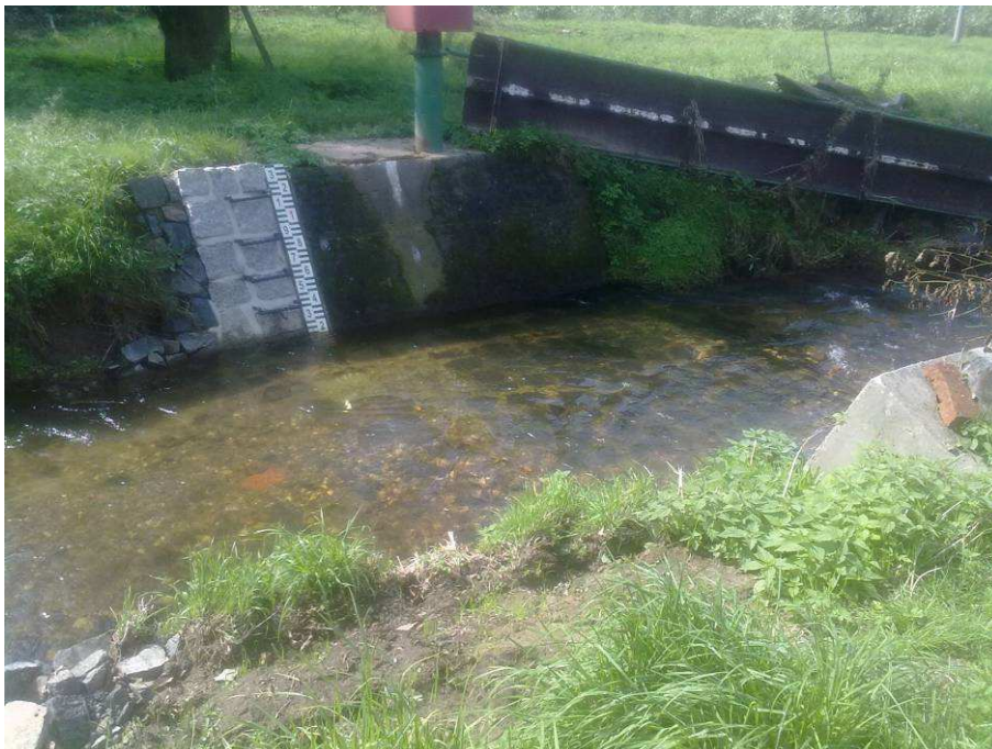
Foto 12.1 Poškozený objekt limnigrafické stanice na Bulovském potoce v obci Předlánce
