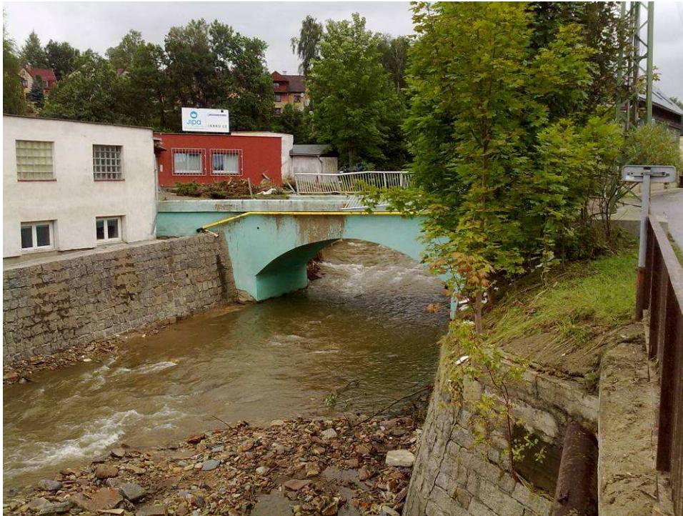
Foto 4.6 Klenbový most v Chrastavě se zničeným zábradlím
