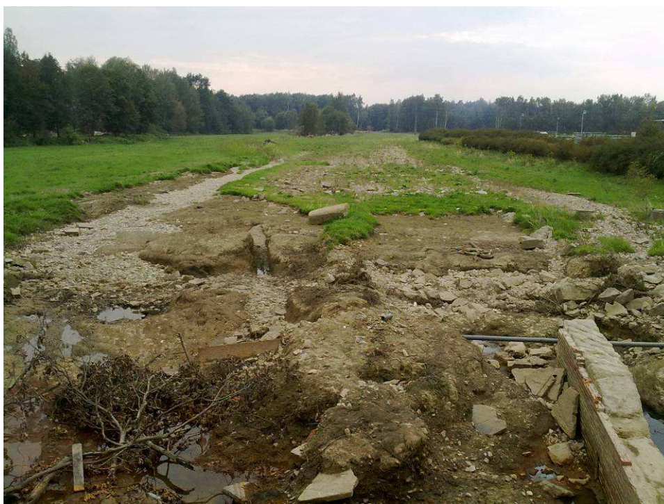
Foto 5.3 Eroze pod objektem inundačního mostu jako důsledek proudění velkého průtoku
