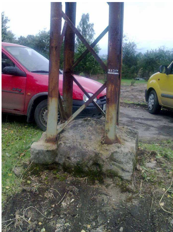
Foto 11.1 – Značka kulminační hladiny z datem výskytu 7.8.2010 na jednom ze sloupů elektrického napětí podél silnice vedoucí v inundačním území
