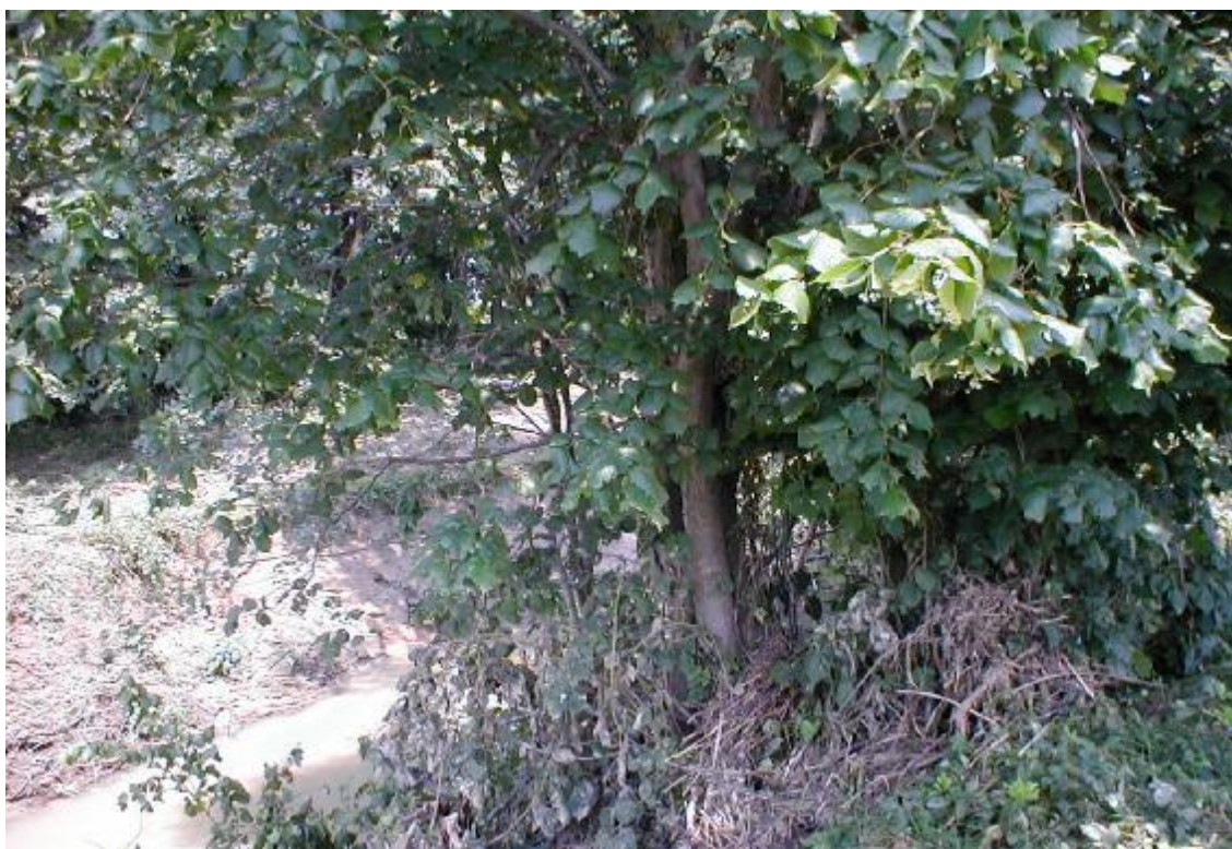
Obr. 2 – Prostor hráze přeléváný při povodni
