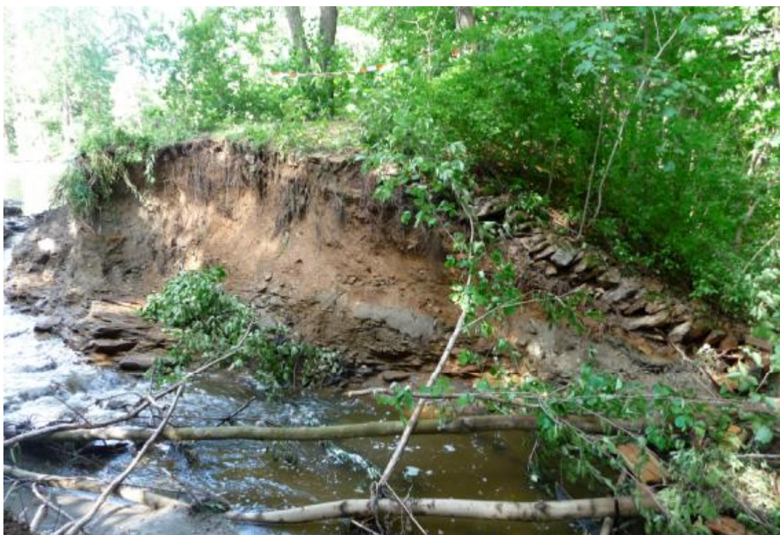
Obr. 6 – Pohled z pravé strany na vyvíjející se průrvu v místě bývalého nouzového přelivu
