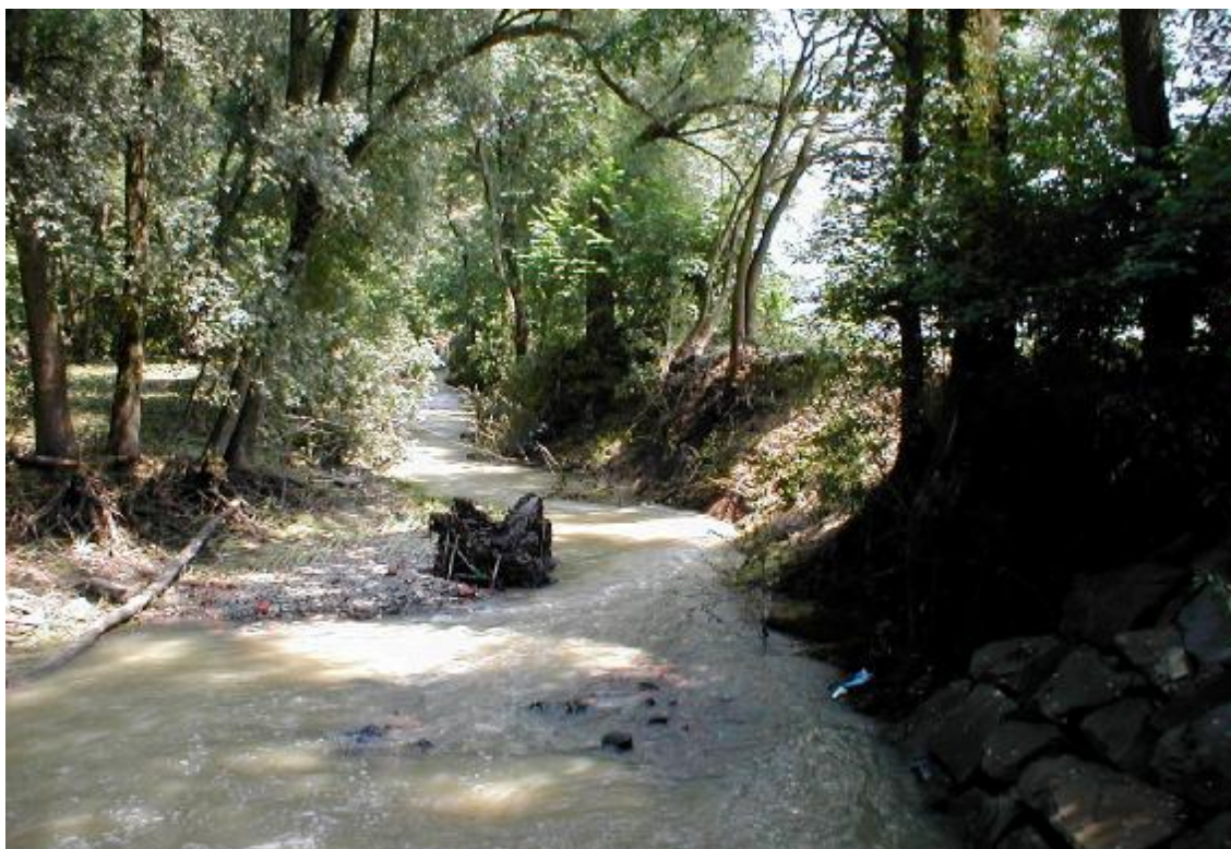
Obr. 1 – Luhou porušená pata a svah hráze
