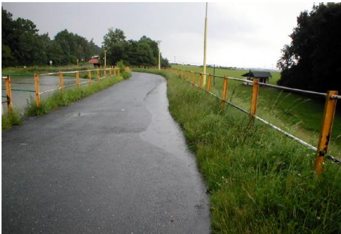
Obr. 4 – Koncentrace vody v nejnižším místě hráze
