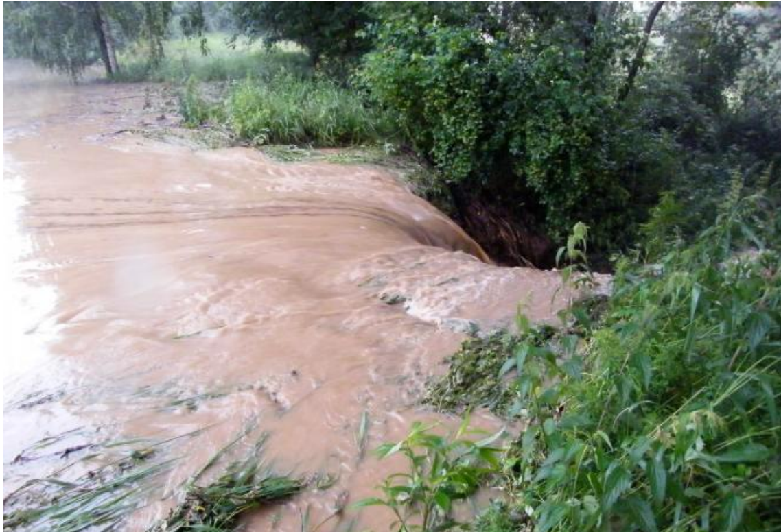
Obr. 1 – Přelití koruny hráze v profilu výpusti a probíhající eroze vzdušního svahu, přelití hráze v levé části - v pozadí
