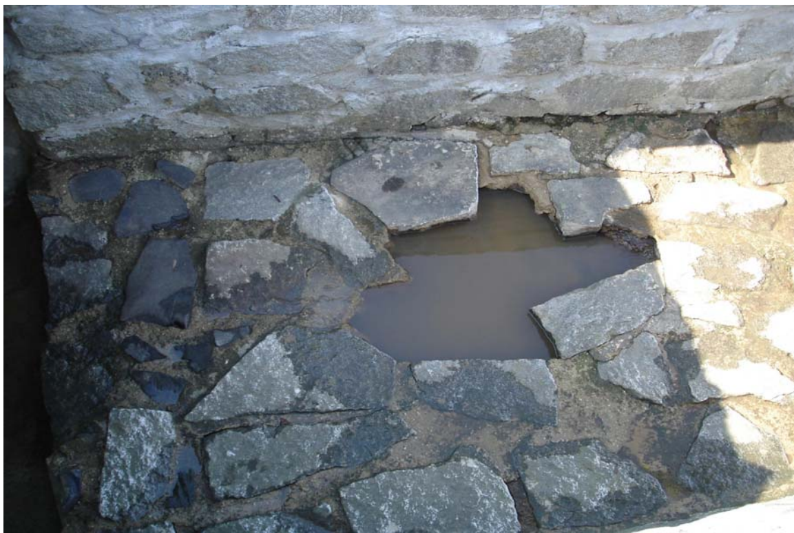
Obr. 3 – Porušená dlažba ve dně skluzu
