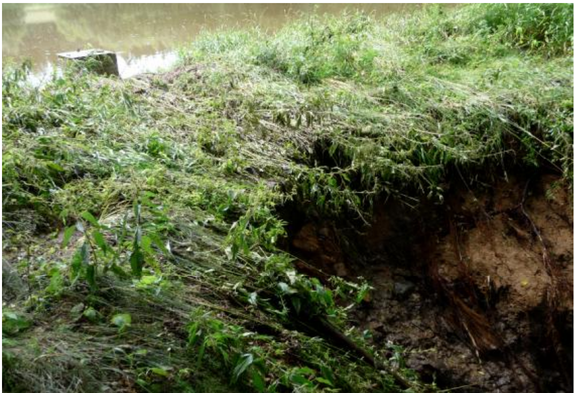
Obr. 2 – Pohled na korunu hráze a místo přelití v profilu spodní výpusti; nátrž zasahující do koruny hráze
