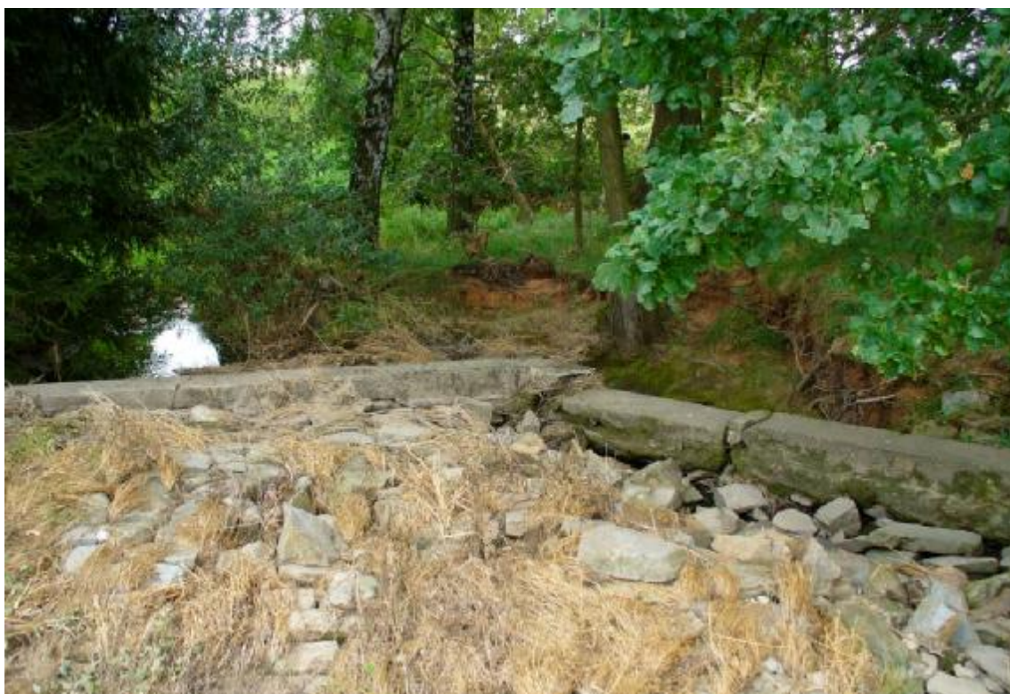
Obr. 2 – Pohled na poškozený skluz od bezpečnostního přelivu po vodě
