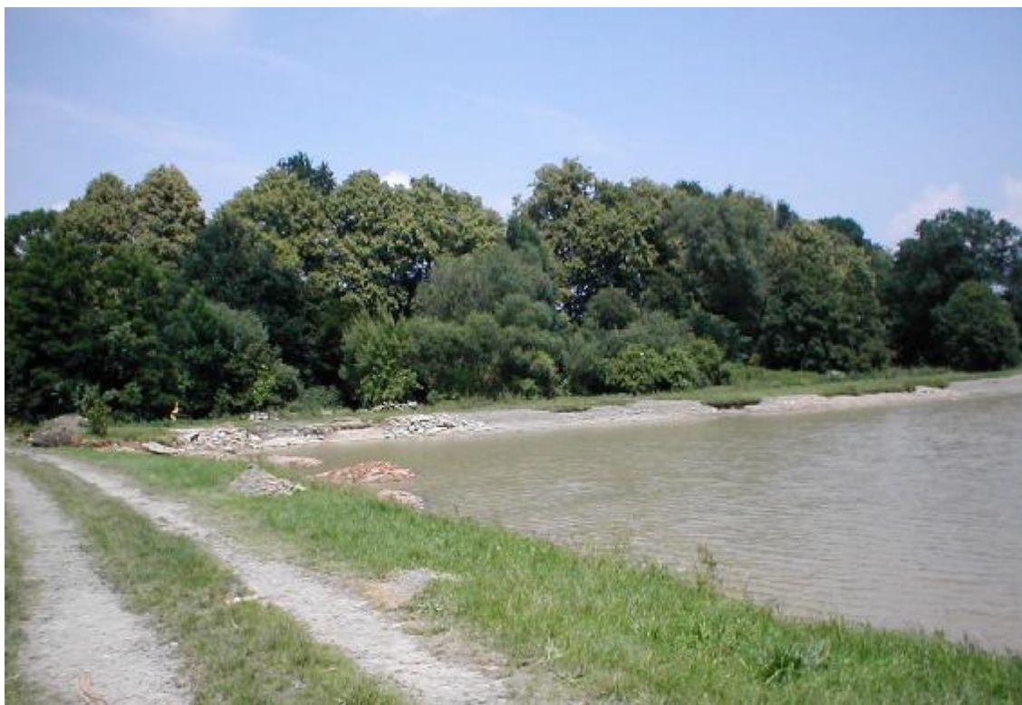
Obr. 1 – Poškozené opevnění hrází
