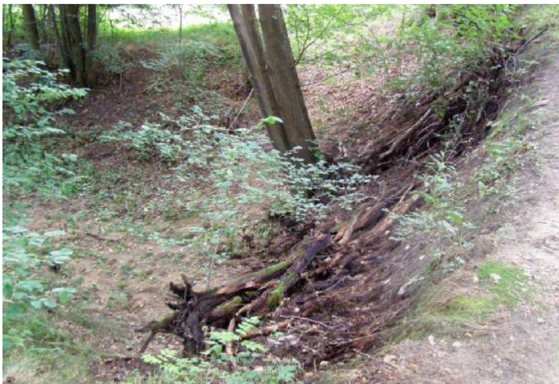
Obr. 1 – Poškození vzdušního svahu v levé části hráze
