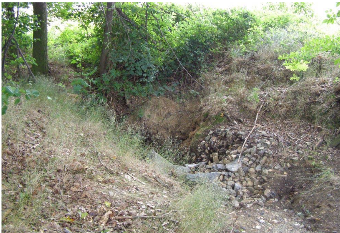
Obr. 3 – Poškození přelivné hrany bezpečnostního přelivu a odpadního koryta
