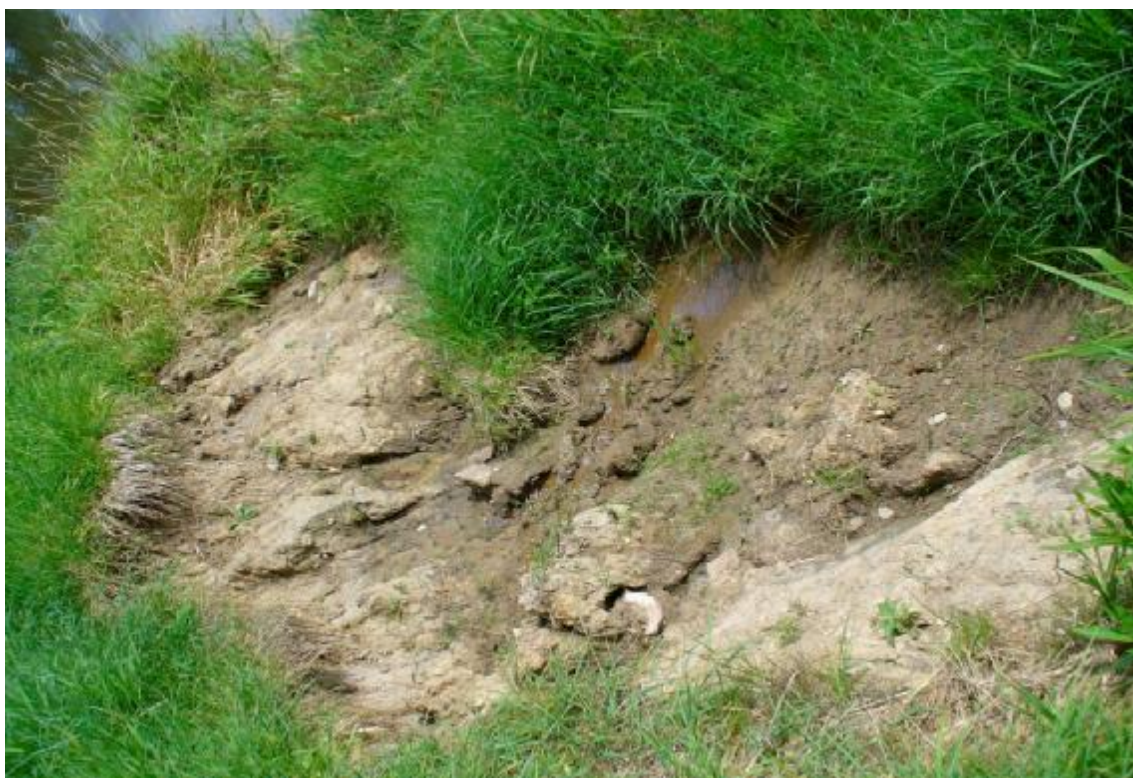
Obr. 2 – Detail poškození vzdušního svahu pravé části hráze
