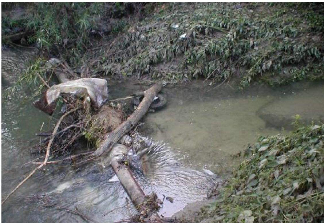
Obr. 3 – Zničené potrubí na vtoku
