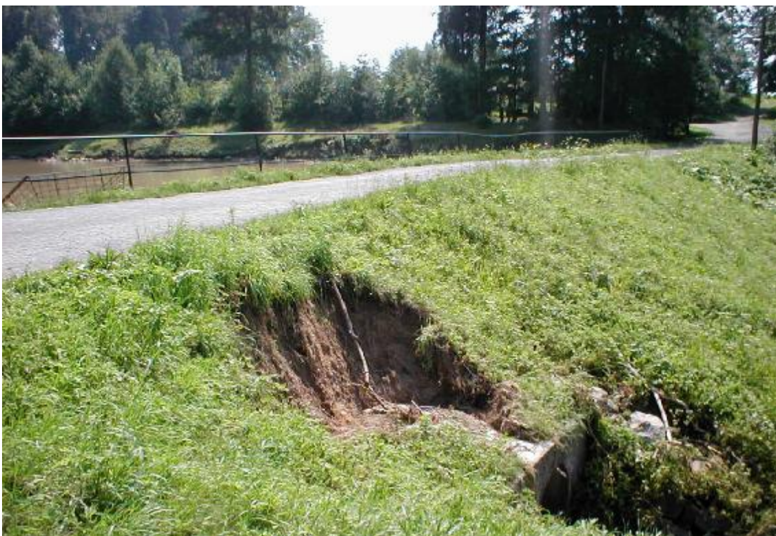
Obr. 1 – Nátrž nad bezpečnostním přelivem
