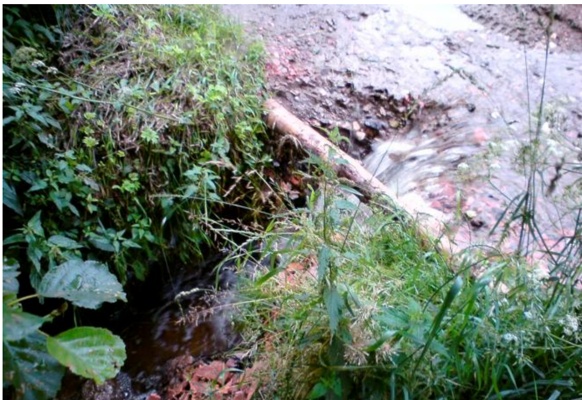
Obr. 1 – Pohled na místo přelítí v profilu spodní výpusti při povodni
