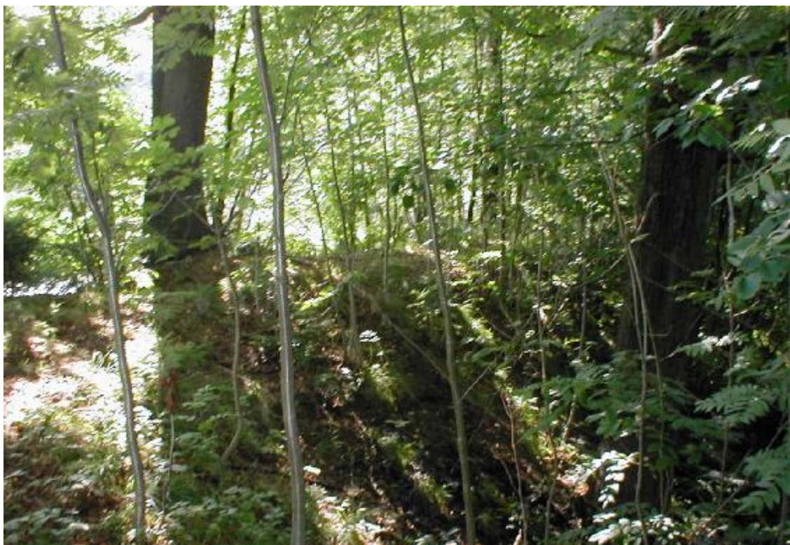
Obr. 1 – Pohled na hráz, neudržovaný porost
