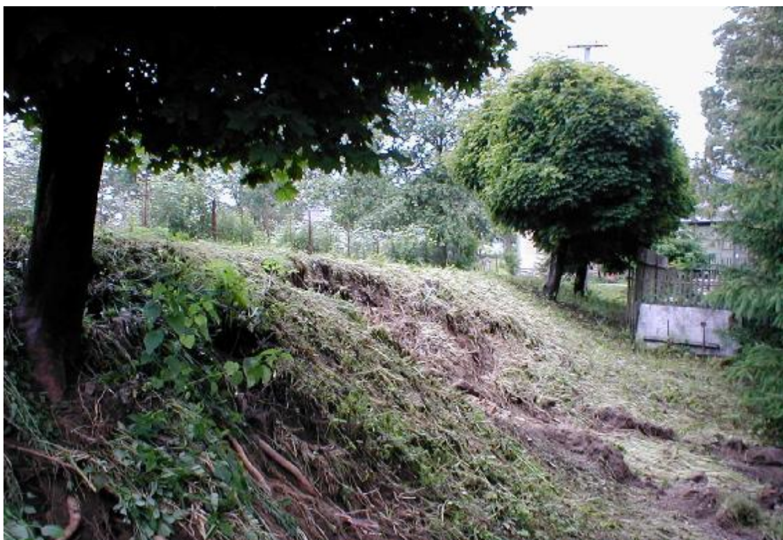
Obr. 4 – Poškozený vzdušný svah hráze
