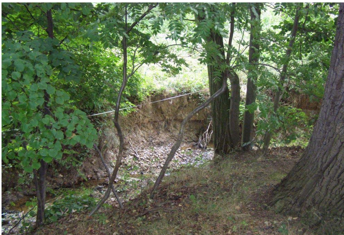
Obr. 4 – Poškození odpadního koryta od bezpečnostního přelivu
