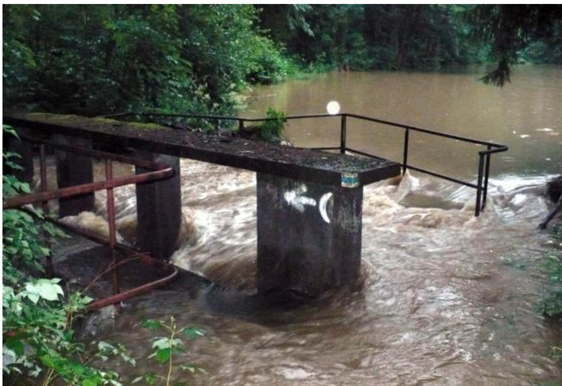
Obr. 3 – Zahlcený hrazený bezpečnostní přeliv s předsazenou česlovou stěnou v levém zavázání hráze během povodně
