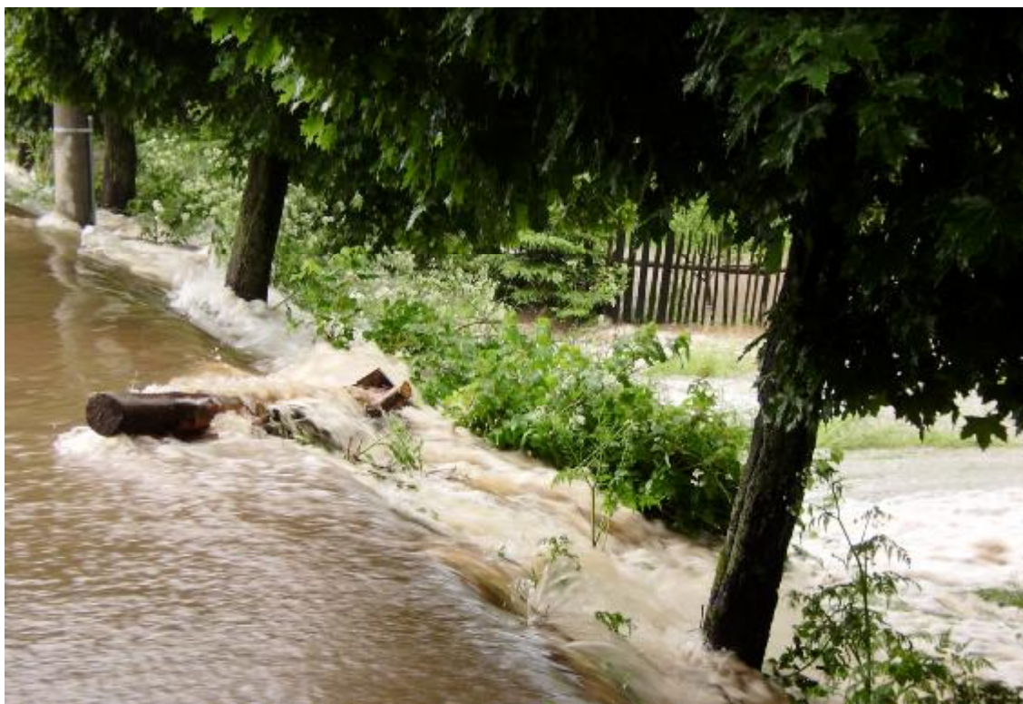
Obr. 2 – Přelévání v nejnižším místě hráze
