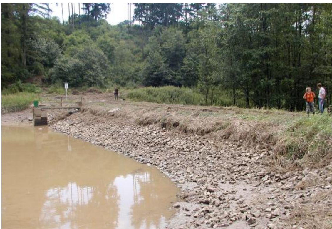
Obr. 2 – Návodní část hráze po přelítí při povodni zůstala neporušena
