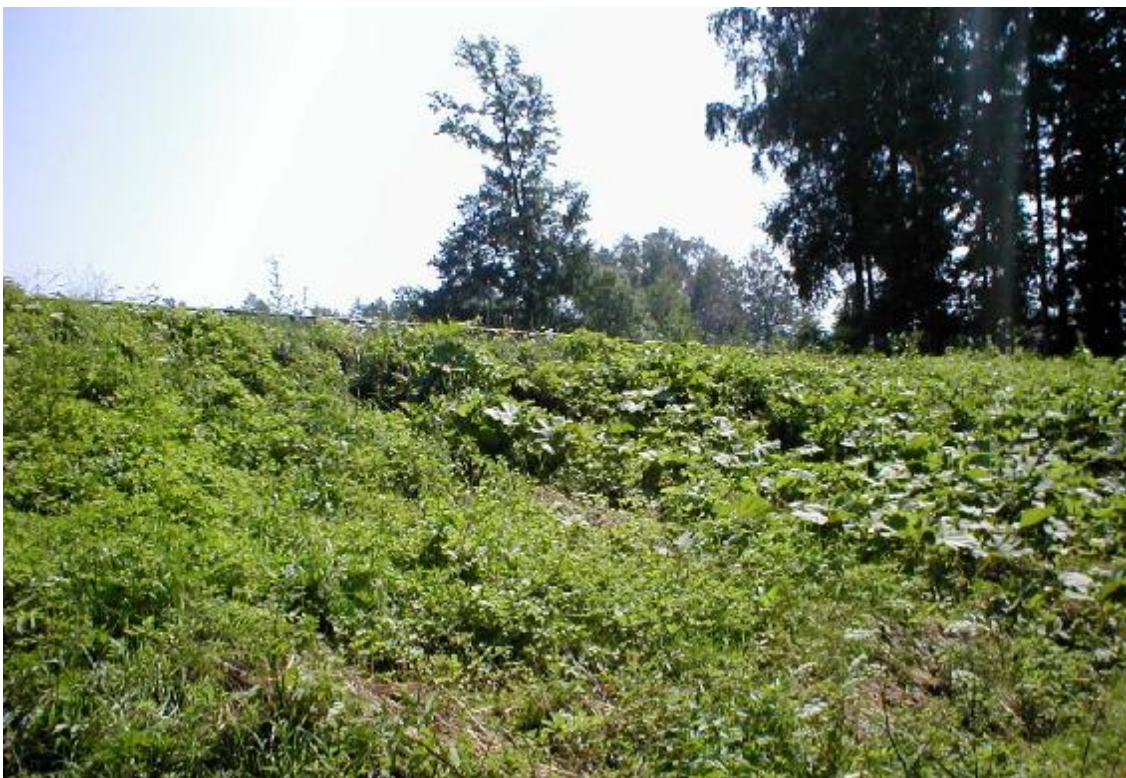
Obr. 2 – Sesuv na vzdušní straně hráze
