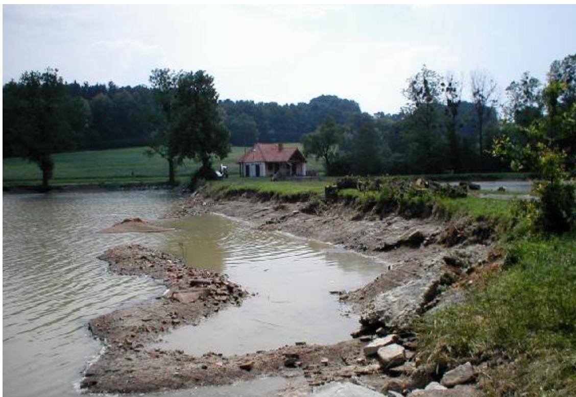
Obr. 3 – Poškozené opevnění dělicí hráze
