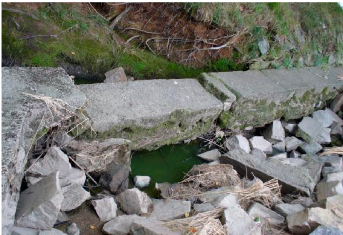
Obr. 3 – Poškozený zavazovací betonový práh skluzu od bezpečnostního přelivu
