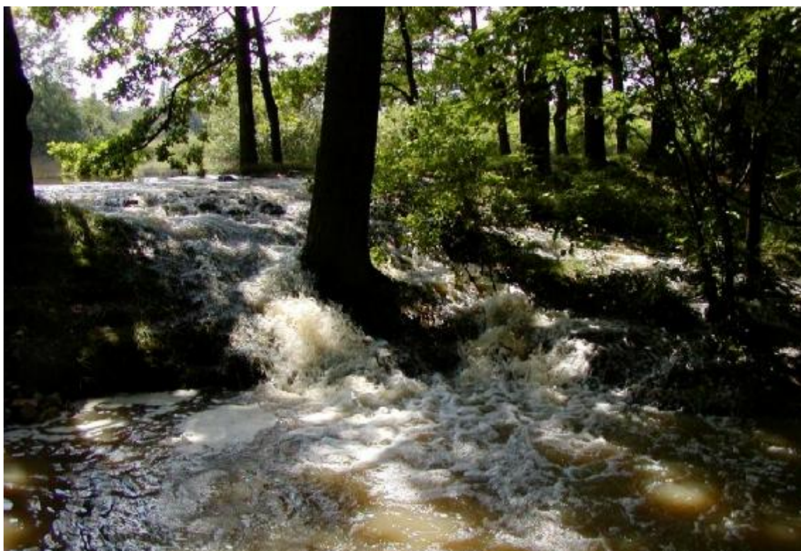
Obr. 2 – Vzdušný svah hráze nad podtrubní jámou při povodni
