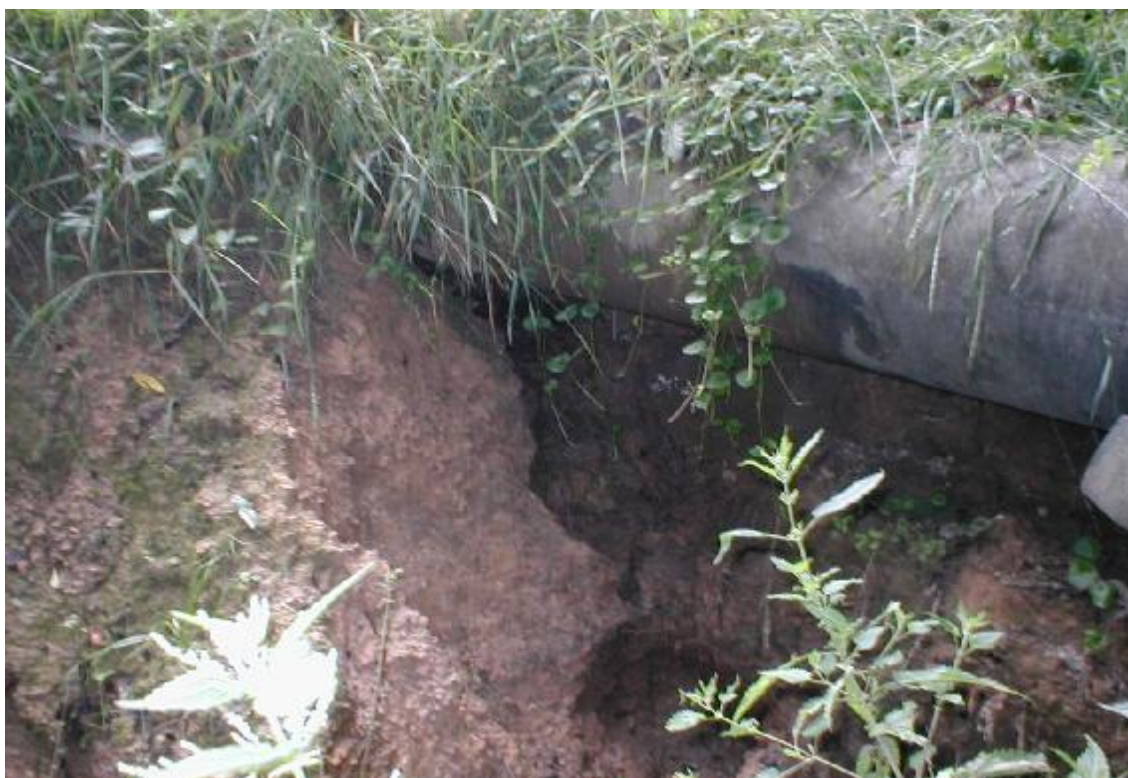
Obr. 4 – Přelitím poškozený vzdušný svah pod potrubím bezpečnostního přelivu
