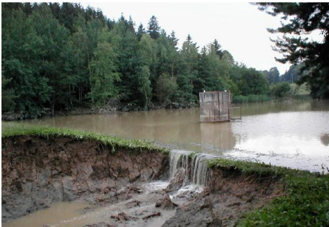
Obr. 1 – Protržená hráz před otevřením spodní výpusti
