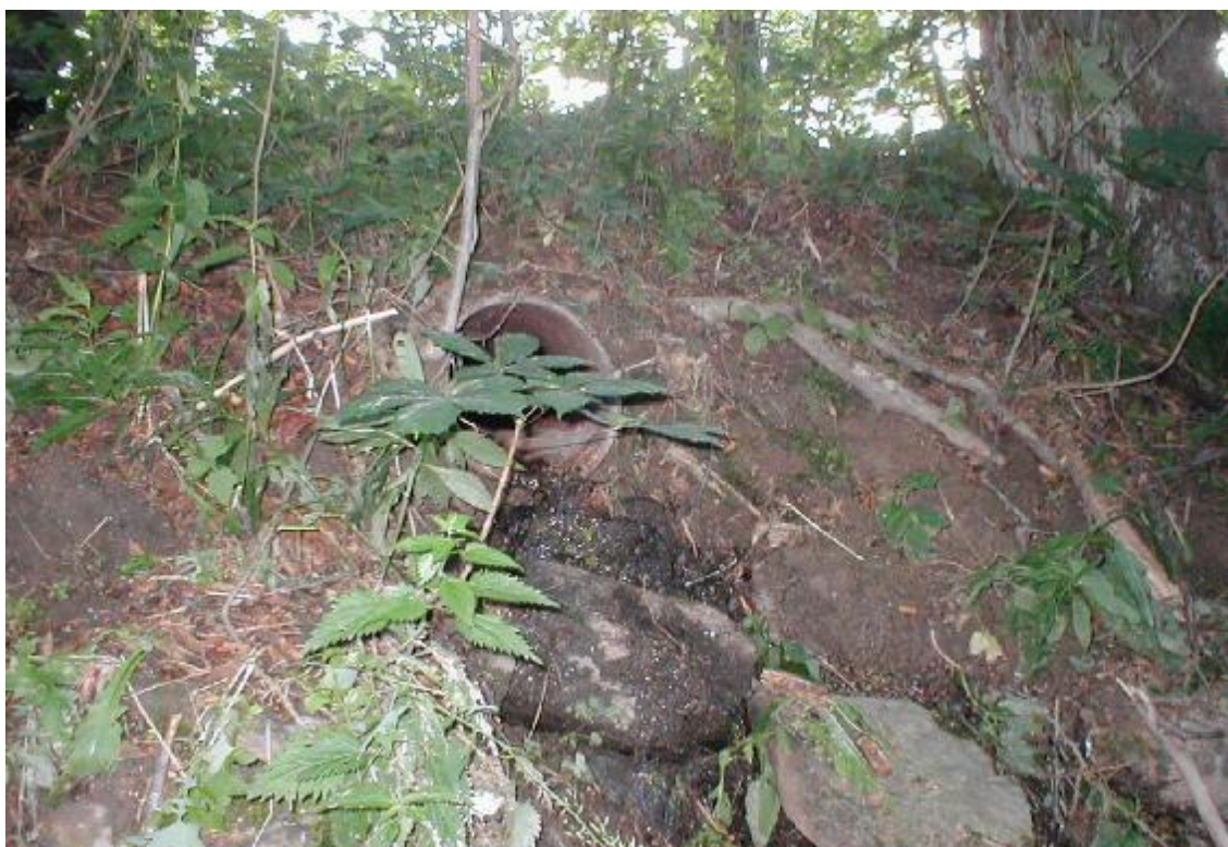
Obr. 2 – Výtok na vzdušný svah špatně upraveným
