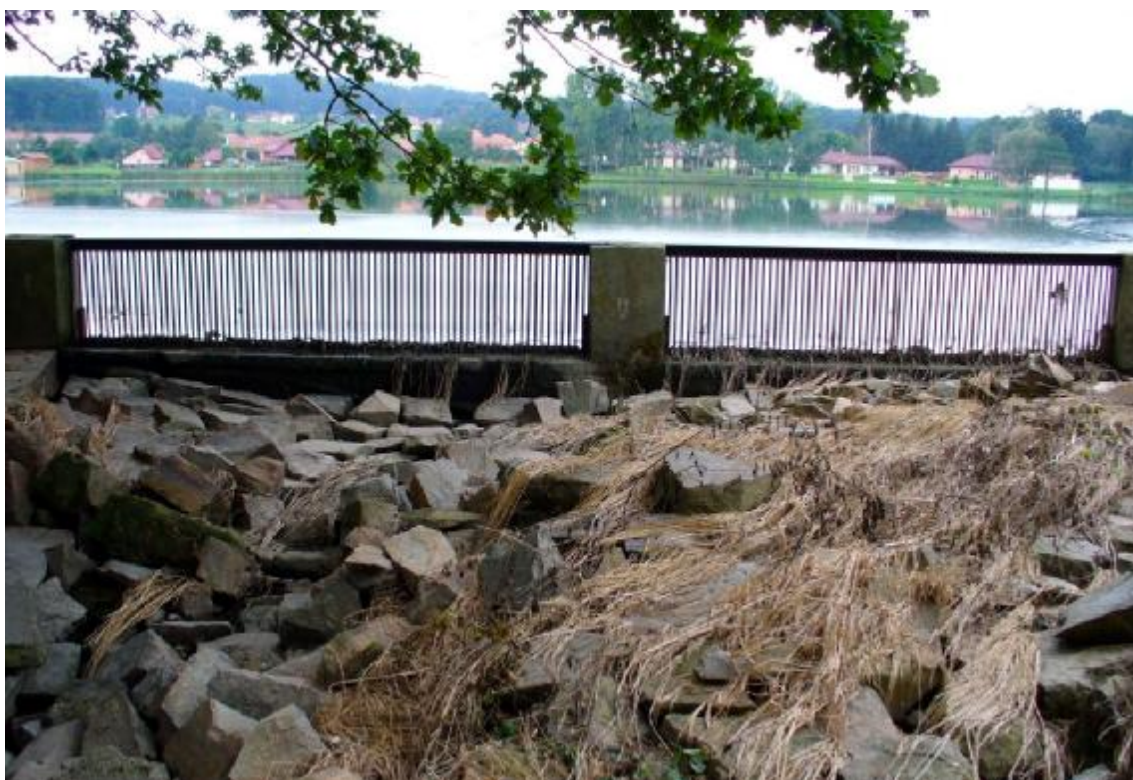
Obr. 1 – Pohled na poškozený skluz od bezpečnostního přelivu proti vodě
