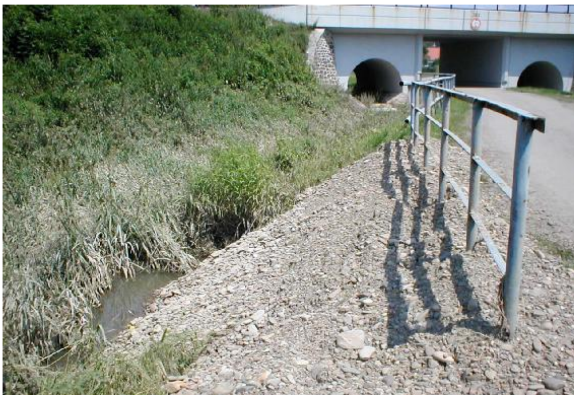
Obr. 4 – Zasypaný přítok z odvodňovacího kanálu do rybníka
