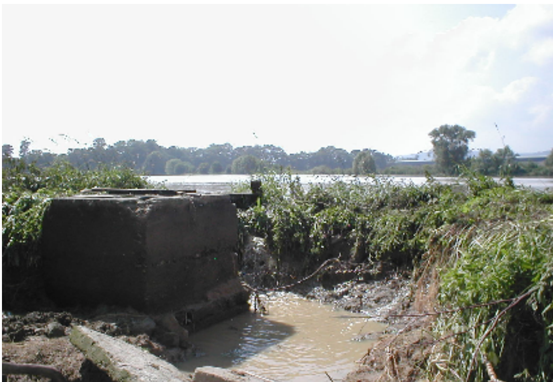
Obr. 1 – Porušená hráz u spodní výpusti
