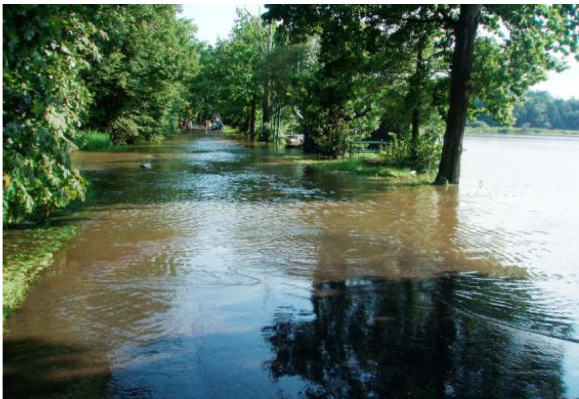
Obr. 1 – Přelévání hráze v profilu spodní výpusti, pohled od levého konce hráze
