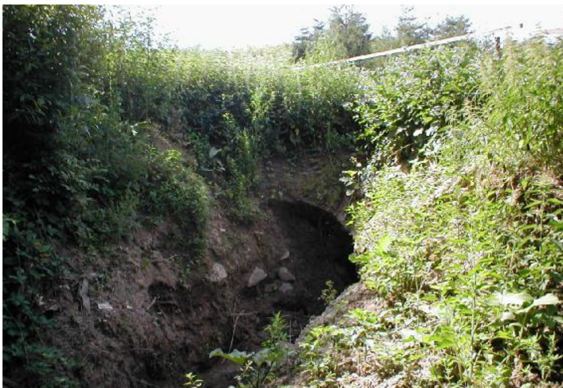
Obr. 2 – Nátrž nad spodní výpustí
