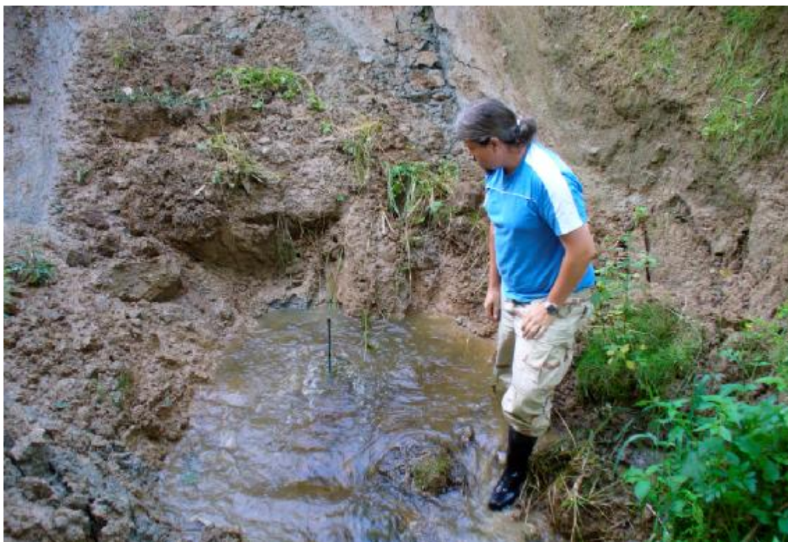
Obr. 1 – Průzkum poruchy v profilu spodní výpusti – sledování rozsahu poruchy
