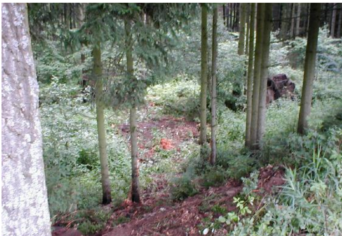
Obr. 4 – Vzdušný svah hráze, poškozen taháním kmenů
