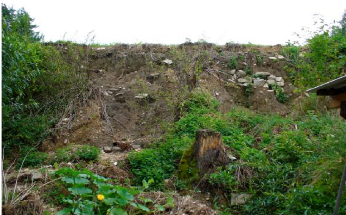
Obr. 2 - Pohled na střední část hráze po povodni
