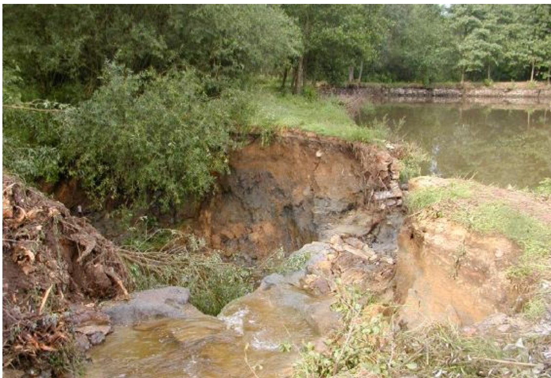
Obr. 2 – Poškozené koryto potoka protékajícího podél hráze a průrva v hrázi
