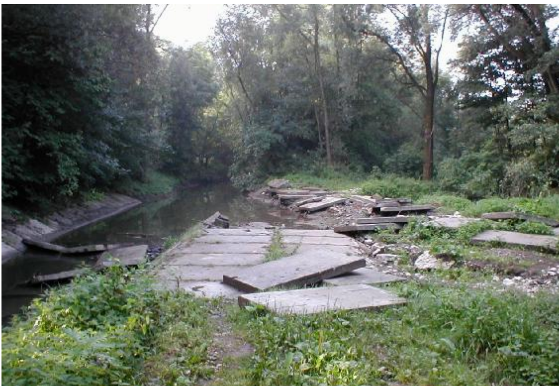
Obr. 3 – Devastované opevnění na nálevku do nádrže – rozdělovací objekt
