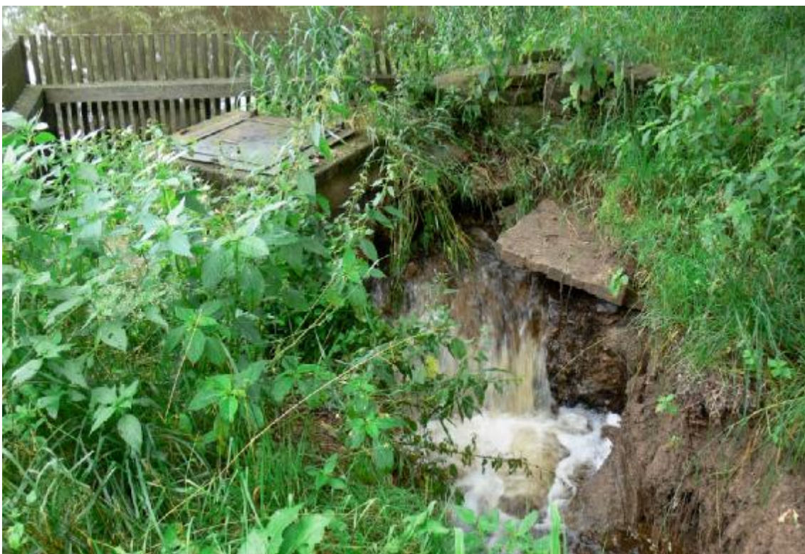
Obr. 1 – Pohled na porušenou hráz za požerákem a převádění vody poruchou v hrázi
