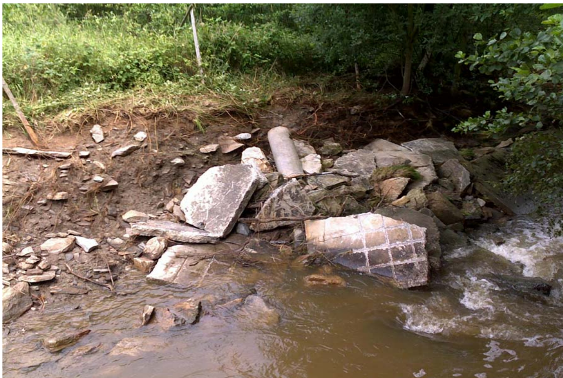
Obr. 3 – Porušená levá patní drenáž vyvedená do odpadního koryta
