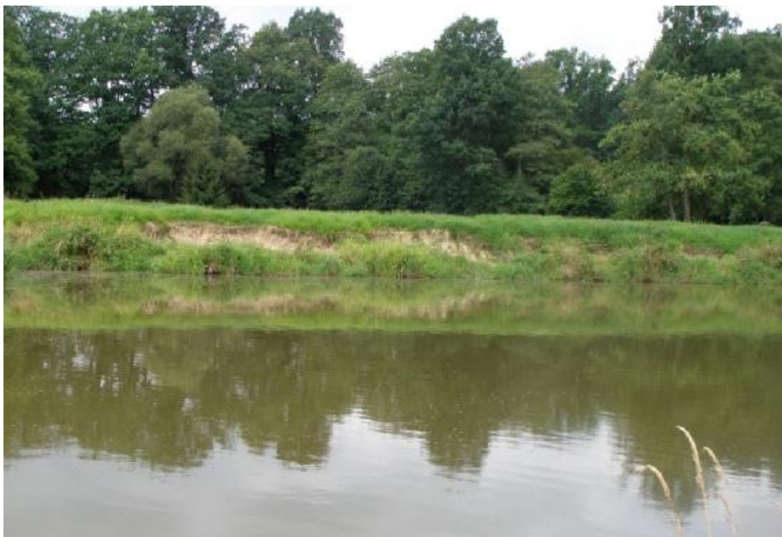
Obr. 1 – Poškození vzdušního svahu pravé části hráze
