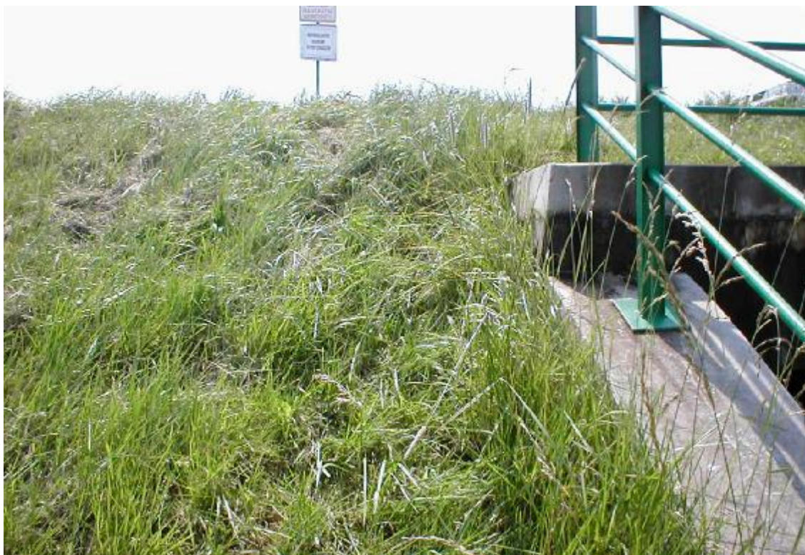
Obr. 3 – Pod korunou výsak – voda ze svahu
