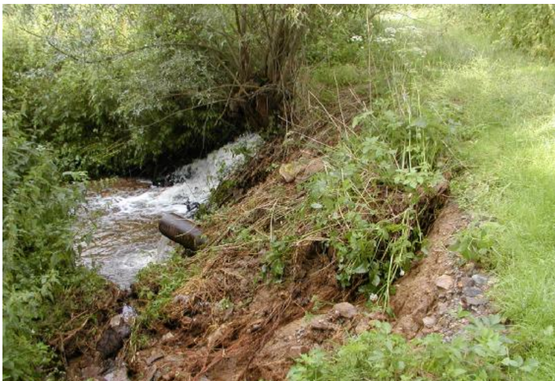
Obr. 4 – Poškození vzdušního svahu hráze u výpusti způsobené přelitím hráze
