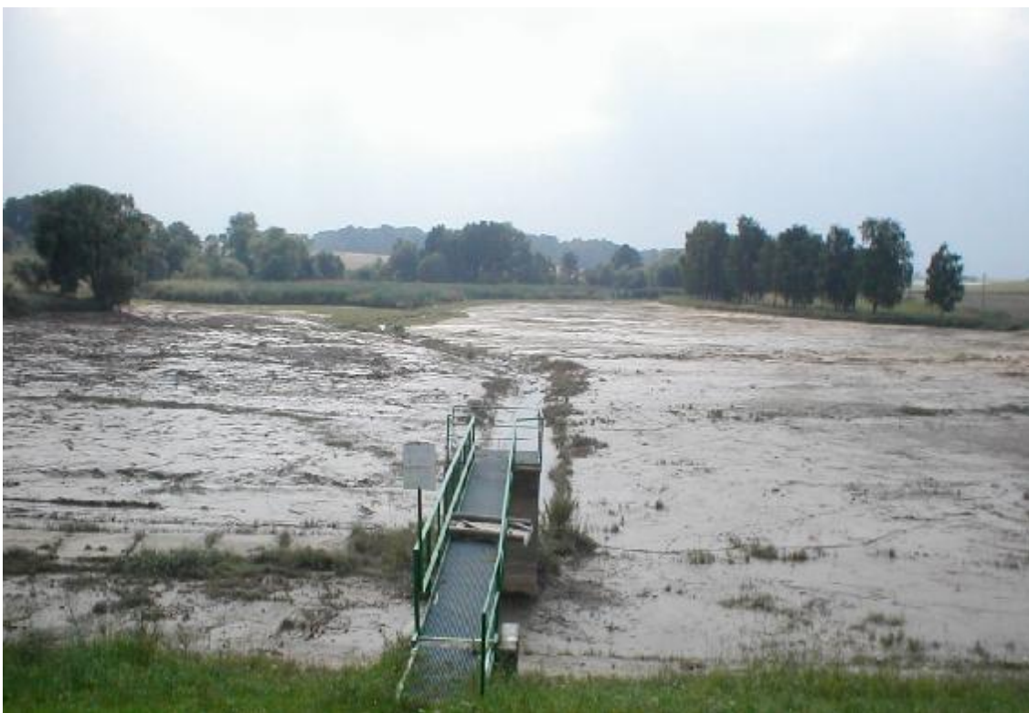
Obr. 1 – Zátopa a výpustný objekt po průsaku povodně
