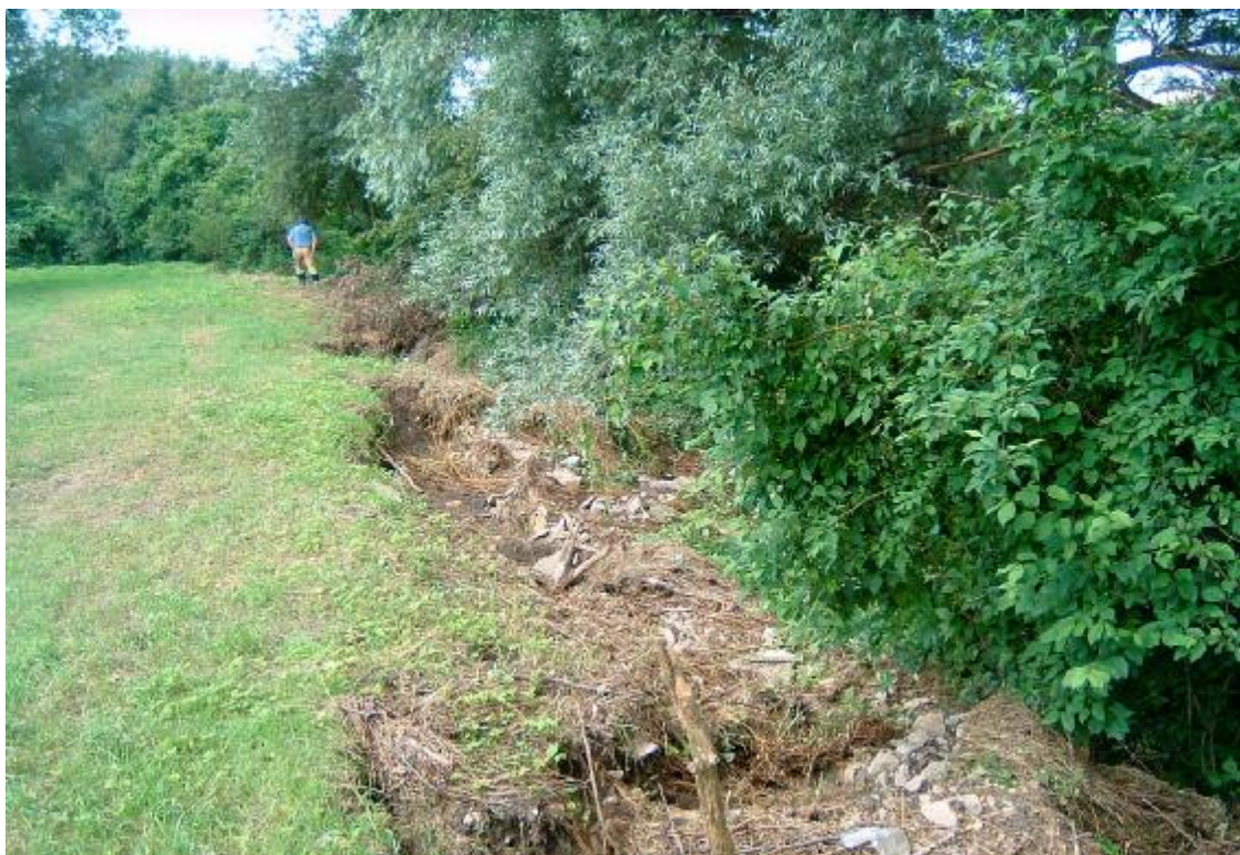
Obr. 1 – Nátrže na vzdušném svahu hráze
