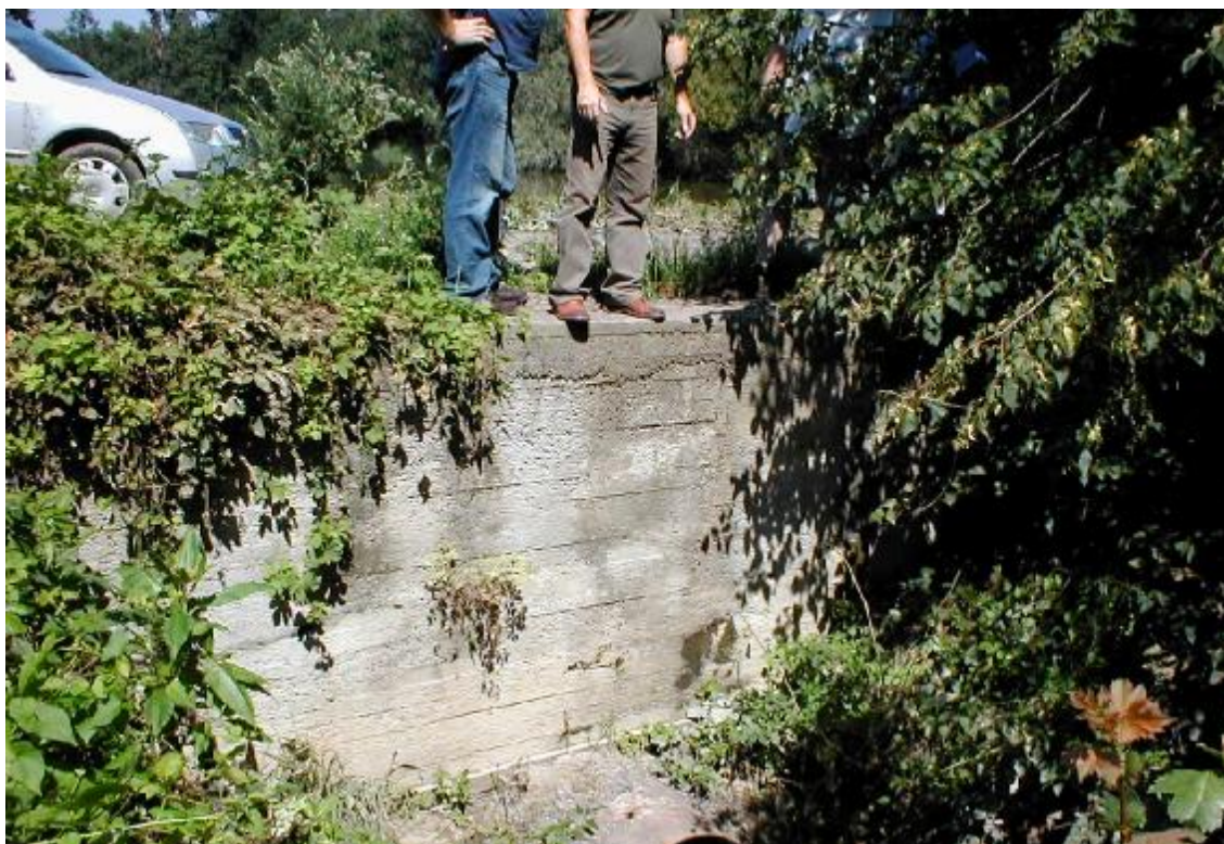
Obr. 3 – Spodní výpust- průsak kolem potrubí
