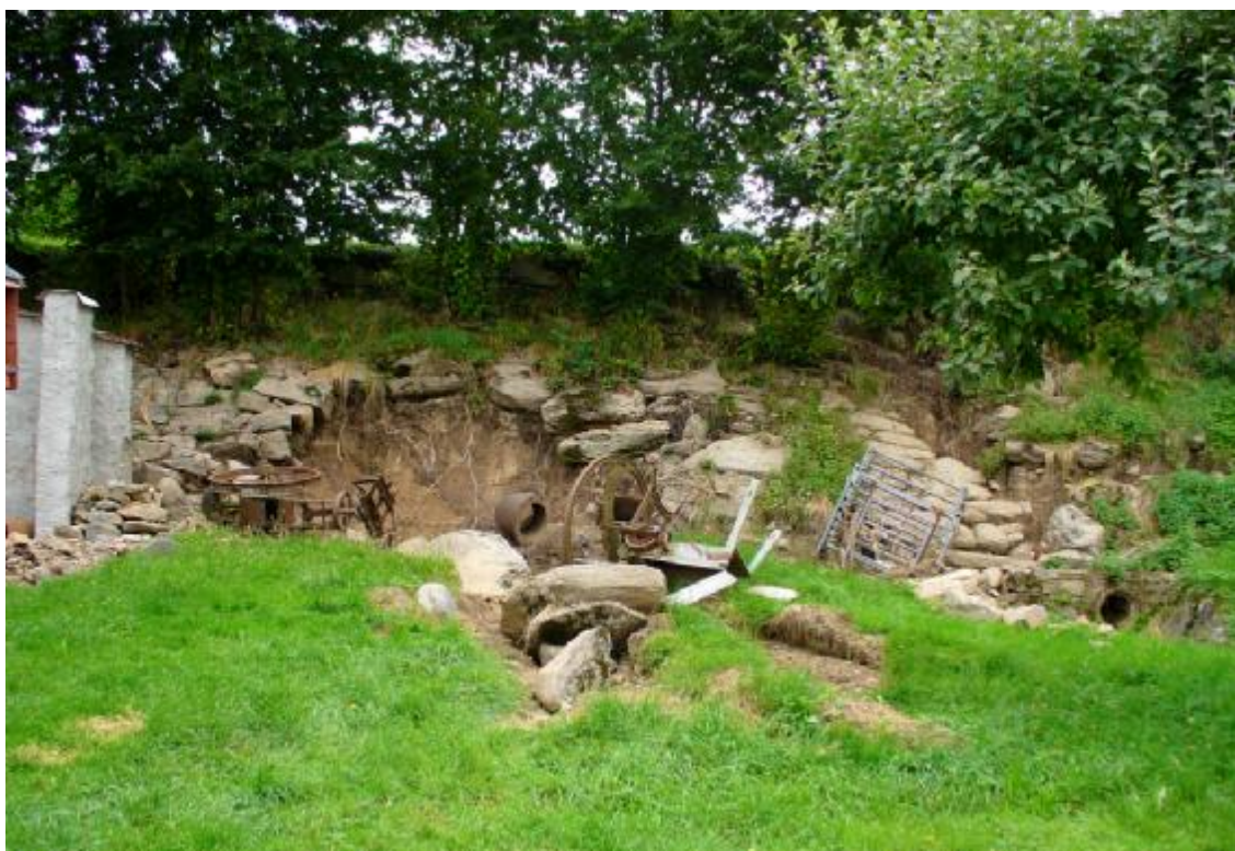
Obr. 4 - Pohled na hráz v profilu spodní výpusti proti vodě po povodni
