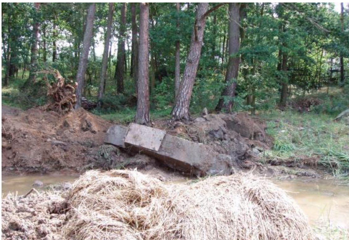
Obr. 3 – Pohled z hráze na bezpečnostní přeliv bezprostředně po povodni
