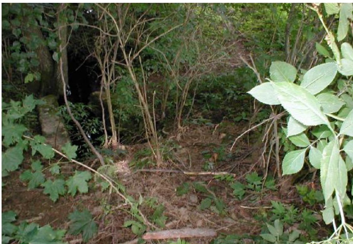
Obr. 2 – Výmol na vzdušném svahu
