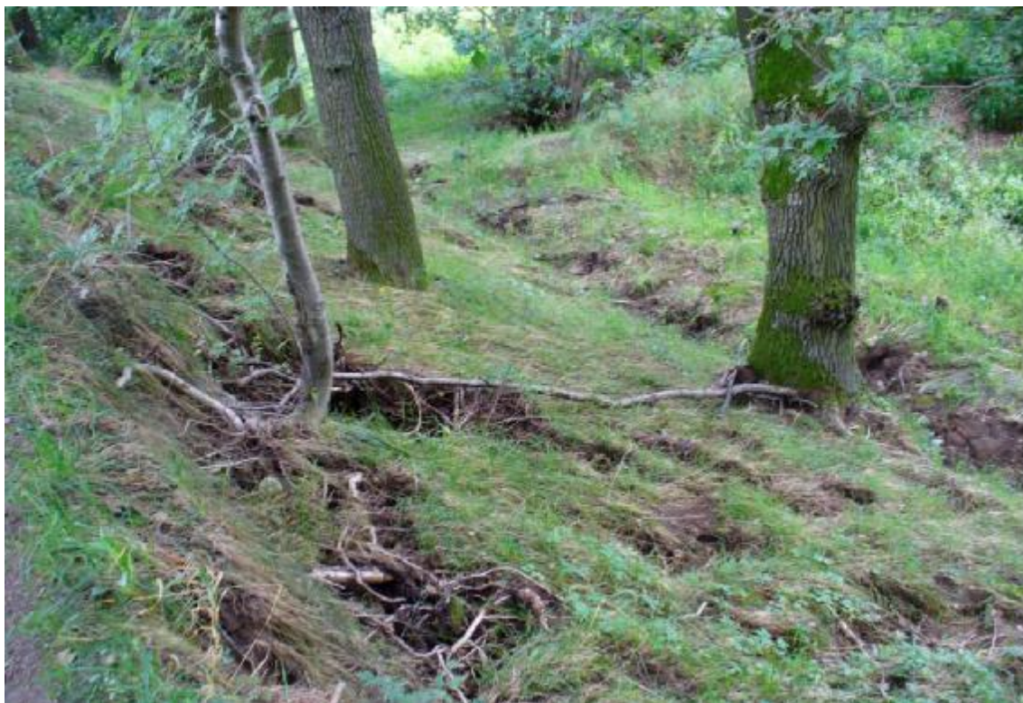
Obr. 2 – Poškození vzdušního svahu v pravé části hráze
