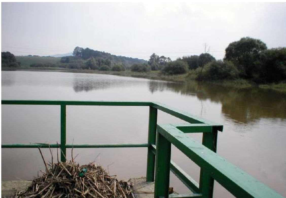
Obr. 3 – Naplaveniny na rožku spodní výpusti
