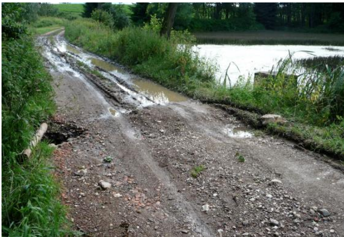
Obr. 3 – Pohled na korunu hráze a místo přelítí (popř. průsakové eroze) v profilu spodní výpusti po povodni
