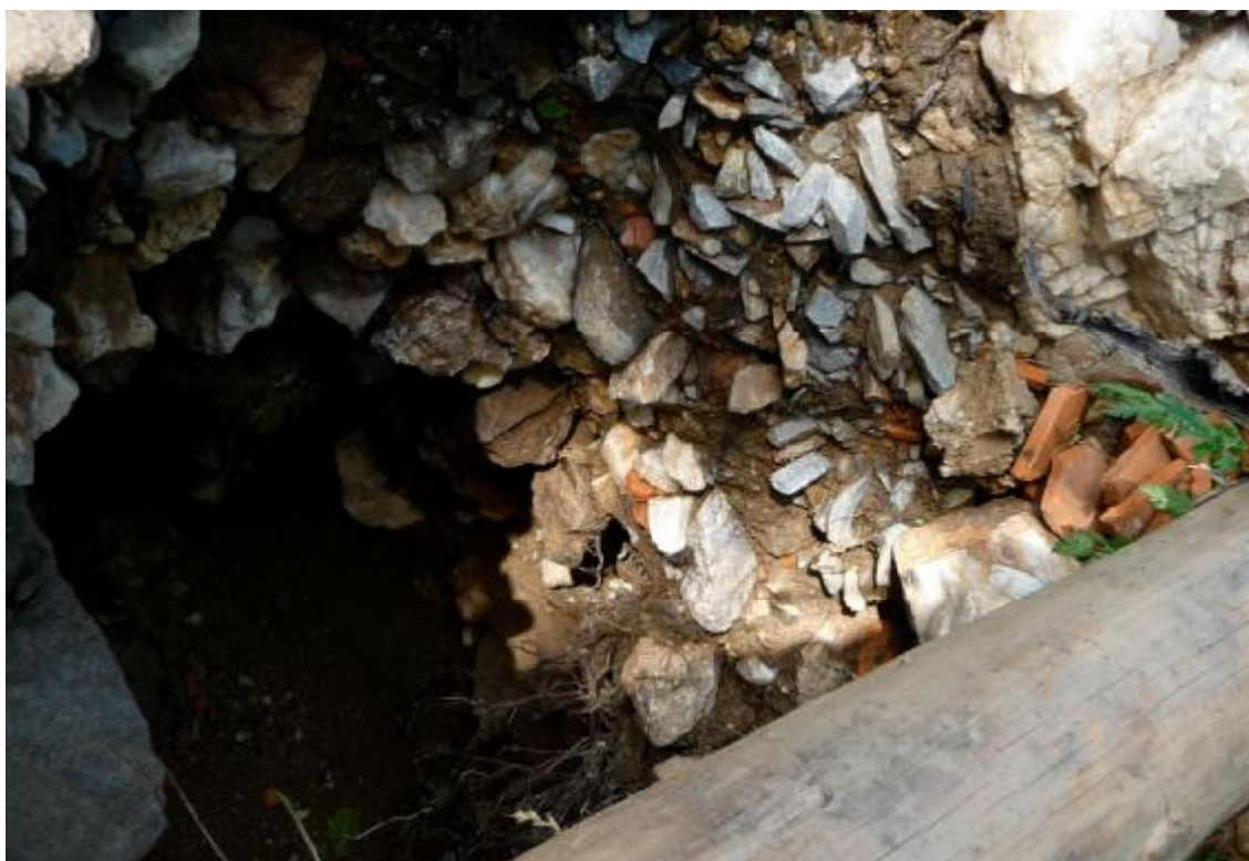
Obr. 4 – Pohled do porušeného místa hráze – charakter materiálu hráze
