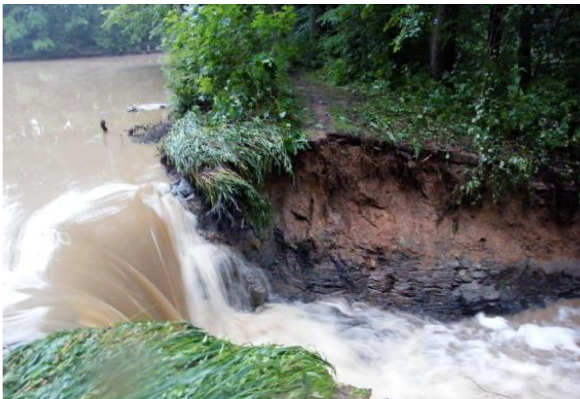
Obr. 1 – Přelévání hráze v místě průrvy (bývalý nouzový přeliv v pravém zavázání hráze)
