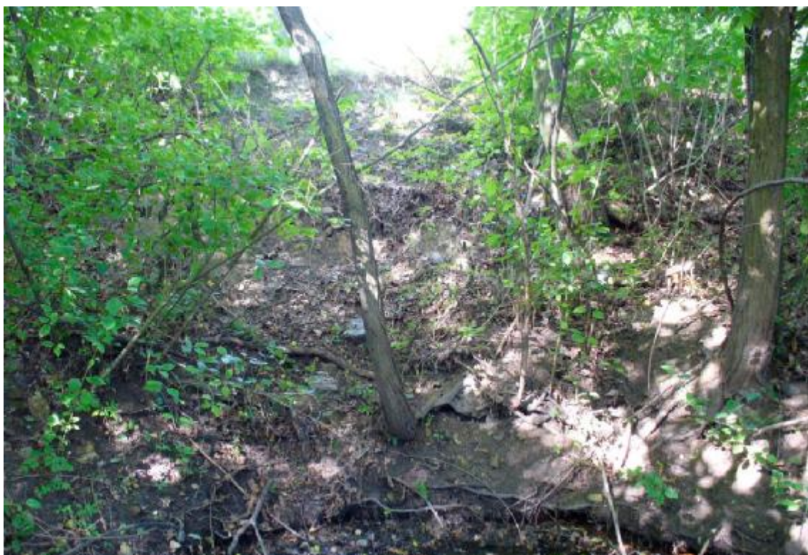
Obr. 2 – Poškozený vzdušný svah nad podtrubní jámou spodní výpusti
