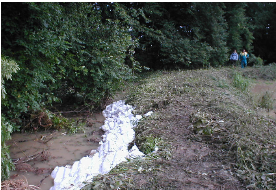
Obr. 4 – Zajištění výronů z hráze pytli s pískem
