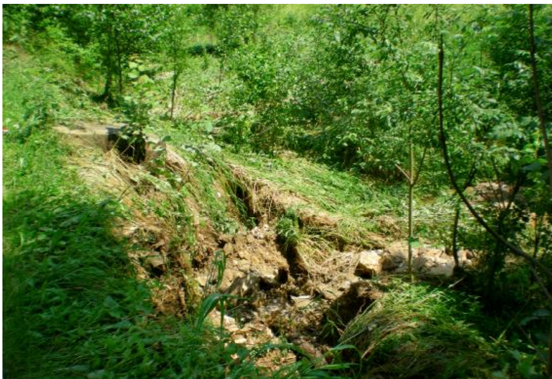
Obr. 1 – Nátrž (kaverna) na vzdušném svahu v profilu spodní výpusti
