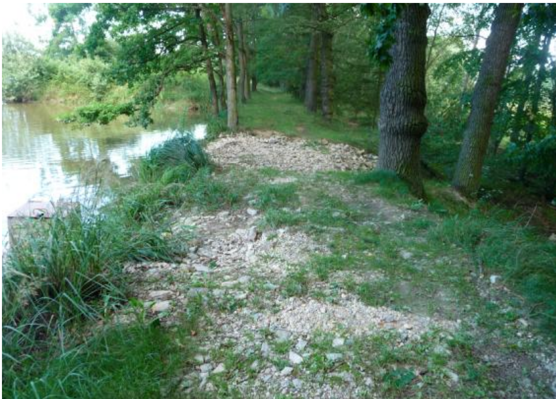
Obr. 3 – Pohled na místo přelití koruny hráze v prostoru spodní výpusti po sanaci poškozených míst kamenitým materiálem
