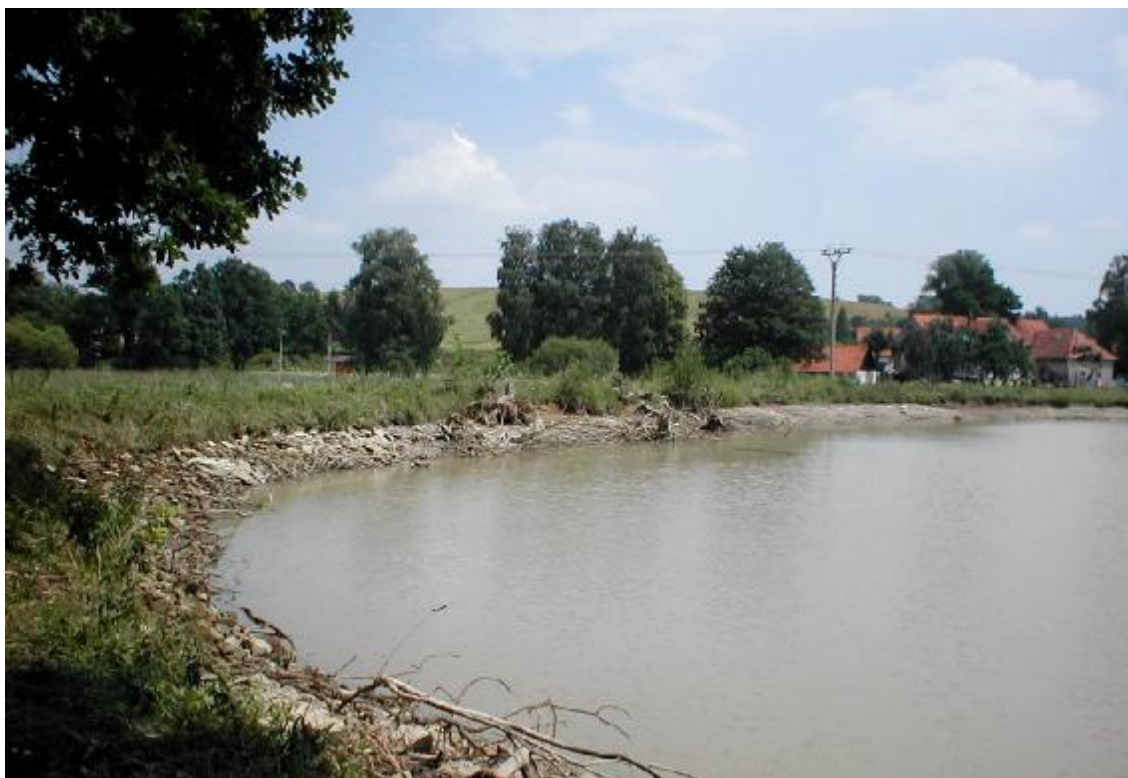
Obr. 3 – Poškozené opevnění hráze
