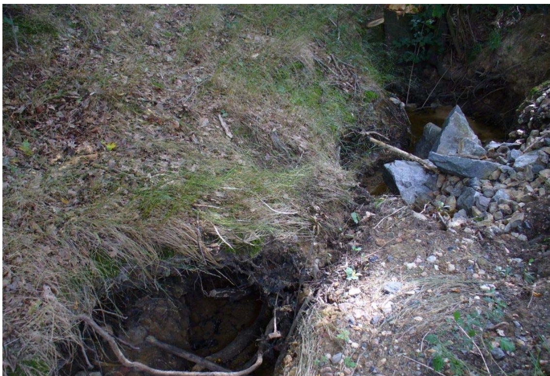
Obr. 2 - Poškození přelivné hrany bezpečnostního přelivu a odpadního koryta
