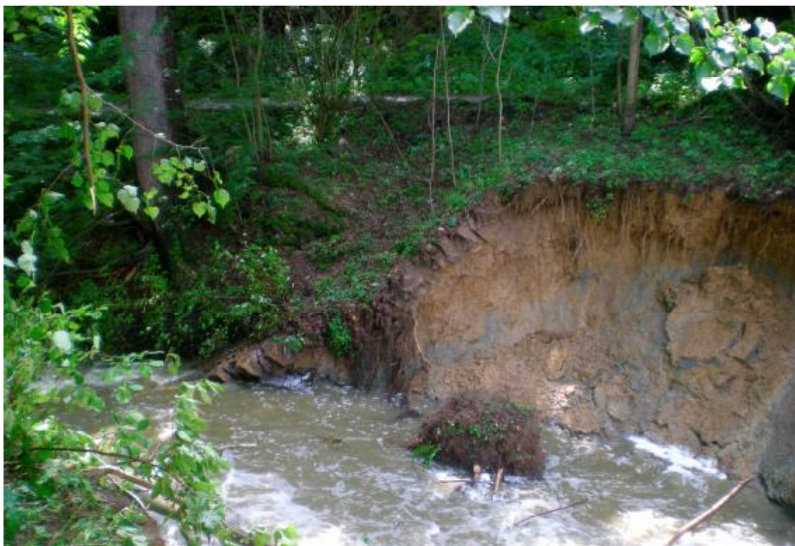
Obr. 5 – Pohled z levé strany na vyvíjející se průrvu v místě bývalého nouzového přelivu
