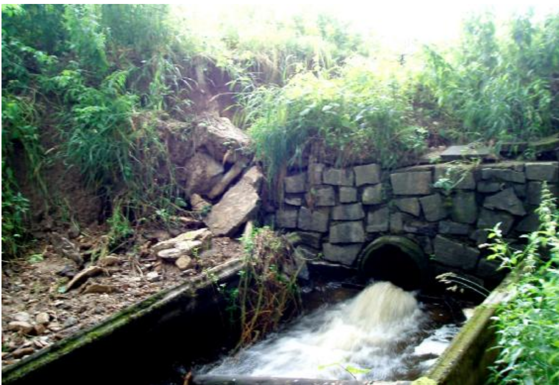
Obr. 2 – V den prohlídky byla voda převáděna odpadním potrubím spodní výpusti, po povodni poškozená zpevněná podtrubní jáma a nátrž na vzdušném svahu
