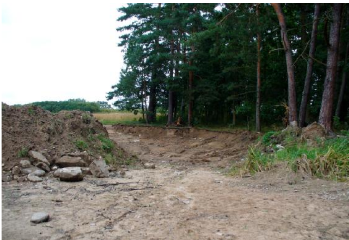
Obr. 4 - Pohled z nádrže na bezpečnostní přeliv po povodni
