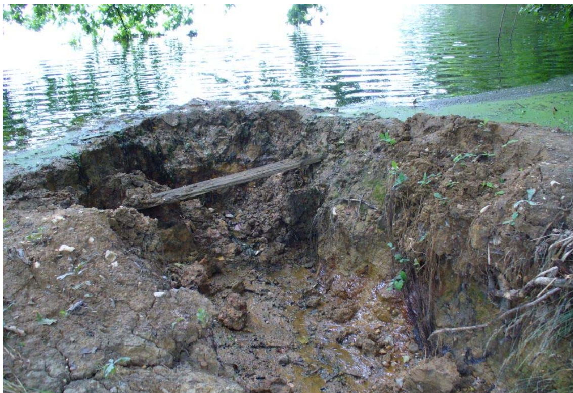
Obr. 1 – Poškození přelivné hrany bezpečnostního přelivu
