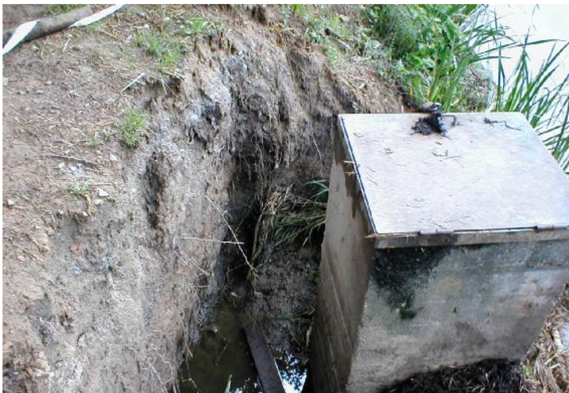
Obr. 1 – Odplavený materiál hráze při poruše potrubí
