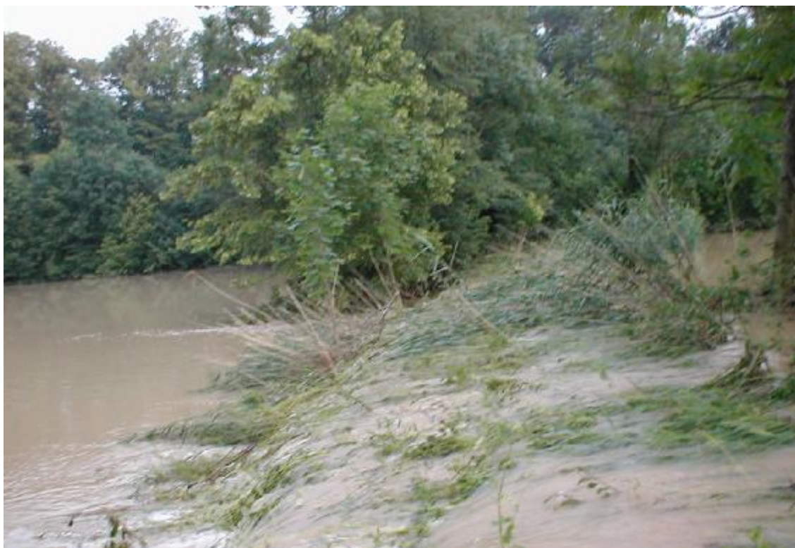
Obr. 1 – Přelévaná hráz při povodni po kulminaci v Luze
