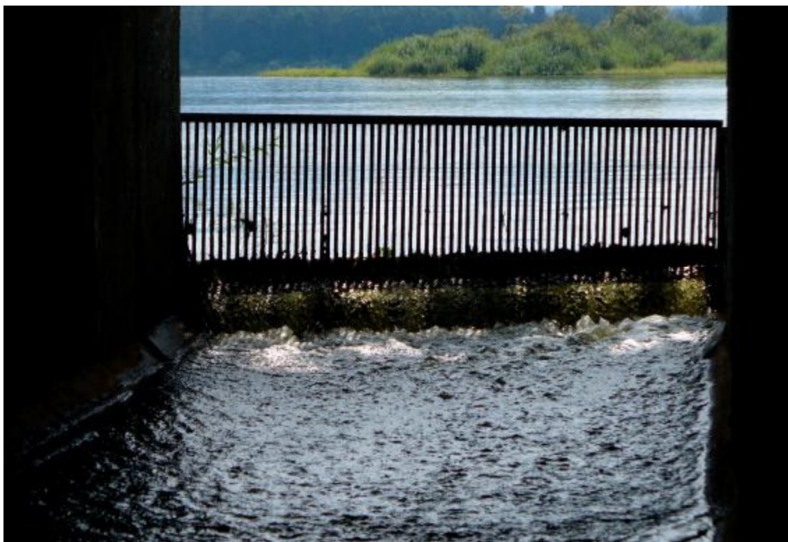
Obr. 1 – Pohled na převádění vody přelivem se zvýšenou přelivnou hranou o 0,15 m, oproti stavu při povodni osazena česlová stěna
