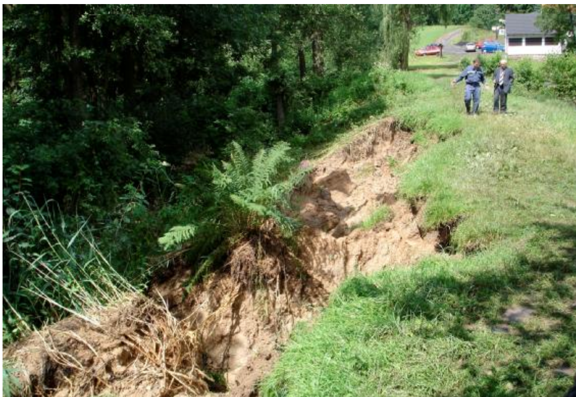
Obr. 1 – Poškozený vzdušný svah tělesa hráze po přelití koruny
