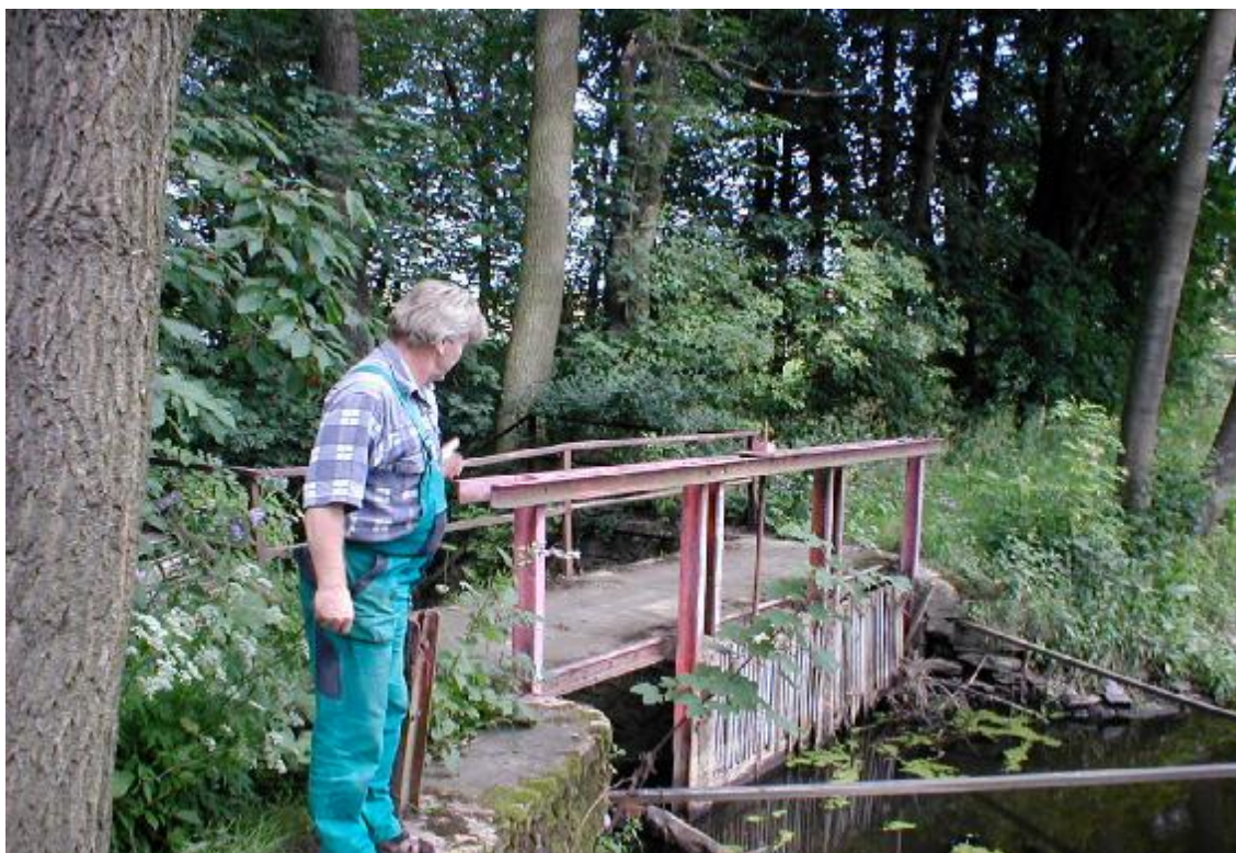
Obr. 3 – Bezpečnostní přeliv s nevhodným brlením
