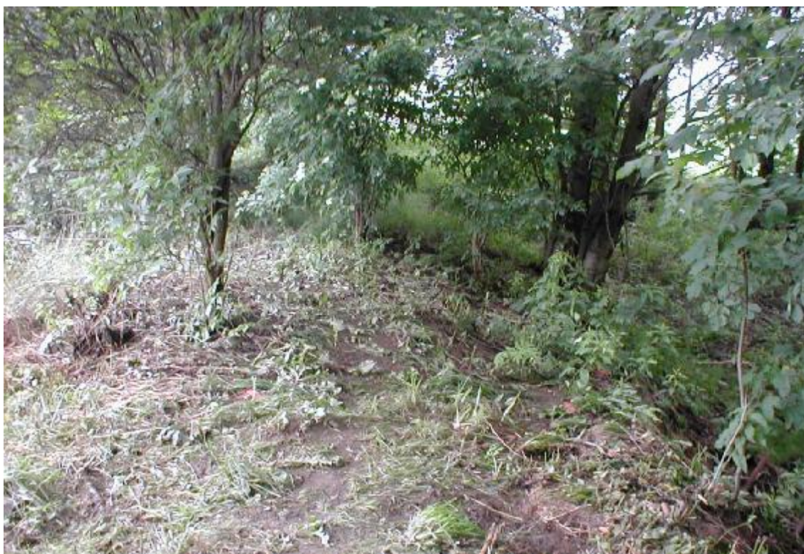
Obr. 2 – Přeléváná koruna hráze a vzdušní svah
