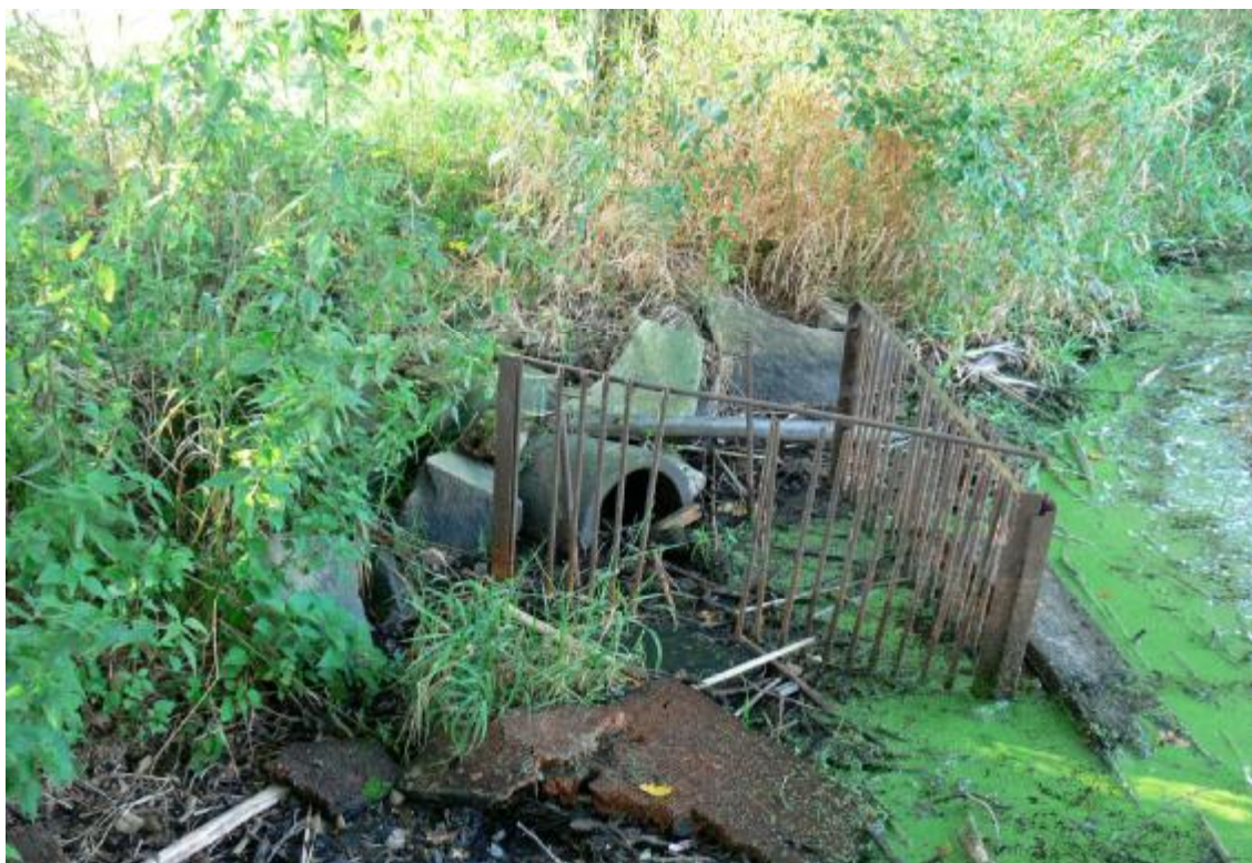
Obr. 3 – Zanesený trubní bezpečnostní přeliv u levého konce hráze s předsazenými česlemi
