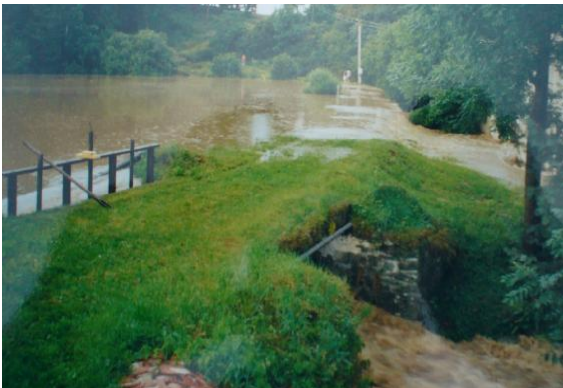
Obr. 1 – Pohled na bezpečnostní přeliv a korunu hráze při povodni
