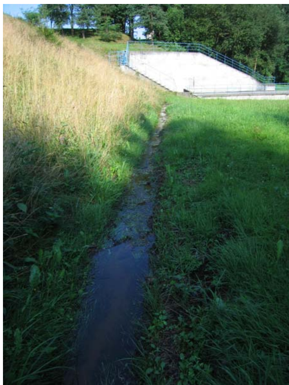
Obr. 2 – Zaplněný drenážní příkop povrchovou srážkovou vodou v důsledku ucpaného propustku pod komunikací od pravého závázání hráze
