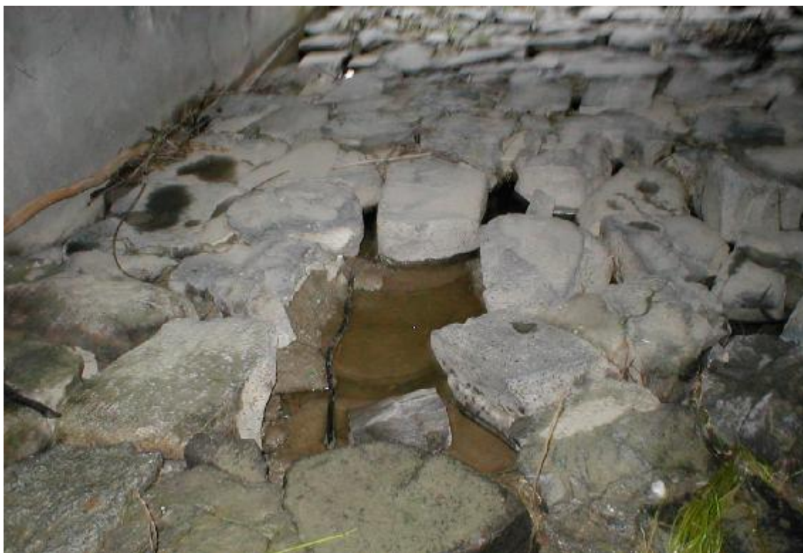
Obr. 3 – Poškozené opevnění skluzu
