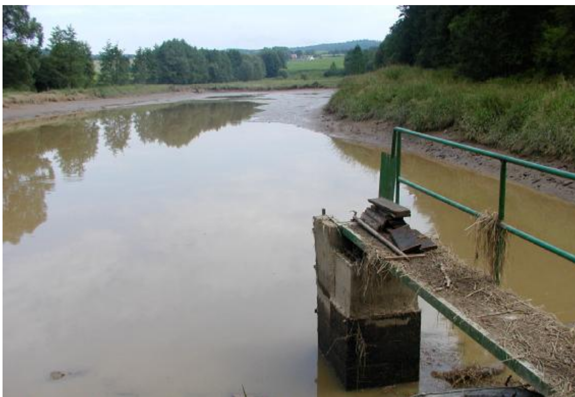
Obr. 3 – Vypuštěný rybník v Bohunicích po povodni
