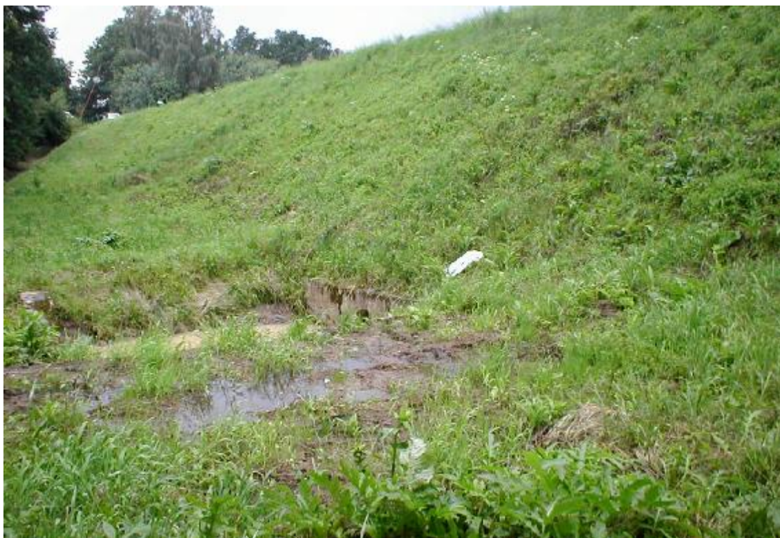
Obr. 3 – Silné zamokření paty hráze
