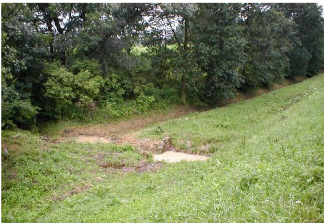
Obr. 4 – Vyústění spodní výpusti – silně zamokřené okolí v patě
