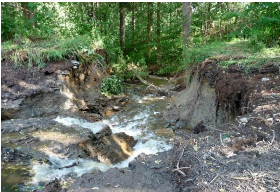
Obr. 2 – Pohled na vzniklou průrvu ve směru toku (místy je vidět rostlá skála – základ)
