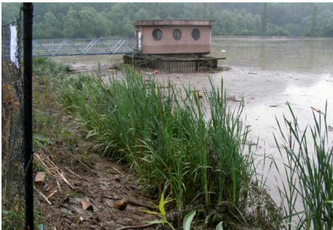
Obr. 1 – Sdružený objekt a zanesené česle
