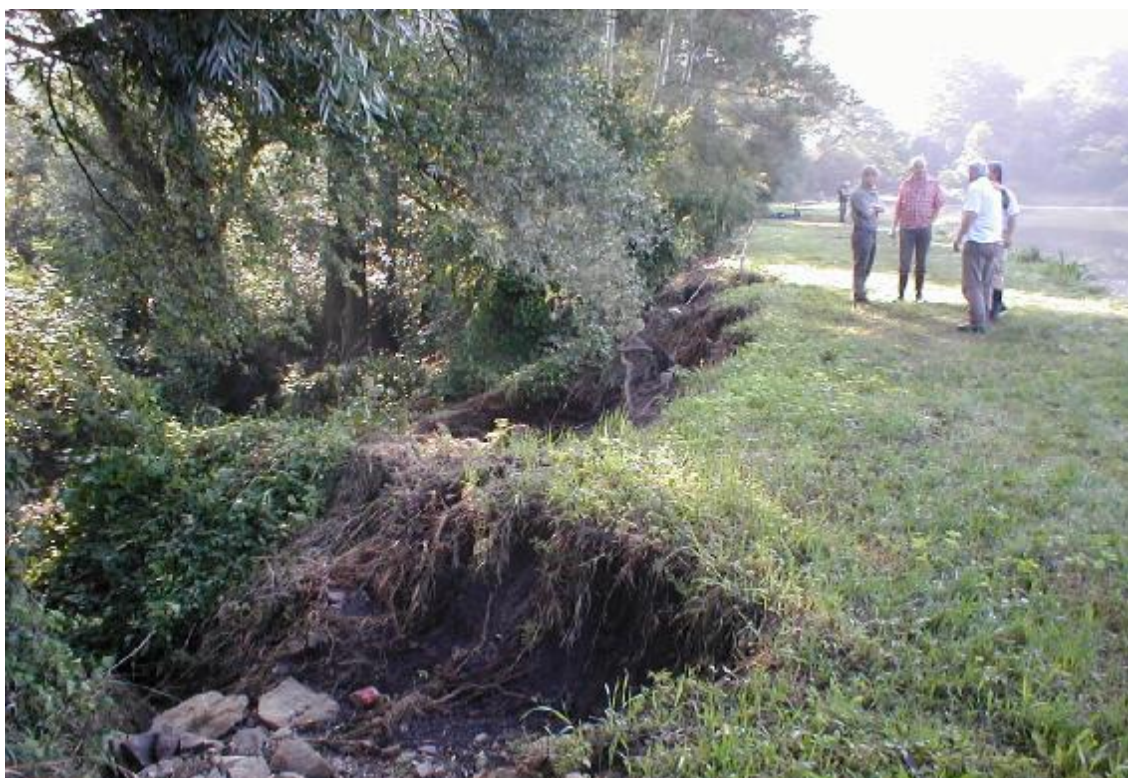
Obr. 2 – Nátrže na vzdušném svahu hráze
