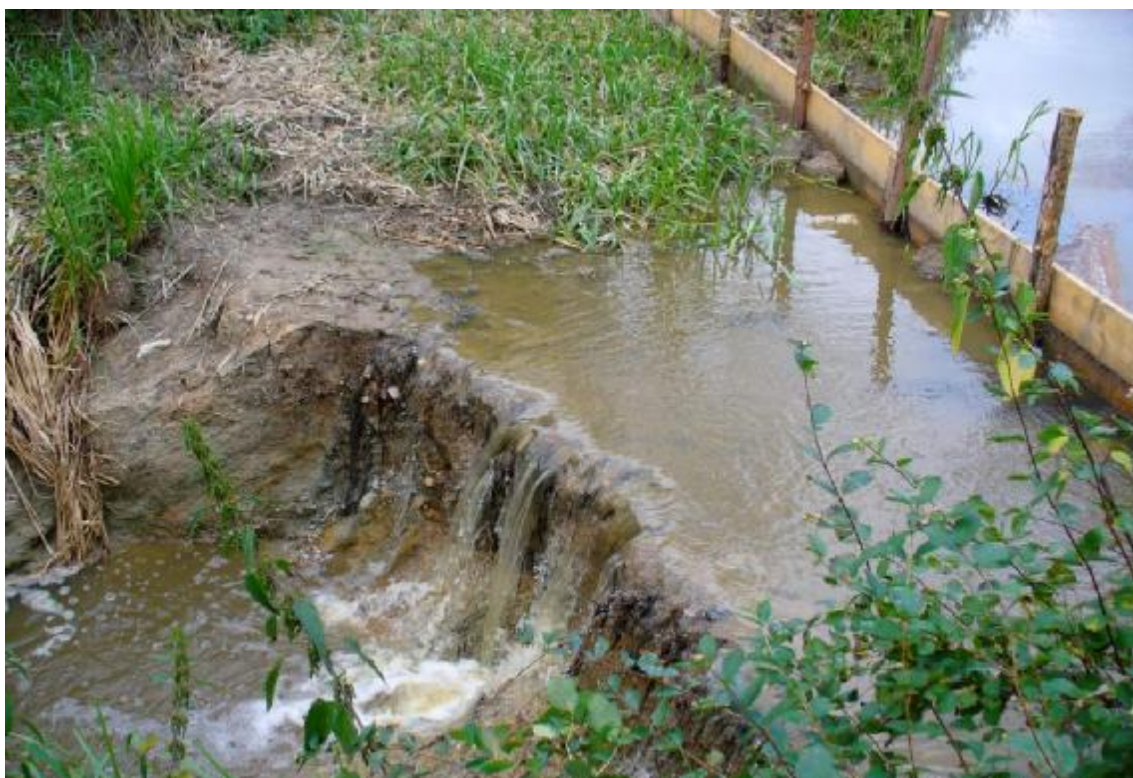
Obr. 2 – Poškozený bezpečnostní přeliv
