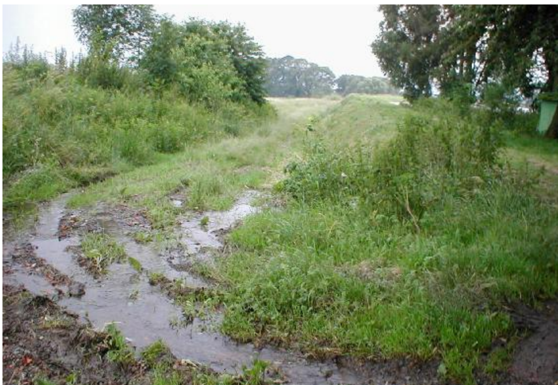
Obr. 4 – Přítok vody pod hráz z levého zavázání
