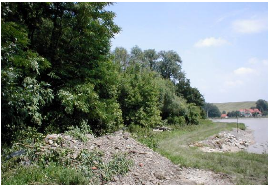
Obr. 4 – Poškozené opevnění v závázaní hráze
