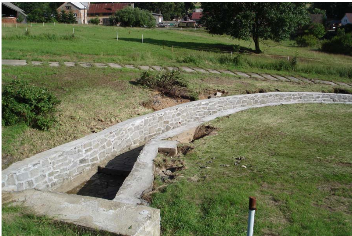
Obr. 1 – Skluz od bezpečnostního přelivu, po obou stranách kaverny a výmoly od proudící vody při povodni
