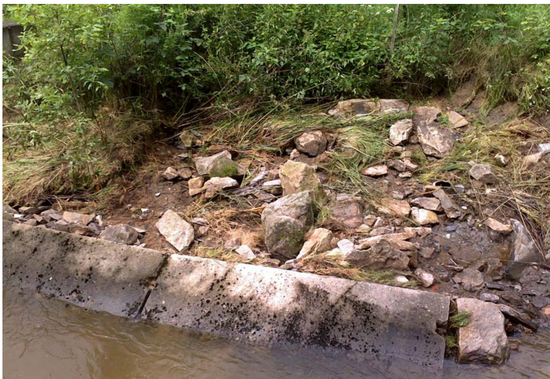
Obr. 2 - Porušené opevnění odpadního koryta od sdruženého funkčního objektu
