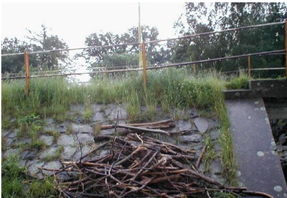
Obr. 2 – Naplavený materiál – úroveň dosahu hladiny vody při povodni
