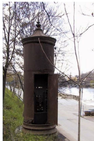
Obr. 8 Starý transformátor na Smíchově z r. 1900. Foto: Katalog NPÚ, 2023.
