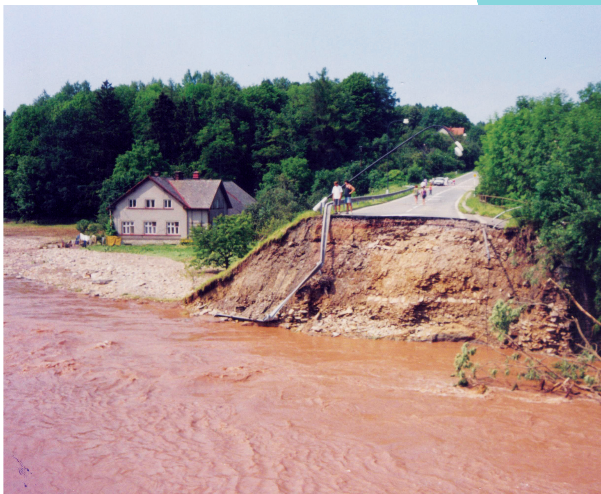
Stržený silniční most na Dědině v Cháborech.
