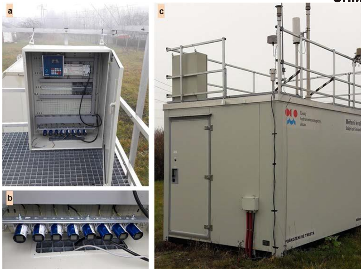
Obr. č. 2. Párové sady Cairclip senzorů na SO 2 , NO 2 , O 3 /NO 2 a CO (b) instalované v průvzdušném boxu (a) na střeše referenční monitorovací stanice na Observatoři v Tušimicích (c). Foto: P. Bauerová
